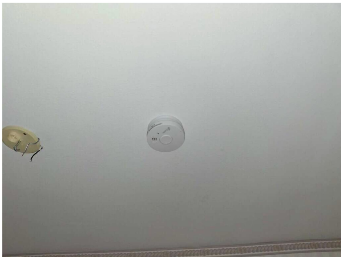
Kuva 1 Huoneistossa on palovaroitin.
