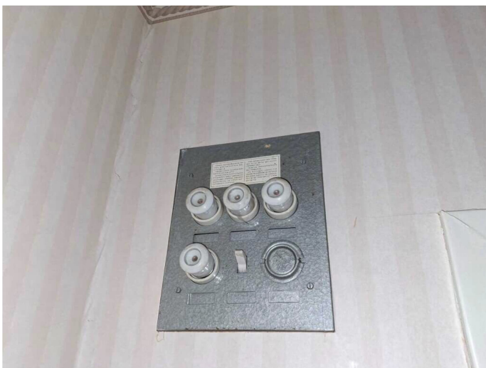
Kuva 6 Pääsulaketaulu sekä sähköjärjestelmä on alkuperäinen.
