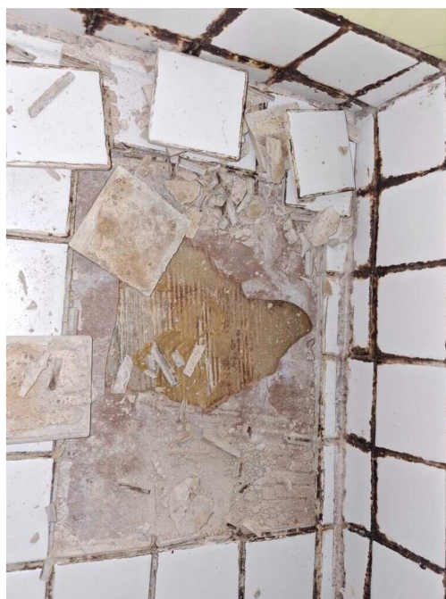
Kuva 18 Kylpyhuoneen lattiaaikat on kiinnitetty alkuperäisen muovimaton päälle. Muovimaton alta mitattuna kallistusvalu todettiin olevan kostea.
