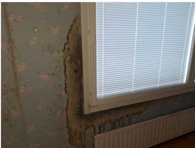
Kuva 14 Makuhuoneen ka keittiön ikkunan sivuilla, alla ja päällä seinissä vuotojälkiä. Seinien kosteus tarkastuksessa normaali. ( huom .pitkän pakkasjakson jälkeen)
