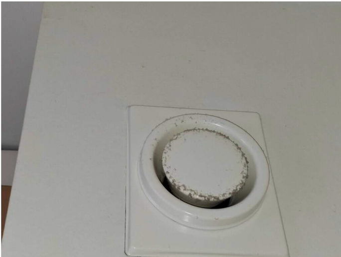
Kuva 9 Keittiön poistoilma venttiili on likainen.
