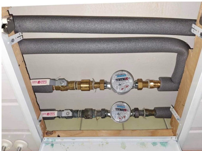
Kuva 15 Taloyhtiöön on uusittu käyttövesiputkitus. Putkistoille on asennettu sulkuventtiilit sekä veden mittaus.
