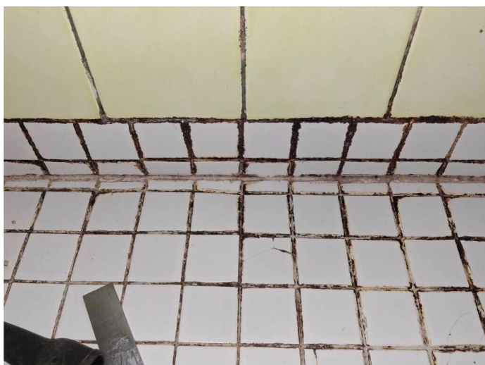
Kuva 17 Kylpyhuoneen pinnoitteet ovat ylittäneet suunnitellun käyttöikänsä.
