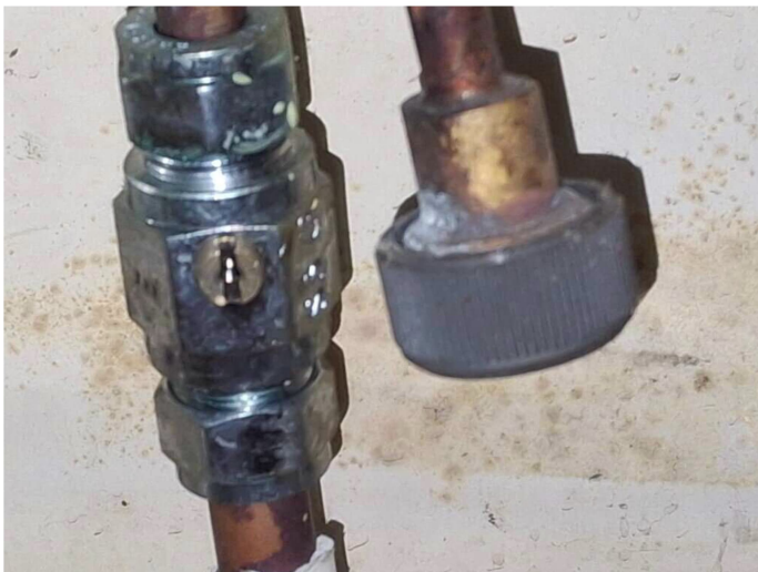
Kuva 12 Pesukoneventtiilin muovinen sulkutulppa ei pidä jatkuvaa painetta , mikäli paine on esim .vahingossa kytketty päälle.
