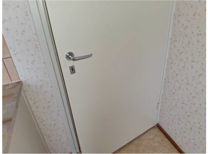
Kuva 8 Väliovet ovat alkuperäiset.
