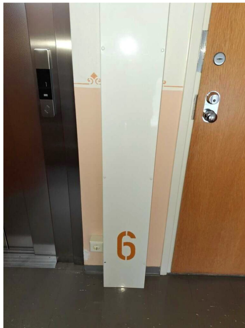
Kuva 16 Porraskäytävässä nousuputkisto koteloituna.
