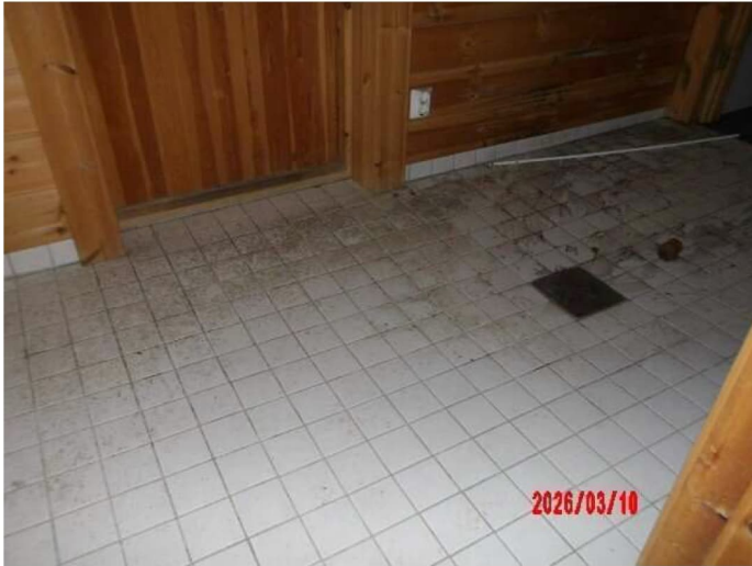
Kuva 6 Pukuhuoneen lattialla jätettä viemärin tulvimisesta
