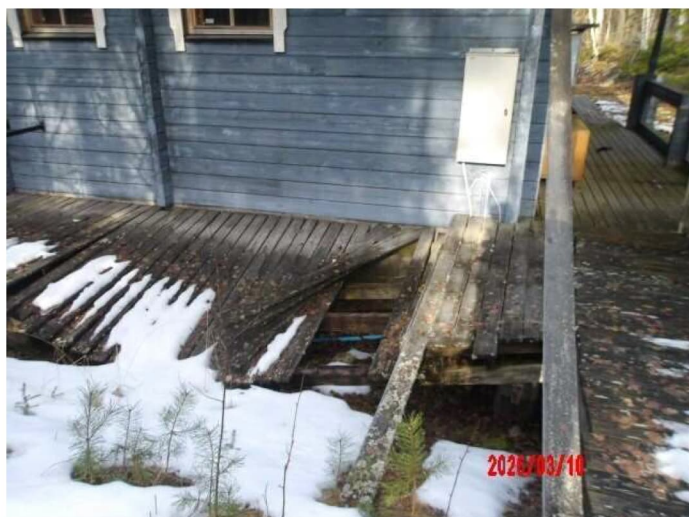
Kuva 22 Ulkopuolella olevat terassit ovat vaurioituneet
