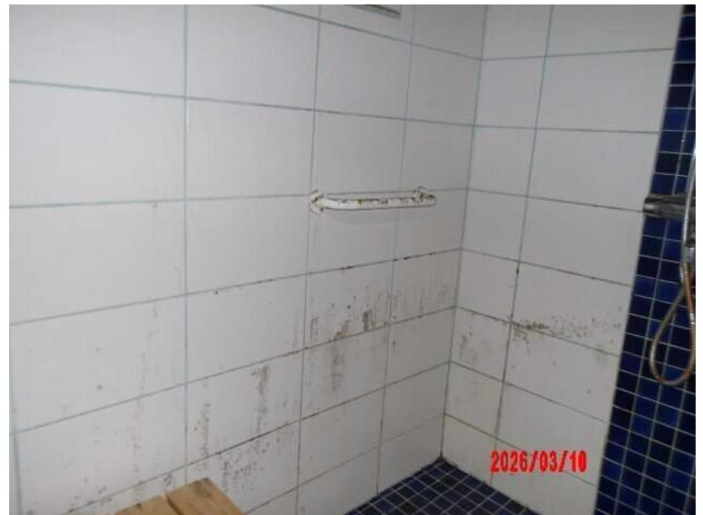
Kuva 9 Pesuhuoneen seinällä mikrobikasvustoa
