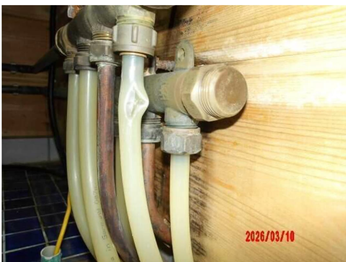
Kuva 14 Vesijohto on jäätynyt rikki
