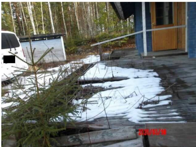
Kuva 24 Ulkopuolella olevat terassit ovat vaurioituneet
