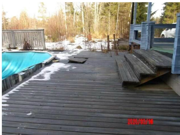
Kuva 23 Ulkopuolella olevat terassit ovat vaurioituneet
