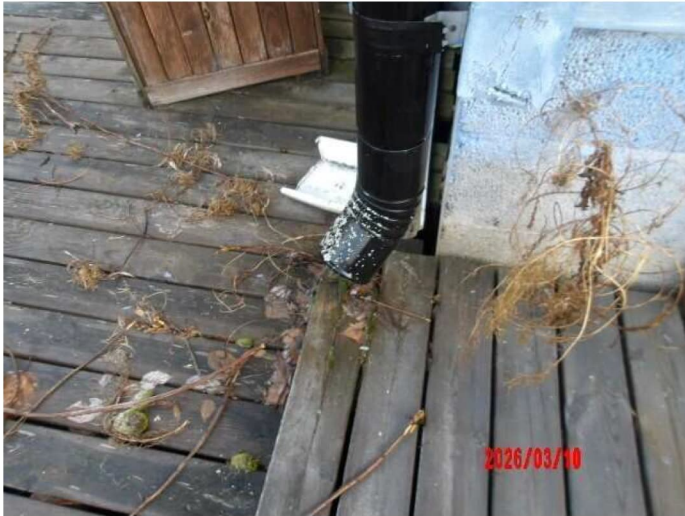
Kuva 28 Sadevesien poistoa ei ole
