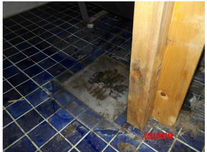
Kuva 11 Saunan lattiakaivon päällä jätää
