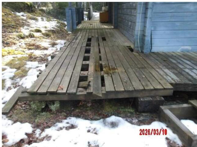
Kuva 20 Ulkopuolella olevat terassit ovat vaurioituneet
