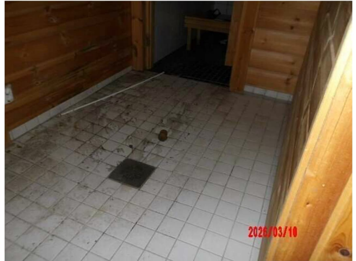
Kuva 7 Pukuhuoneen lattialla jätettä viemärin tulvimisesta
