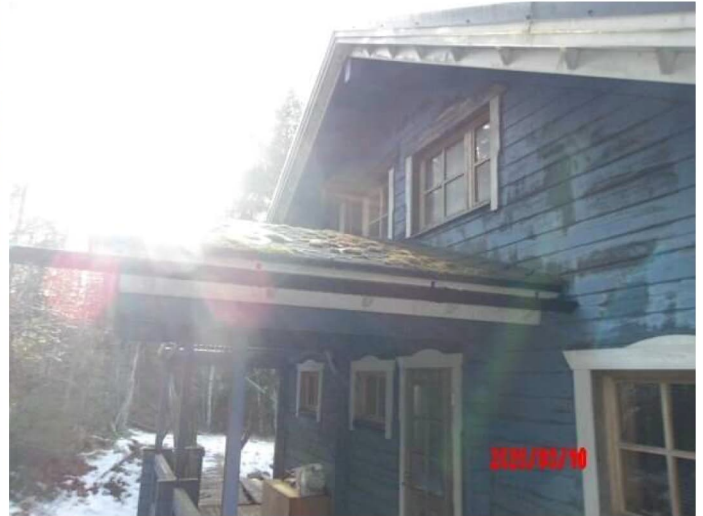
Kuva 29 Julkisivu puhdistettava ja maalattava
