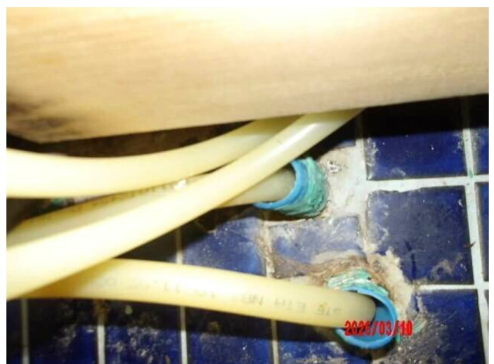
Kuva 15 Suojaputkessa on vettä
