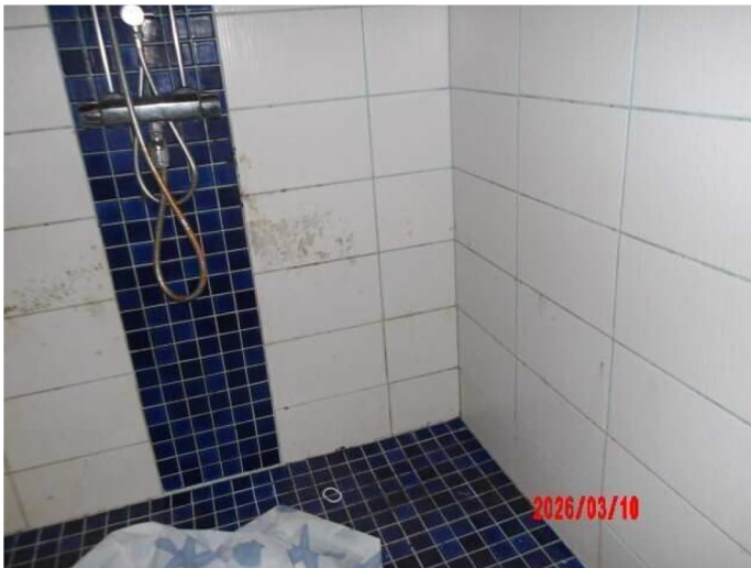
Kuva 10 Pesuhuoneen seinällä mikrobikasvustoa
