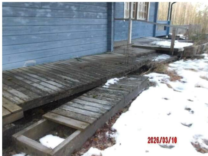
Kuva 21 Ulkopuolella olevat terassit ovat vaurioituneet
