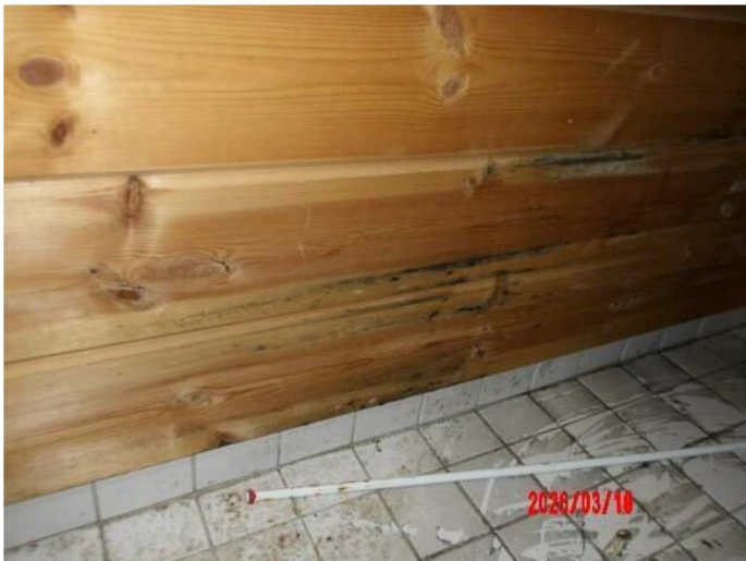
Kuva 8 Pukuhuoneen seinällä mikrobikasvustoa
