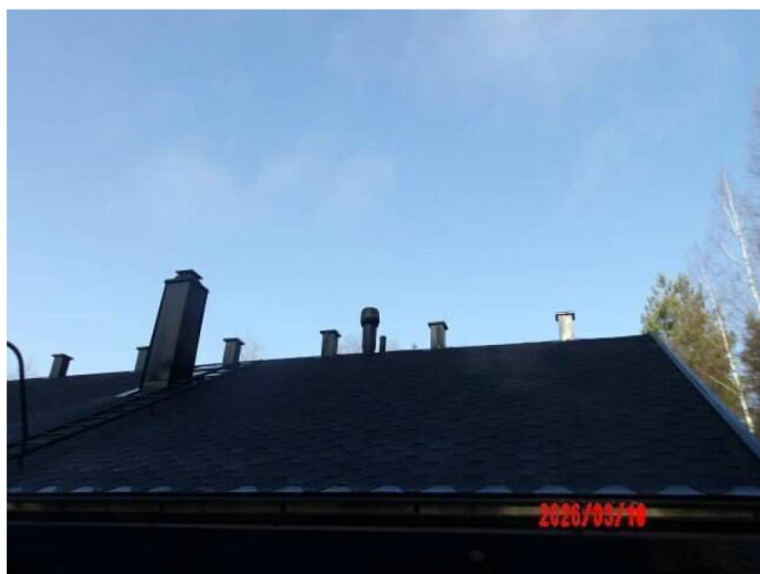
Kuva 27 Katon tuuletuksen poistoilma tulee harjalta, terassin alueelta puuttuu poistoilmakanavat
