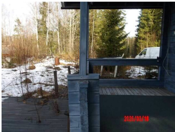
Kuva 25 Yläkerran terassin kannattimet ovat vinossa
