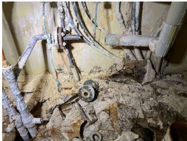
Kuva 8b. Kosteusvaurio teknisessä tilassa. Putki katkaistu. Arviolta materiaalit tippuneet seiniltä kosteuden vaikutuksesta.
