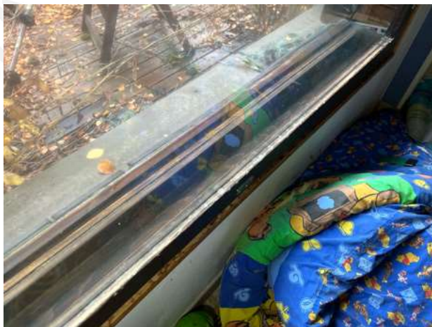
Kuva 3b. Haalistumaa ikkunassa.
