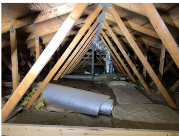
Kuva 4d. Yläpohjaa. Ei nurjahduksia kattotuoleissa. Viemärin tuuletusputki eristämättä.
