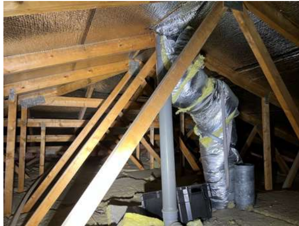
Kuva 9c. Viemärin tuuletusputki on muovia (ja eristämättä).
