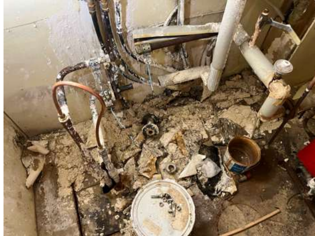
Kuva 9b. Teknisen tilan putkistoja. Kaikkien kunto varmennettava ennen käyttöönottoa.
