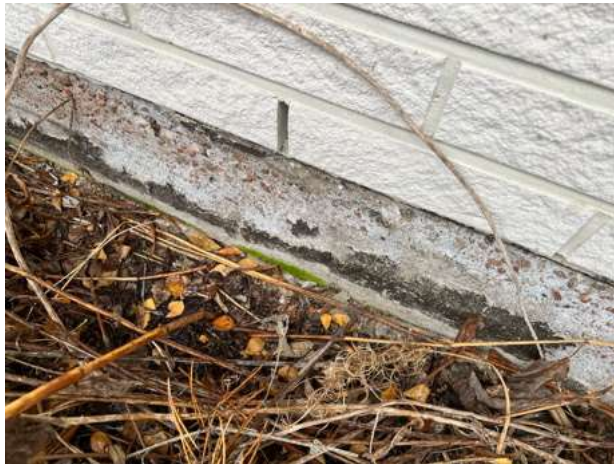
Kuva 1a. Sokkelin pinnoite on rapautunut. Kosteushärmää sokkelin pinnalla.
