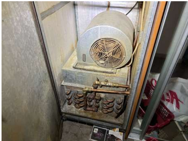
Kuva 10b. Ilmanvaihtokoje on ikääntynyt ja ollut pois käytöstä. Huolto on tehtävä ennen uudelleen käyttöä ja uusimiseen on suositeltavaa varautua.
