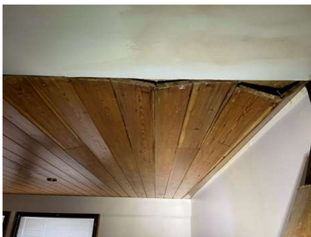
Kuva 6e. Alakattotarkastelua. Panelointi vääntynyt (voi liittyä teknisen tilan vaurioon / tilojen kylmillään oloon).
