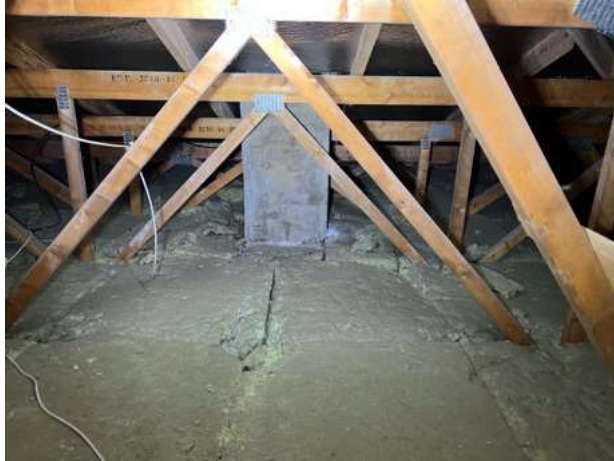
Kuva 4f. Kosteusjälkiä hormissa.
