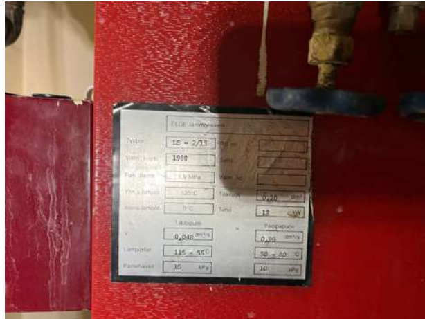
Kuva 8a. Lämmönsiirrin on alkuperäinen. Toimintakunnosta ei tietoa, laite oli suljettu.
