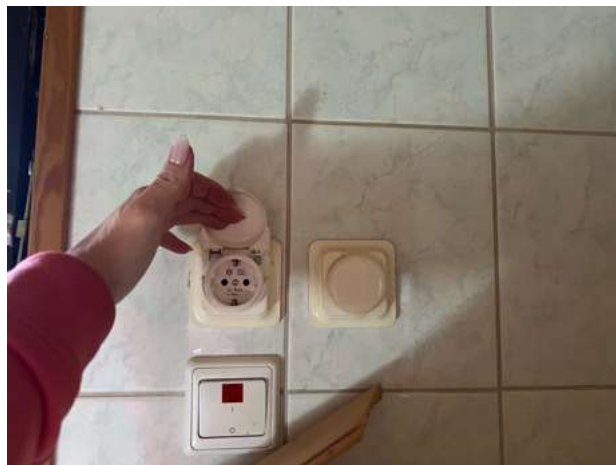
Kuva 11b. Vikavirtasuojauksen TEST-painiketta tulee koestaa säännöllisesti.
