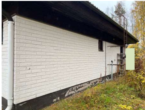
Kuva 2a. Päätyisivu. Teknisen tilan kosteusvaurio näkyy arviolta myös sokkelissa.
