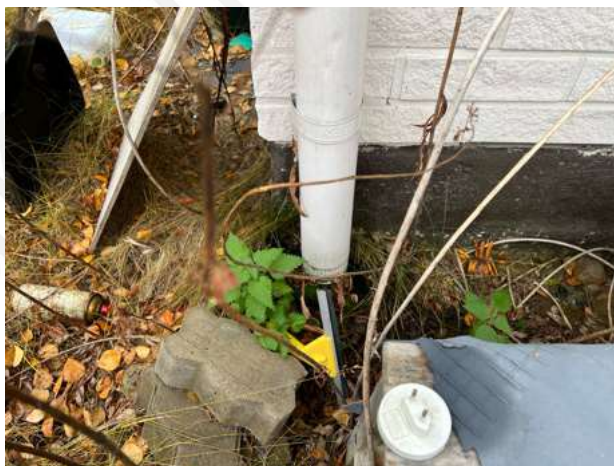
Kuva 1c. Kattovesien ohjausta. Kaivot tulee puhdistaa ja niiden toimivuus tulee tarkastaa.
