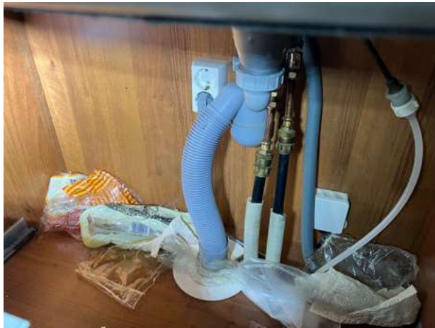
Kuva 5.5b. Allaskaapissa ei havaittu vuotojälkiä. Pesukoneen liitännät tulee ankkuroida.
