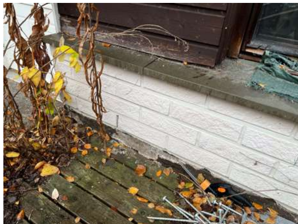
Kuva 1d. Terrasilautoitus kiinni sokkelissa. Kosteushärmää ja kasvillisuutta.
