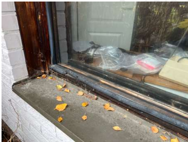
Kuva 3a. Vesipellit. Haristumaa ikkunassa.
