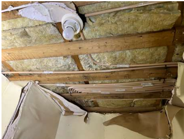
Kuva 6d. Teknisen tilan alakatossa kosteusjälkiä.
