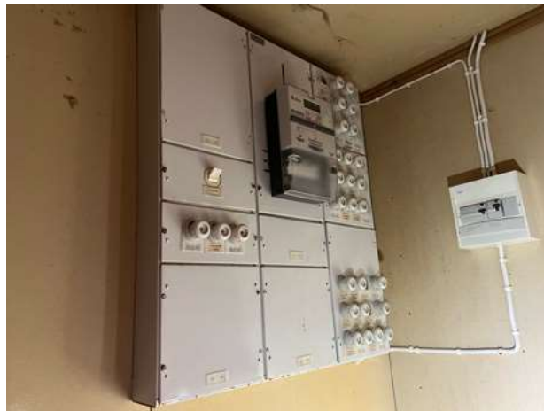
Kuva 11e. Sähköpääkeskus. Vieressä uudempaa sähköistystä.
