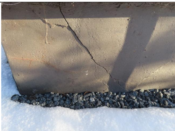
Sokkelissa muutama halkeama
