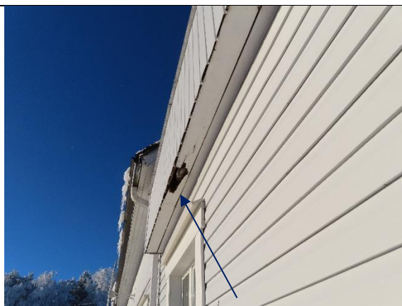
Laajennusosalla räystääslaudoituksessa lahoa
