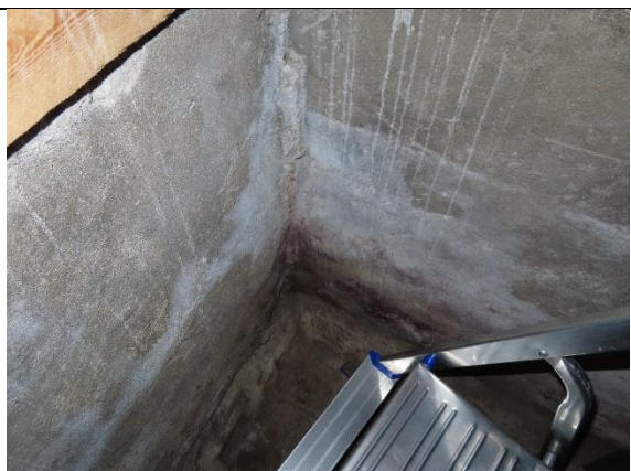
Kellarin lattiassa ja seinien alaosissa kosteusrasituksen jättämää jälkeä
