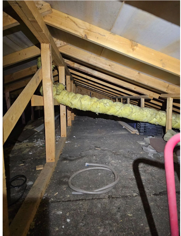
Kanava on eristetty, mutta se on kannakoitu vain yläosastaan laudalla.
