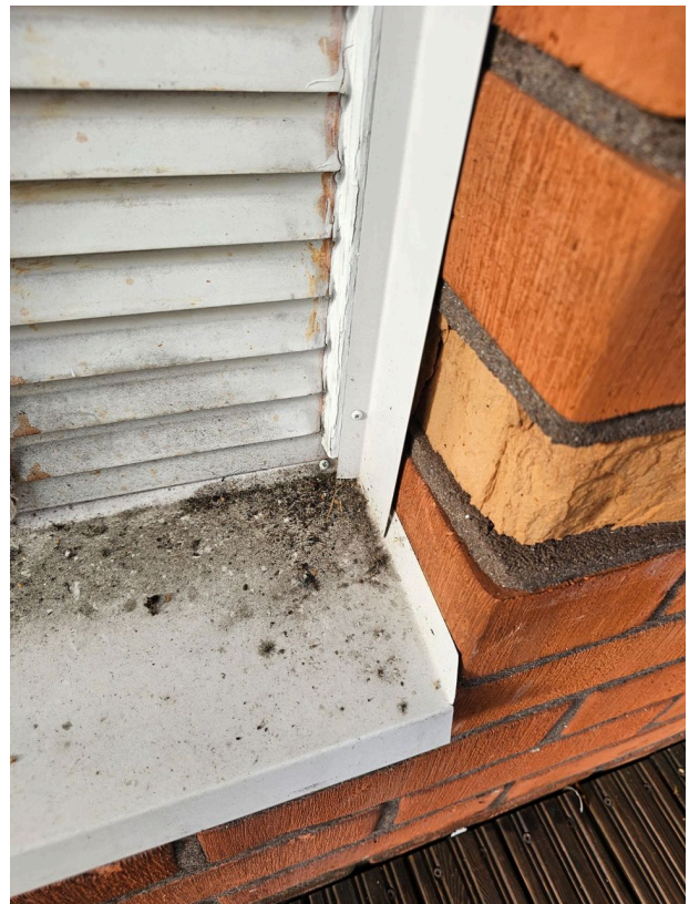
Ikkunan pielen tiili on pinnaltaan rapautunut
