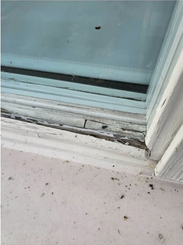
Osa ikkunoista on heikkokuntoisia.
