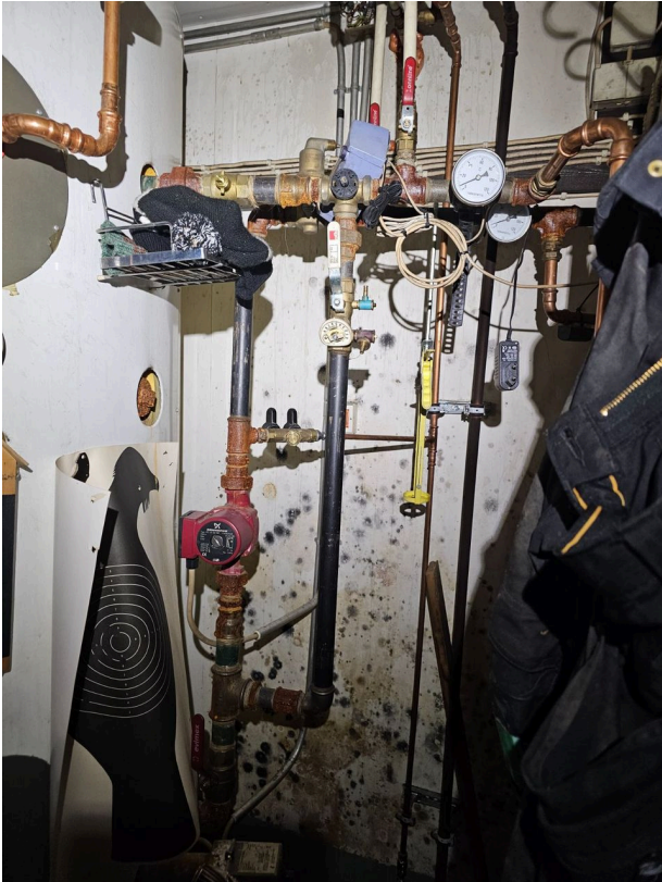
Kaikissa liitoksissa on ruostetta, ja seinä takana on mikrobivaurioitunut
