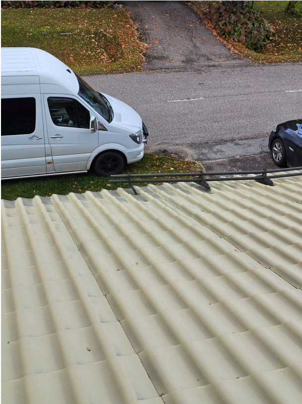
Tien puolen lumiaste on repeytynyt osittain irti.
