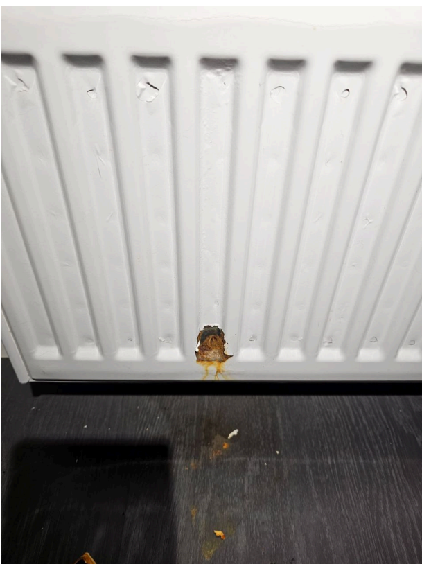
Patteri on rikkoutunut jäätymisen seurauksena
