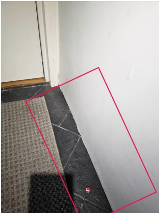
Tuulikaapin seinän alaosa on turvonnut kosteudesta
