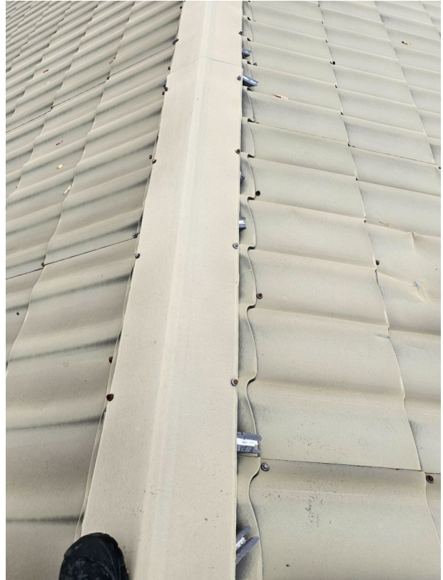
Harjapellin tiivisteet ovat osin pois paikaltaan.
