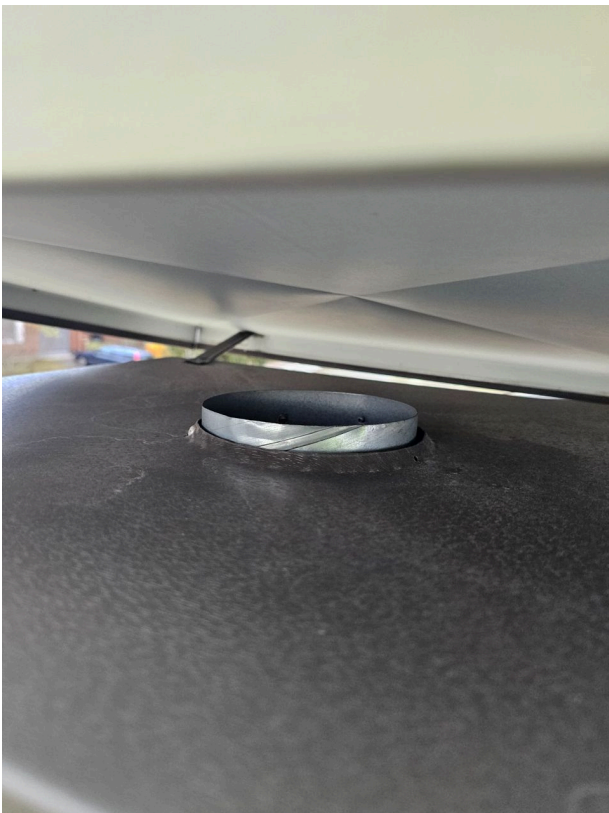
Kanavan pään ja pellin välissä on rako, josta voi päätyä sulamisvesiä yläpohjaan.
