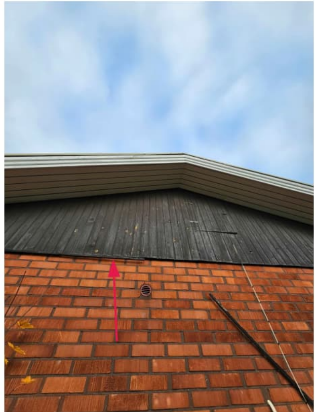
Paneloinnin reunalista on osin irti, ja osin se puuttuu kokonaan.
