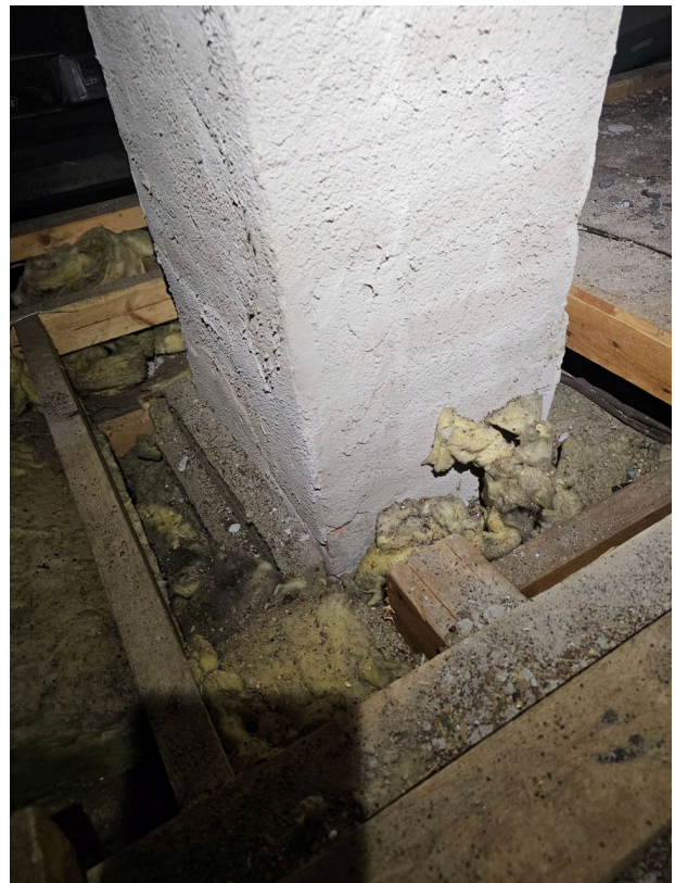
Piipun läpiviennissä on palovillaa 100 mm
