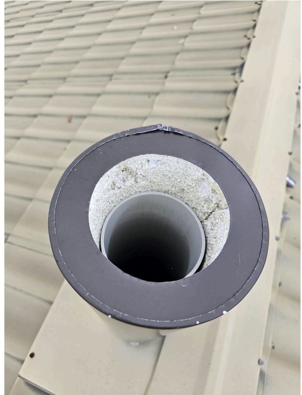
Viemärin tuuletusputken pää on kehyksen alapuolella, ja pää on epätiivis. Näin putken ulkopintaa pitkin voi päätyä sadevesiä yläpohjaan.
