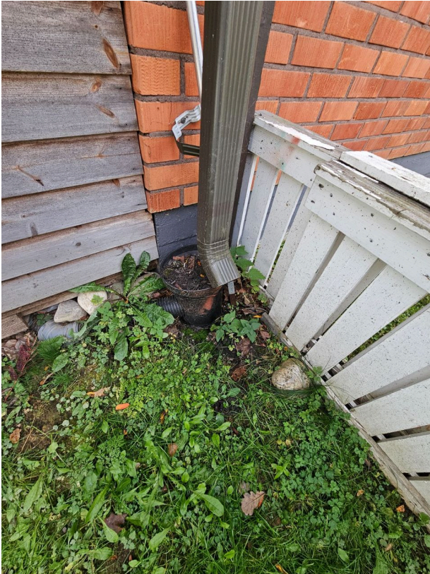
Syöksytorvi on irti, ja vesi ohjautuu talon seinustalla maahan.
