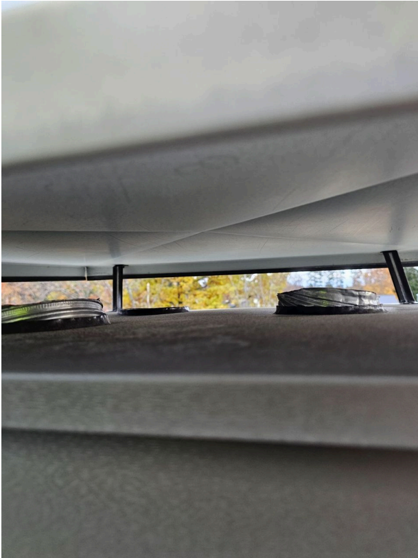
Alkuperäisiä alumiinisia iv-kanavia, ns. kurtutputkea.
