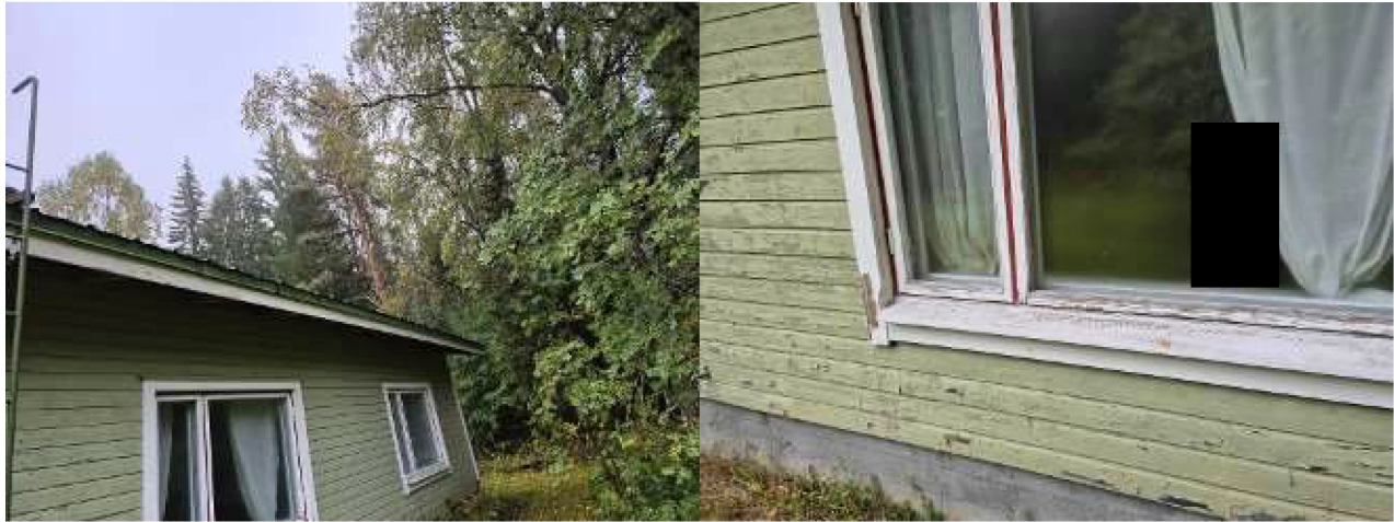
Pääosin räystäskouruja ei ole
