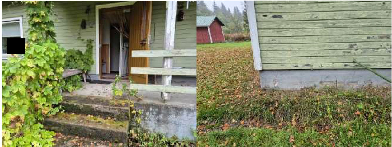
Rakennuksessa valesokkelirakenne, näkyvä sokkeli nousee lattiapintaa ylemmäs, puurunko alkaa lattiapintaa alemmää Sokkelissa halkeamia ja pinnoitteen irtoilua
