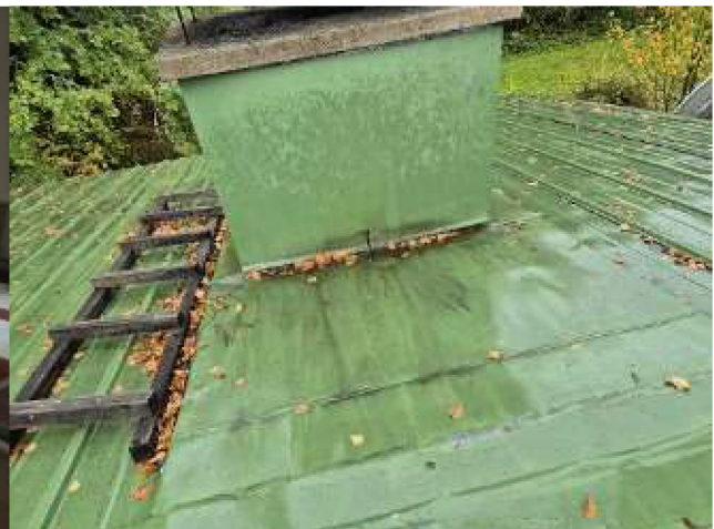
Saunan päädyn piipun pellitys revennyt
