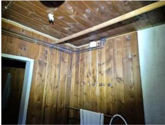
Käyttövesiputket pinta-asenteista kuparia
