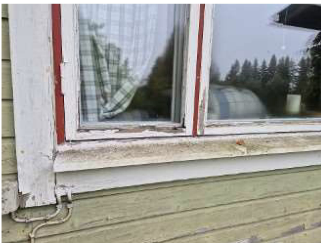
Ikkunoiden ulkopokissa lahovaurioita
