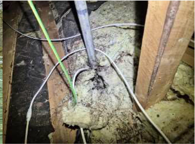
Pipun luota vettä valunut yläpohjaan
