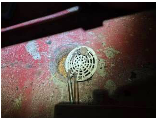
Lattiasta maalia irtoillut, lattiakaivo ruosteessa
