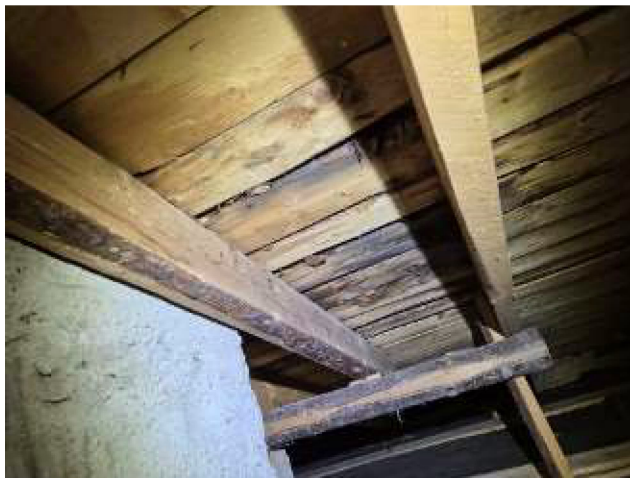
Piippujen luona vanhoja vuotojälkiä
