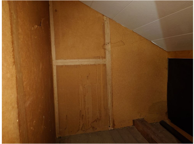
Kuva 2. Vanhoja vuoto jälkiä, voi viitata alakerran vuoto jääkiin
