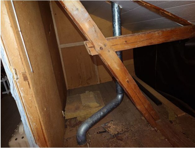
Kuva 1. Ilmavaihdon läpivienti, eriteet puuttuu
