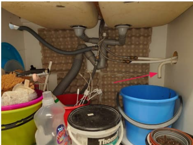
Hajulukko ja putkituksia, varoventtiilin juoksuputken alla astia
