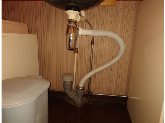
Hajulukko ja viemärin alipaine tuuletin
