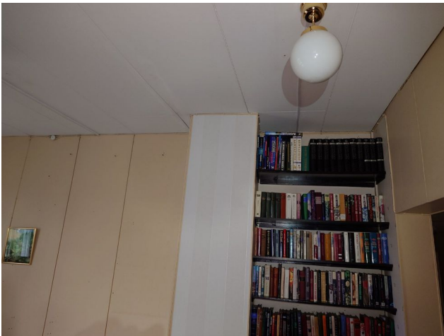
2krs etupiha kulma, ilmanvaihdon koteloointi
