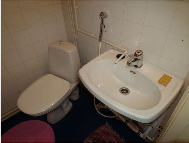
Vesipiste ja varoventtiilin juoksuputki
