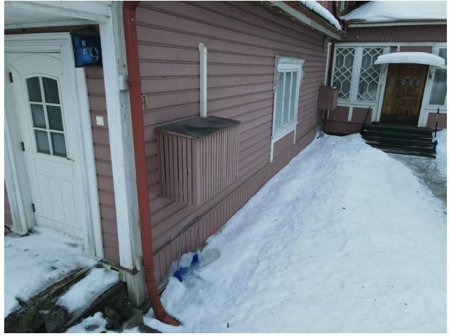
Kuva 67. Syöksy putki ja ILP-Ulkoyksikkö
