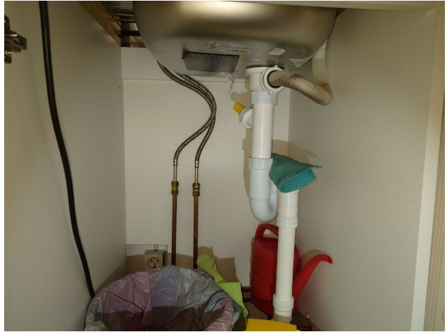
Hajulukko ja putkituksia
