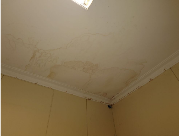
Vanhoja vaurio jälkiä (kuiva), varasto keskellä
