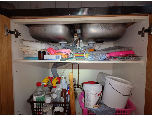
Hajulukko ja putkituksia
