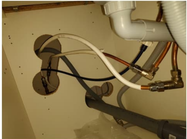
Käyttöveden sulkuja ja putkituksia
