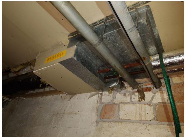
IV ja lämmitys putket
