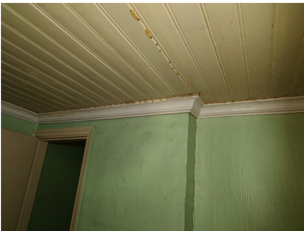
Kuva 11. Hormin kosteuskeskiarvo 42 kuiva
