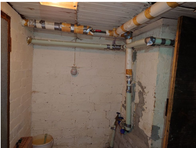
Käyttövesi ja lämmitys putkia, kannakointi voisi olla parempi
