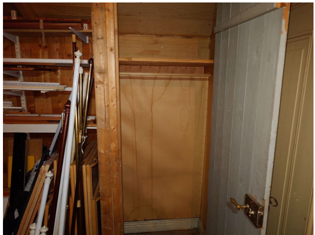
Kuva 4. Vanhoja vuoto jälkiä
