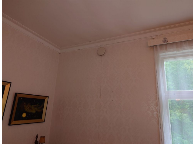
MH pääty, ilmanvaihto
