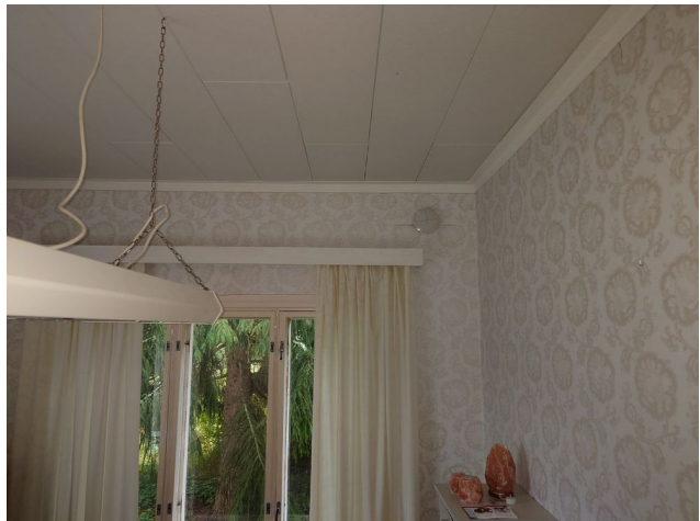
MH siipi kulma huone, ilmanvaihto
