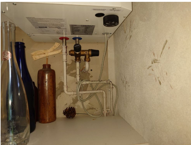
Vesivaraaja vuosimallia 2013, varoventtiilin putki
