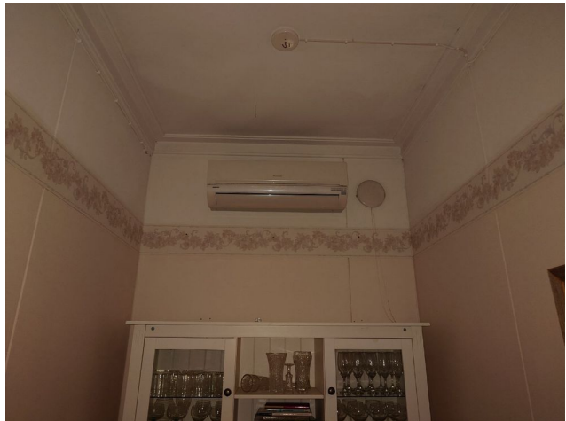
Käytävä, ILP-sisäyksikkö ja ilmanvaihto
