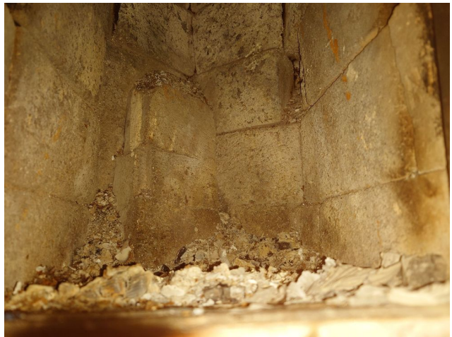
Tulipesä kohtalaisessa kunnossa
