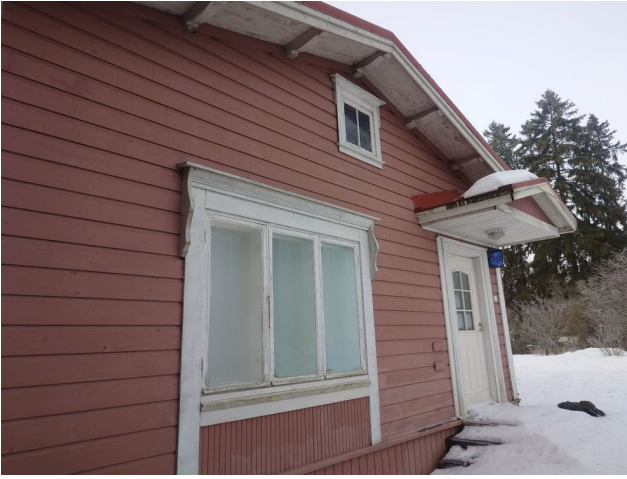
Kuva 66. Yläpohjan tuuletus ritilä puuttuu
