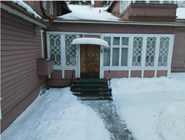
Kuva 68. Syöksy putki ja ILP-Ulkoyksikkö. Portaiden kaide puuttuu
