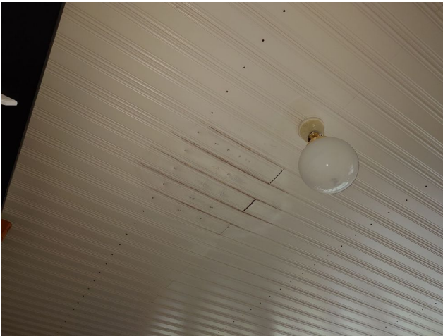
Aula, vanha vauriojälki (kuiva)
