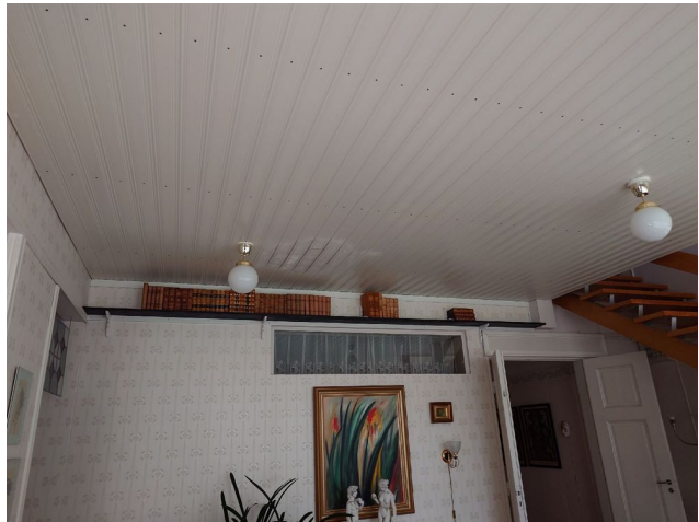
Aula, vanha vauriojälki (kuiva)
