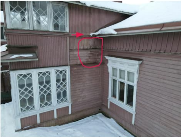
Kuva 44. Sulamis ja sadevesistä aiheutunut vaurio, uloke kallistus purettu yhteydessä.
