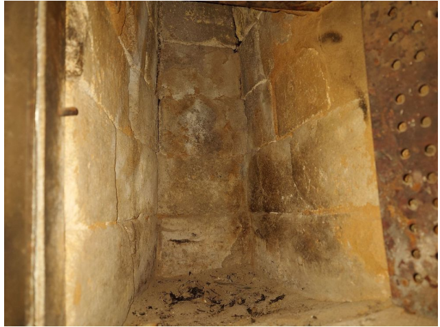
Tulipesä kohtalaisessa kunnossa
