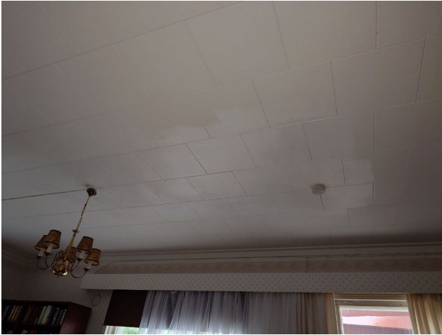
Kirjaston kattoa paikka maalattu, syytä ei tiedetä
