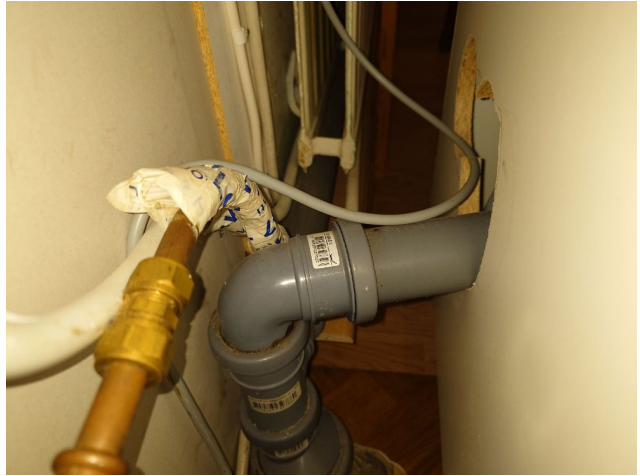
Käyttöveden ja viemärin yhteitä kalusteen takana
