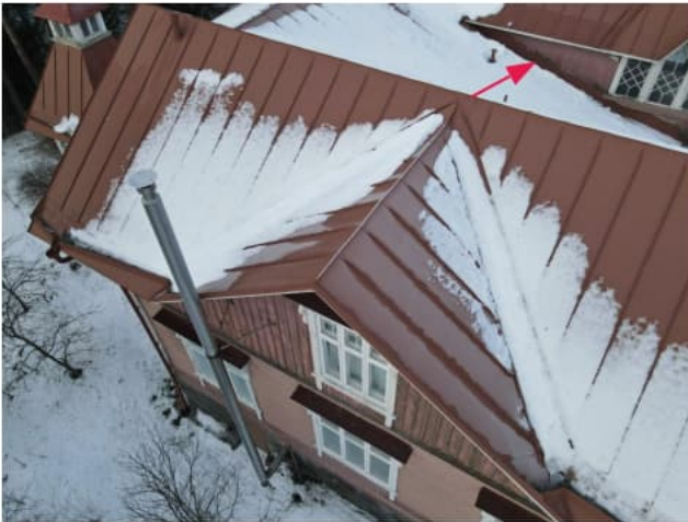
Kuva 25. Yleiskuva ja julkisivun vaurioita
