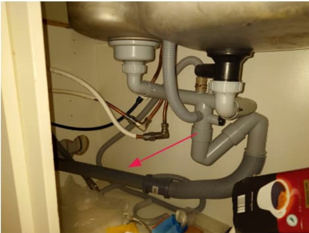
Hajulukko ja putkituksia. Viemärin kallistus huono ja tuenta huono
