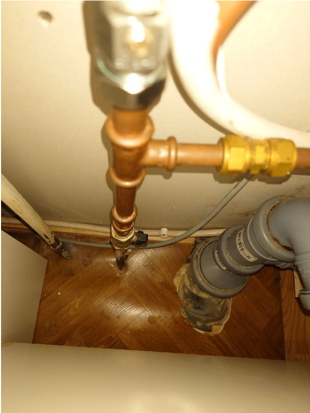
Käyttöveden ja viemärin yhteitä kalusteen takana
