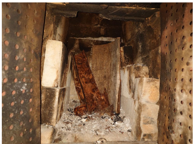
Tulipesä kohtalaisessa kunnossa
