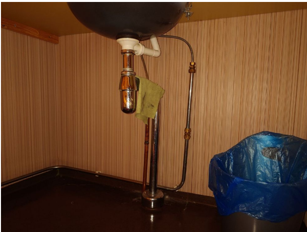
Hajulukko ja putkituksia
