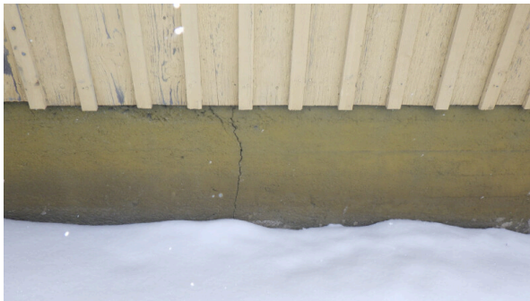
3. Sokkelissa on muutamia halkeamia
