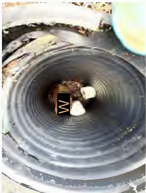
salaojan tarkastuskaivo, laajennusosa
