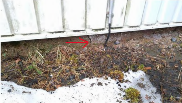
halkeama sokkelissa + sähköjohtoni suojakourua)
