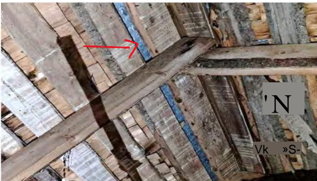
harjalla aukko pärekatteessa, pelti näkyy
