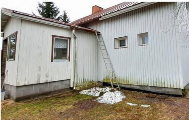
sokkelin reunassa laajennuksessa patolevy, ei sokkelilistaa, sokkelia ei pinnoitettu
