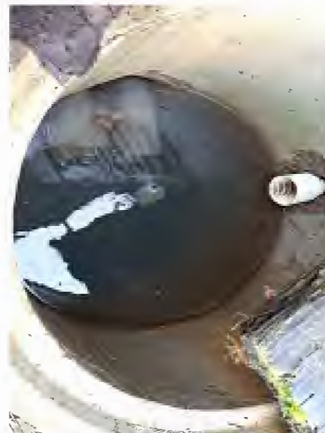
kokoojakaivo, vesi seisoo poistoputkien yläpuolella
