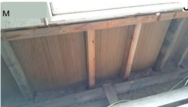
ikkunan alla veden valumajälkiä ts-levyn sisäp.
