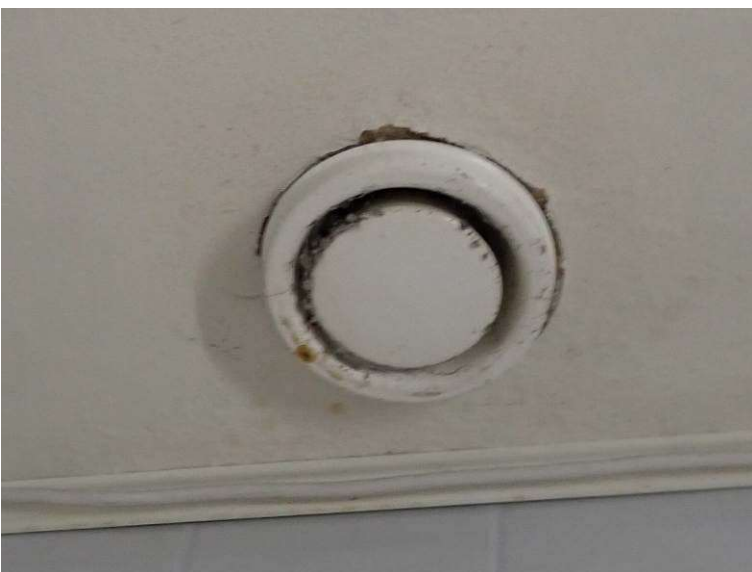
Kuva 7, ilmanvaihtoventtiilin ympärillä sisäkatossa on värimuutosta.
