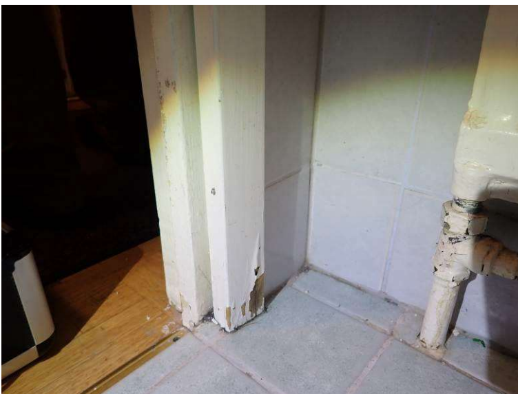
Kuva 4, kylpyhuoneen oven peitelistoissa on halkeamia ja maalipinnan vaurioita. Tulva- kynnystä eteiseen ei ole.
