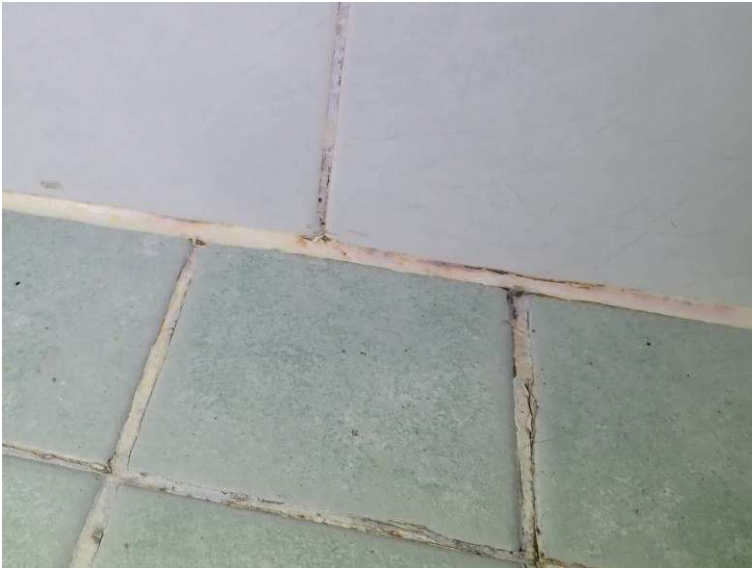
Kuva 5, laattojen saumauksissa on rapaumaa ja silikonisaumoissa epätiivelys kohtia.
