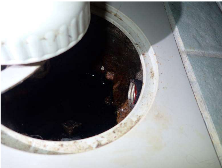
Kuva 3, kylpyhuoneen lattiakaivo. Koroke- renkaan läpivienti on tulpattu korkilla.
