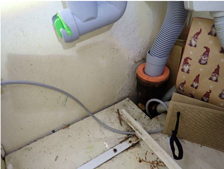
Kuva 11, Allaskaapin läpiviennit eivät ole tiiviitä ja hyllylevyssä on kosteuden aiheuttamia muutoksia.
