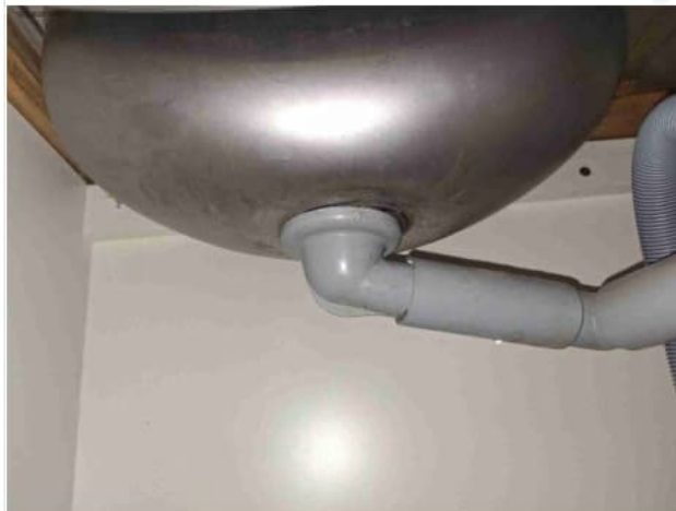
Kuva 2. Vuotoa altaan viemäriputkiliitoksessa
