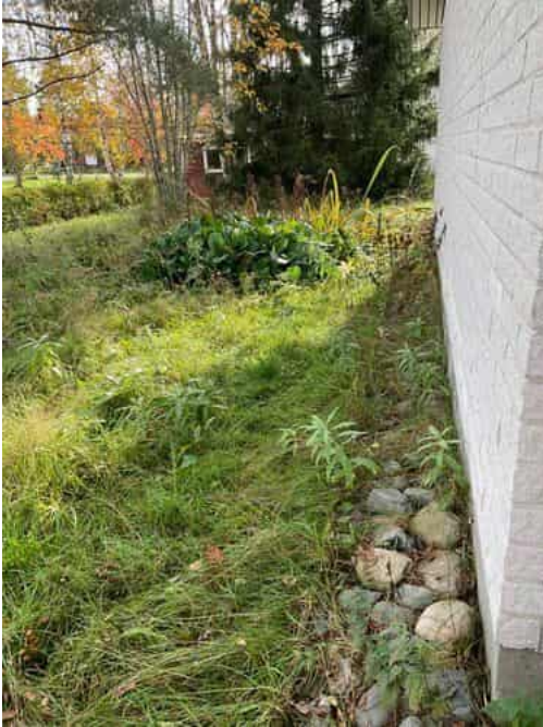
Kuva 7 Rakennuksen vierustoilla puita ja istutuksia, joiden juuret mahdollisesti vaarantavat rakennuksen rakenteita.
