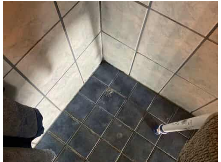
Kuva 29 Saumat ja silikonit on paikoin huonossa kunnossa.
