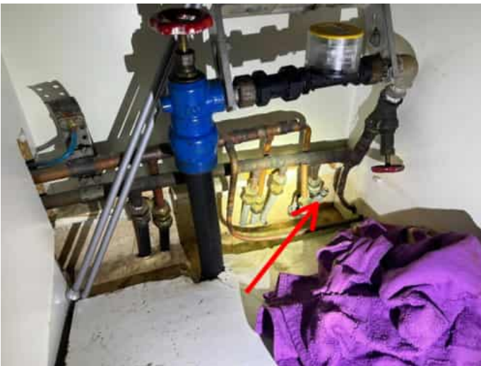
Kuva 36 Kodinhoituhuoneessa on vesimittari ja jakotukki. Jakotukin alla havaittiin, että kaksi putkiliitosta on irronnut. Vesilaitoksen mukaan asunnon vesiä on käytetty päällä ja paine ei ole pysynyt järjestelmässä. Tämä rikkiäinen liitos on todennäköinen syy, että paine ei ole pysynyt. Liitoksen lähellä on lattiakaivo, joten vesi on todennäköisesti mennyt lattiakaivoon. Putkien juuressa, päällimmäisessä muovimatossa on avoimet liitokset lattian läpi, joten osa vedestä on päätynyt myös lattiarakenteeseen / mattojen väliin.
