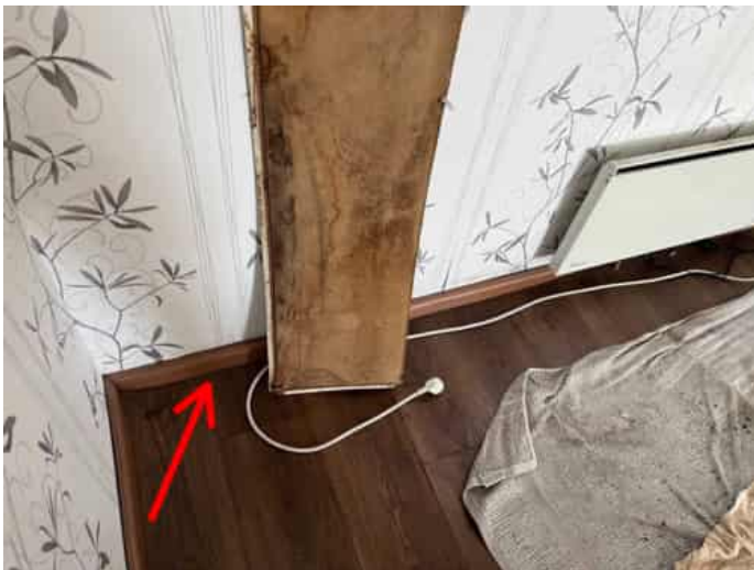
Kuva 9 Keittiön ulkoseinällä on näkyvillä vaurioita listoissa ja seinälevytyksessä. Seinän runkorakenne on mahdollisesti vaurioitunut vesivuodosta johtuen.
