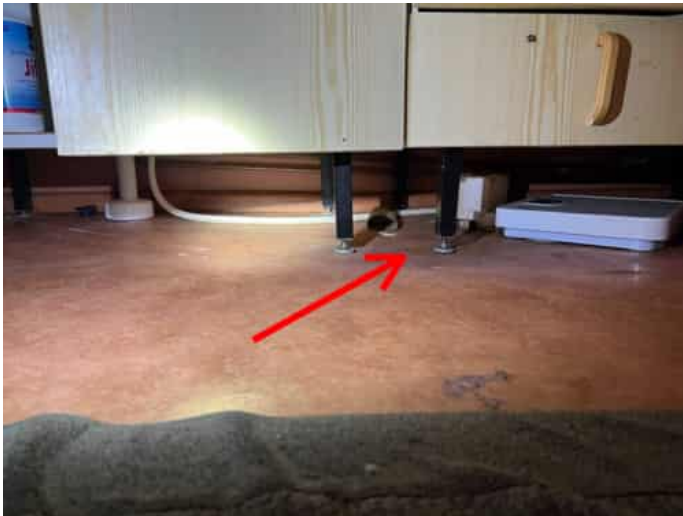
Kuva 33 Allaskaapin alla havaittiin vanha kosteusjälki lattian pinnalla. Ei tietoa, että mistä johtuu.
