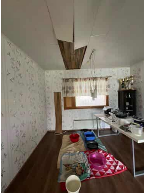
Kuva 41 Olohuoneen katto vuotaa vettä sisälle.
