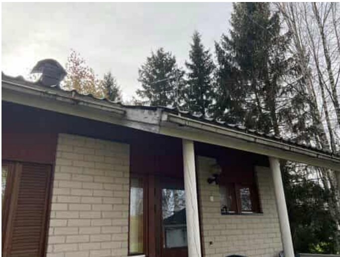
Kuva 13 Puuosat on huollon ja maalauksen tarpeessa
