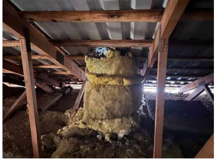
Kuva 24 Vesikaton läpiviennin juuri vuotaa vettä välikatolla
