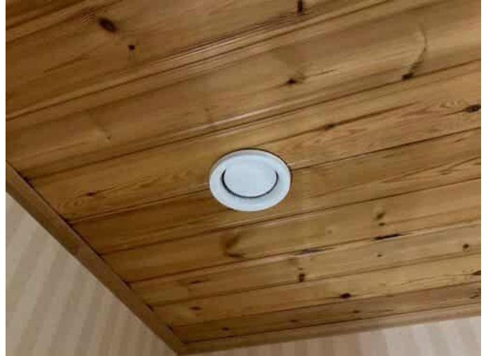
Kuva 32 WC:ssä on koneellinen poistoilmanvaihto.
