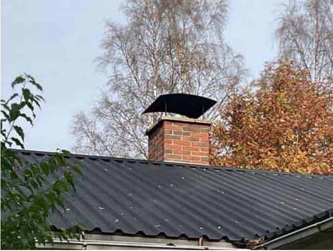
Kuva 47 Savuhormi pellittämättä vesikaton osalta.
