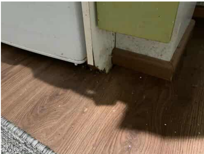
Kuva 39 Jääkaappi vuotanut ja kastellut kalusterungon
