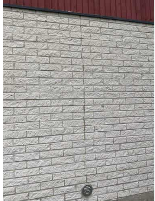
Kuva 12 Tiiliverhouksessa havaittiin paikoin halkeamia jotka tulisi korjata.
