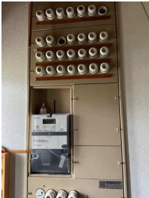
Kuva 56 Sähkötaulussa on merkinnät paikallaan.
