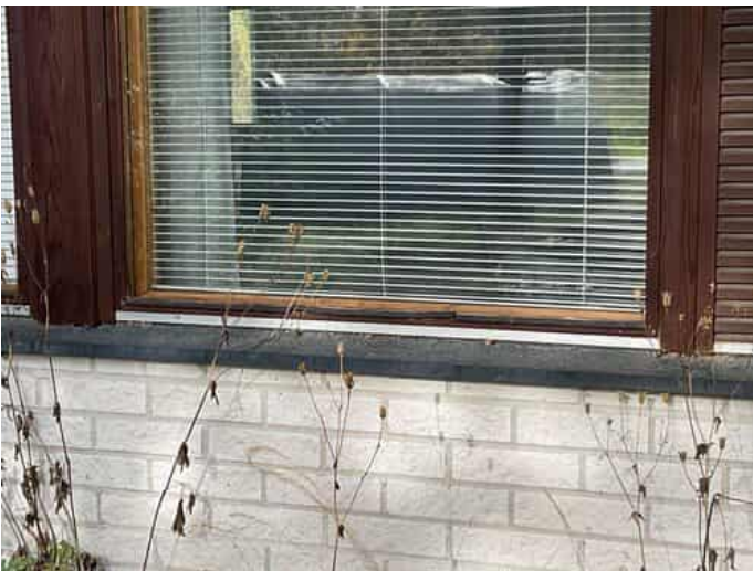
Kuva 15 Ikkunoiden ulkopuolet on rispaantuneet ja lasituslistoja puuttui.
