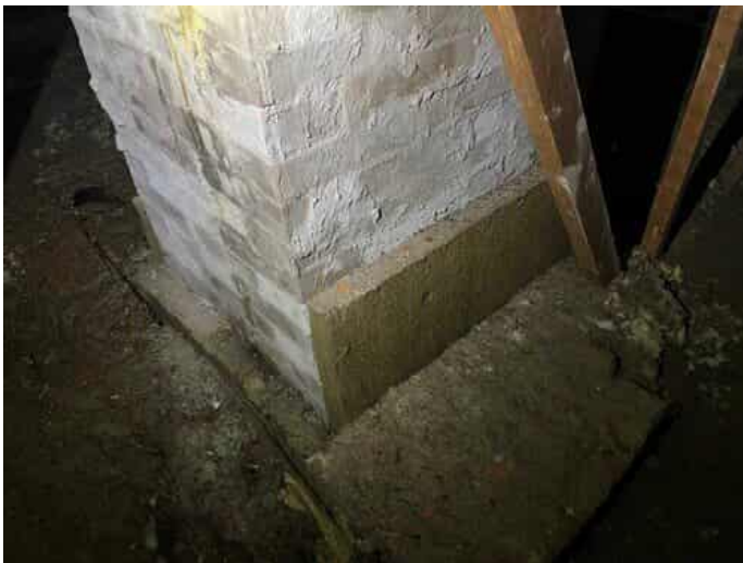
Kuva 25 Pipun juuri vuotaa vettä yläpohjaan. Vuoto on lievä.
