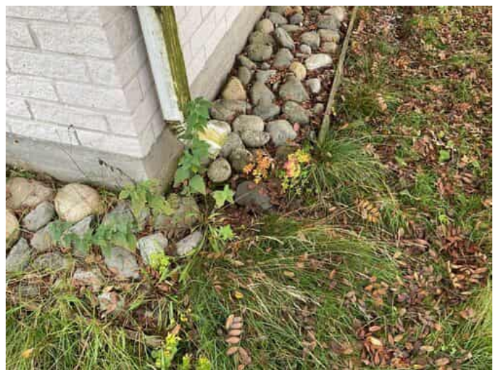
Kuva 6 Sadevesiviemärointi puuttuu kokonaan.
