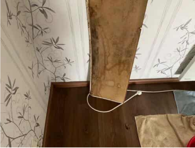
Kuva 45 Seinän alaosassa on näkyvää kosteutta.
