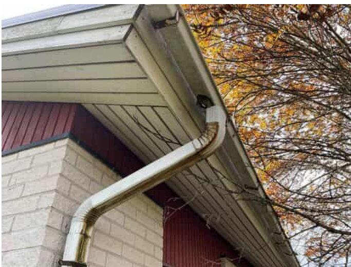
Kuva 5 Rännit puuttuu tai on irti.
