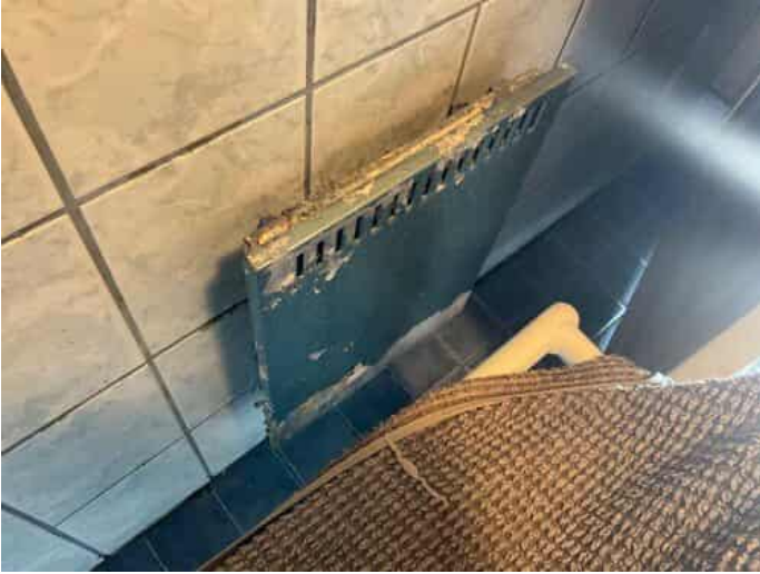
Kuva 30 Suihkussa on sähköpatteri
