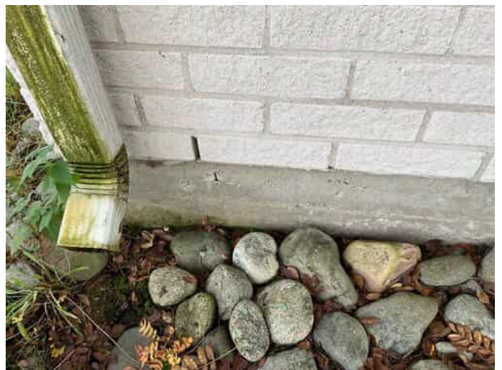
Kuva 4 Sokkeliraudotus on liian pinnassa ja se on aiheuttanut betonin halkeamisen
