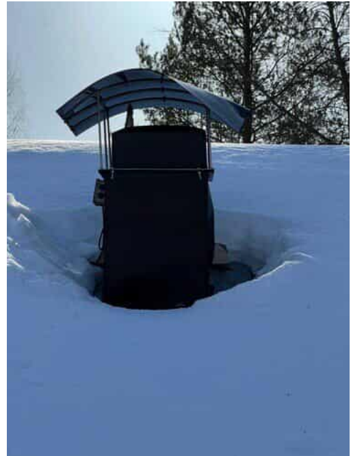
Kuva 19 Katolla havaittiin edelleen olemassa oleva vuoto ilmanvaihtohormin kohdalla. Hormin kattoa on korjailtu mutta vuoto on edelleen olemassa.
