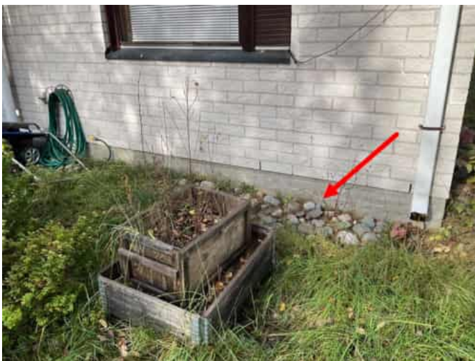
Kuva 3 Sokkelin pinta paikoin rapautunut
