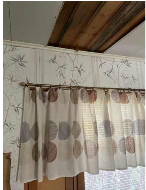
Kuva 44 Vesi valunut myös seinälle.
