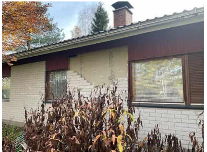
Kuva 10 Takapihan puolella tiiliverhous on isolta alueelta tippunut seinätikkaiden mukana.
