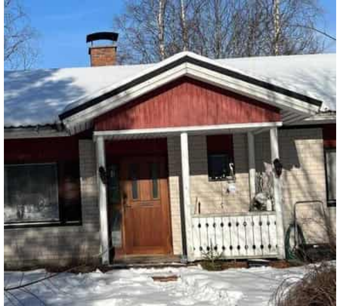
Kuva 2 Paikan päällä havainnoituna ei ole varmuutta todellisesta lattia-/sokkelirakenteesta. Ulkovi ei ole valesokkelille tyypilliseen tapaan maatasossa ja kolottuna sokkeliin. Asunnon lattia on myös n. 300mm ylempänä kuin maanpinta.
