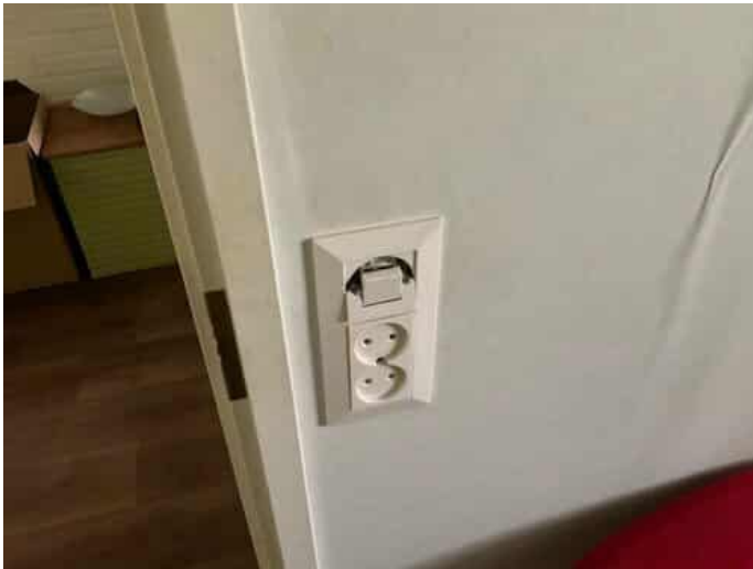
Kuva 54 Osa sähkökalusteista on rikki
