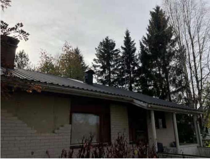
Kuva 16 Vesikate vaurioitunut. Aluskate puuttuu.
