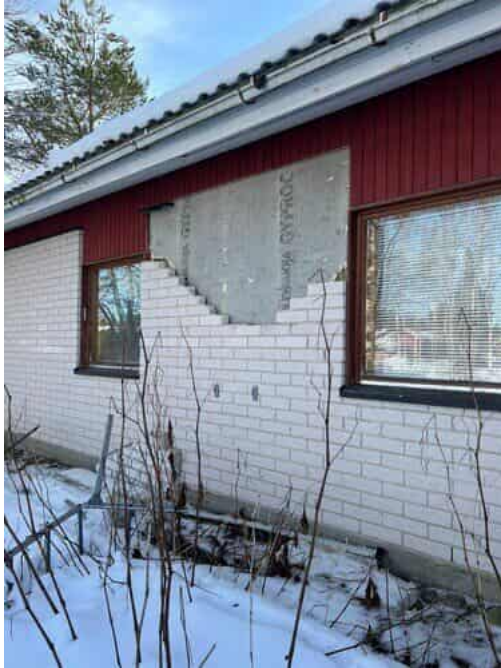
Kuva 11 Tiiliverhous on korjaamatta 3/2026.
