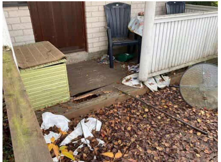
Kuva 14 Terassin pintalaudat on paikoin lahonnut poikki
