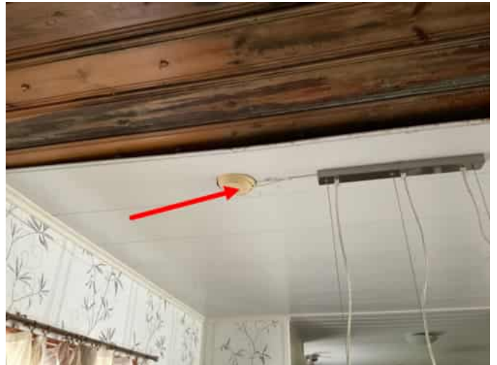
Kuva 55 Vuotavan katon kohdalla pistorasia, jossa on vettä
