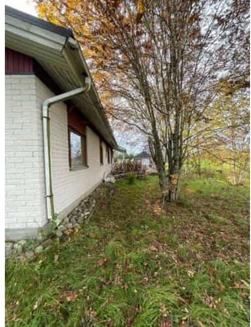
Kuva 8 Rakennuksen vierustoilla puita ja istutuksia, joiden juuret mahdollisesti vaarantavat rakennuksen rakenteita.
