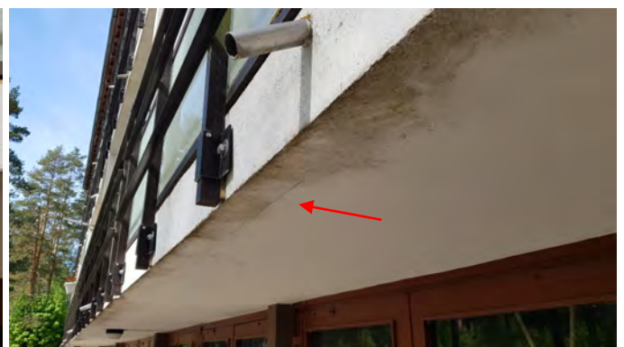
Kuva 11. Alimman parvekkeen alapinnassa oleva pitkittäinen halkeama.
