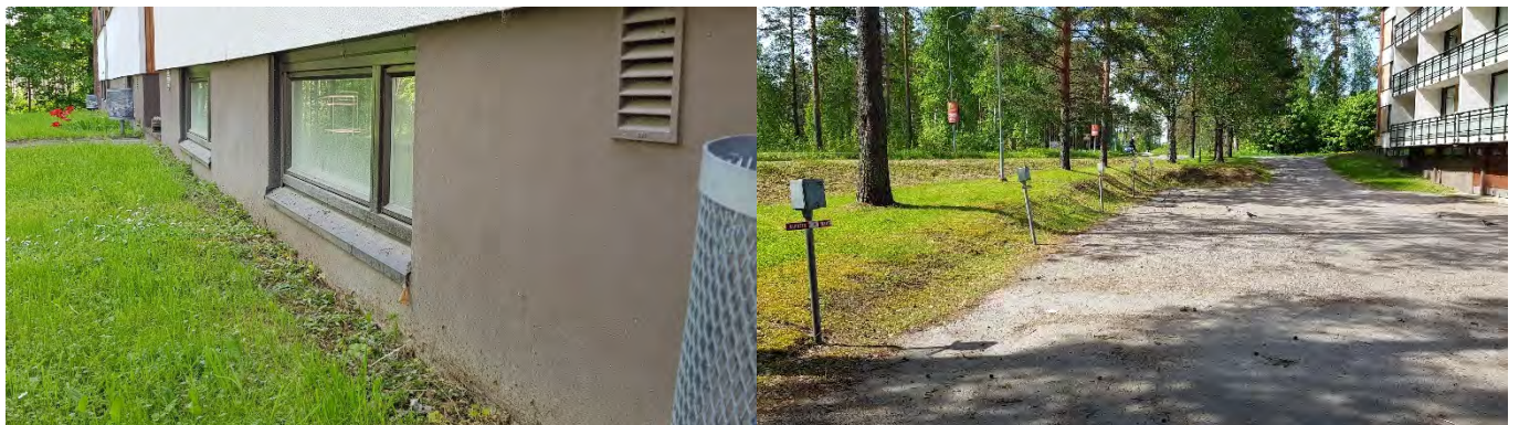
Kuva 1. Kasvillisuutta kiinni kellarikerroksen rakenteissa Kuva 2. Paikoitus- ja liikennöintialueet tyydyttävässä kunnossa.
