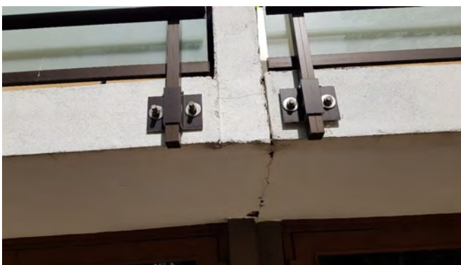
Kuva 10. Alimman parvekkeen alapinnassa oleva poikittainen halkeama.
