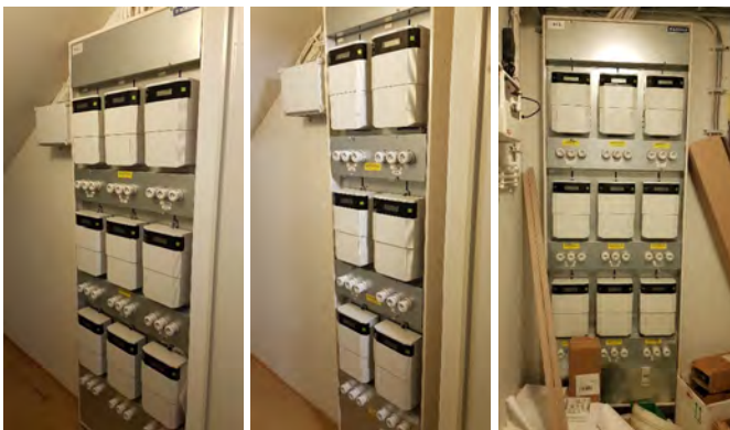
Kuva 29. Huoneistojen etäluettavat mittarit ja pääsulakkeet kellaritiloissa. Mittaroinnit ja asennukset hyvässä kunnossa
