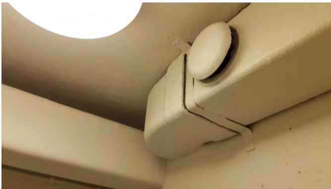
Kuva 31. Asbestia sisältävä ilmavaihtokanava kellaritiloissa
