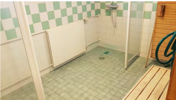
Kuva 25. Käyttöveden värjäämä lattialaatta suihkusekoittajan alla.
