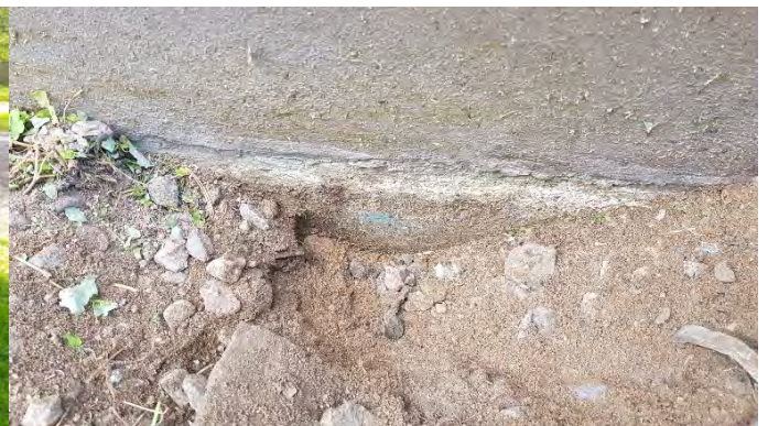
Kuva 5. Lähellä maanpintaa, kellarin ulkoseinän ulkopuolista vedeneristystä ei ollut havaittavissa.
