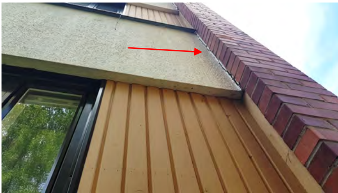
Kuva 6. Pystyhalkeama elementtirakenteen ja tiilijulkisivun liittymässä
