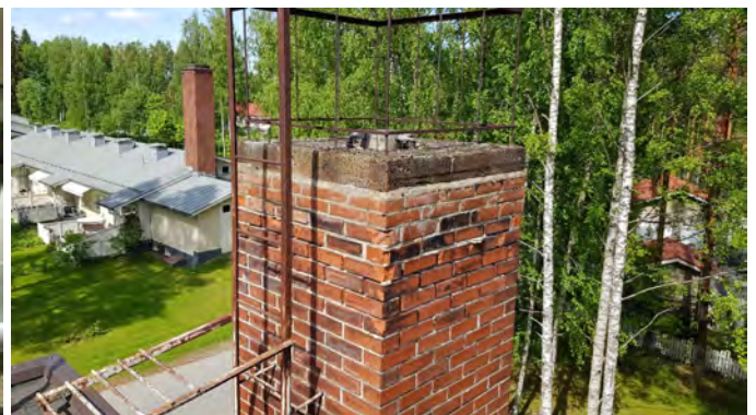
Kuva 22. Tiilihormin yläosan vaurioita, tiilihormissa on ruostumaton sisähormi.
