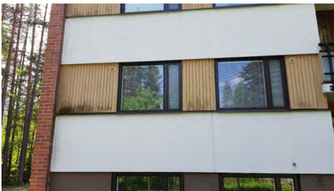
Kuva 8. Rakennuksen julkisivua, puuverhoukset paikoin vaurioituneet säärasitteesta
