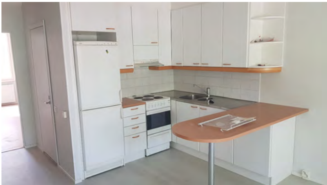
Kuva 27. Huoneiston keittiöön asennettu talotuuletin
