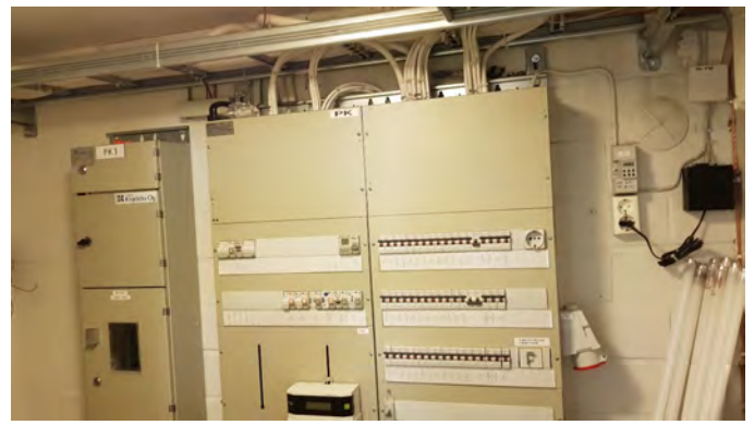
Kuva 30. Pääkeskus sijaitsee kellarikerroksessa. Asennuksissa ei havaittu poikkeavia huomioita.
