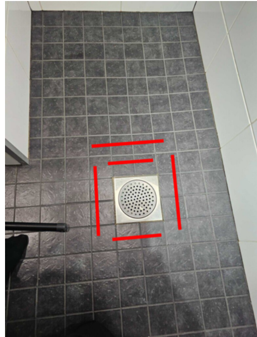
Kuva 8 Kostea alue lattiakaivon ympärillä.
