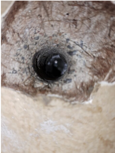
Valokuva rakenneavauskohdasta. Styroksin alapuolella olevan muovin päällä on vettä.
