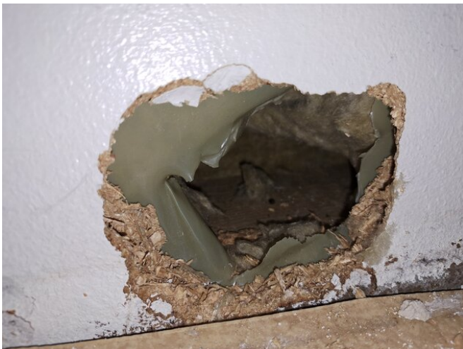
Ulkoseinän rakenneavaus. Lastulevy, eriste ja alajuoksu ovat märät.
