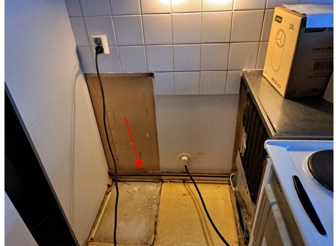
Vuotokohta merkitty nuolella. Vuotokohta on keittiössä liedен takana.
