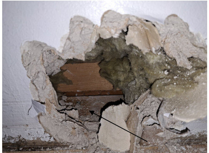
HVS- seinän rakenne. Ensimmäinen alajuoksu 50x70, sekä kipsilevyt 2 kpl että eriste ovat märkiä.
