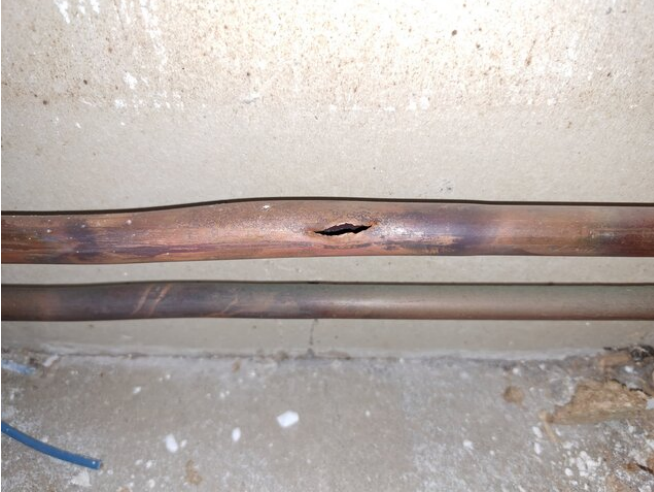
Kupariputken halkeama jäätyksen seurauksena. Putkenmuoto ja repeytymä ovat tyypillisiä jäätymisvahingossa.
