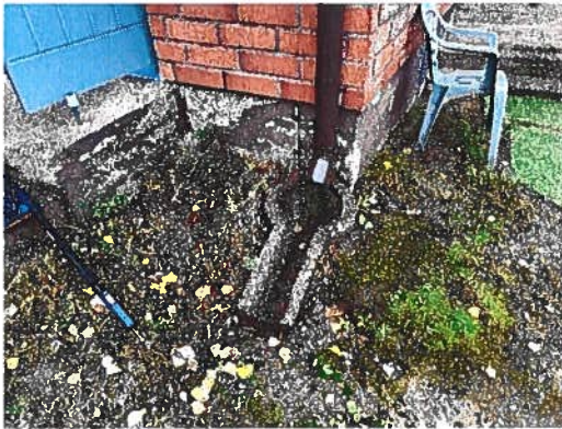
Syöksytorvien alla oli ainoastaan loiskekourut.
