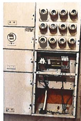
Jakokeskuksessa on kansi auki ja jännitteisiä osia näkyvillä.
