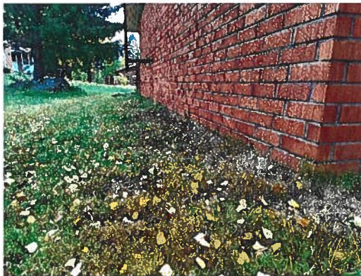
Sokkelikorkeus minimaalinen. Ulkoseinien kuntotutkimusta suositellaan.
