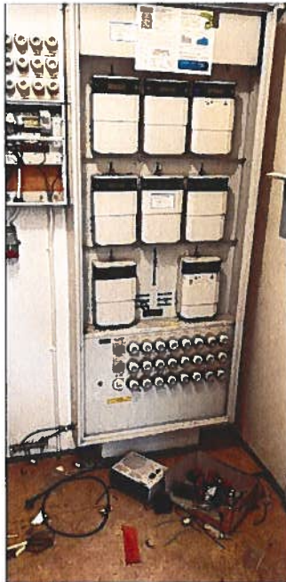
Sähköpääkeskustilassa olevat ylimääräiset tavarat poistettava ja tila siivottava.
