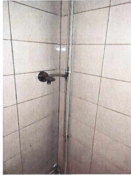
Komposiitilla uusittuja käyttövesijohtoja.
