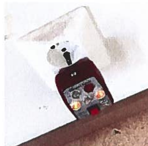
As2 Olohuoneessa maadoitettu pistorasia, jossa ei maadoitus toimi. Muut tilan pistorasiat maadoittamattomia. Korjattava ensi-tilassa määräysten mukaiseksi.
