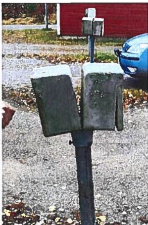
Autolämmitystolpat heikossa kunnossa
