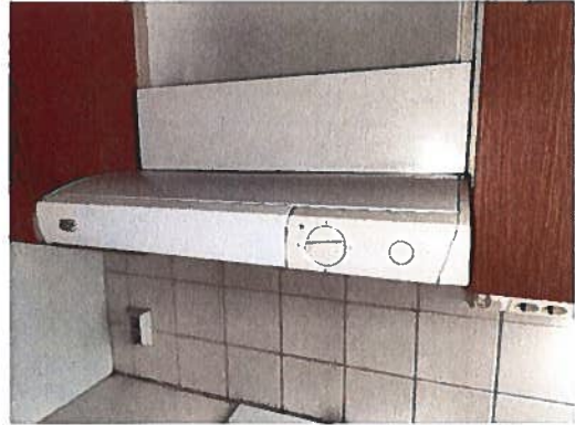
Liesituuletin omalla puhaltimella
