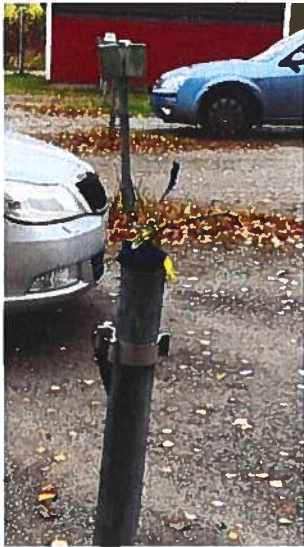
Käytöstä poistettuja lämmitystolppia, johdot valtoimenaan. Johtimissa ei havaittu tarkastelu- hetkellä jännitettä.
