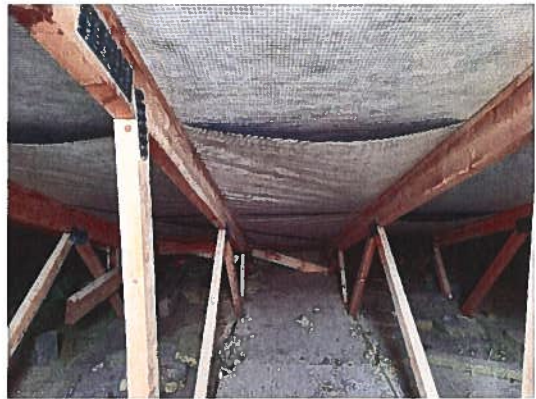
Tuulettuvuus ei toimi räystäälle.
