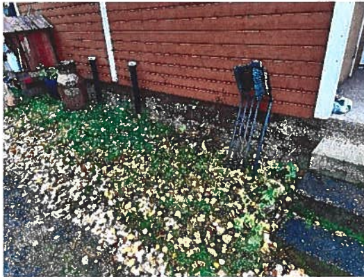
Sokkelipinnat kuluneet ja paikoin rapautuneet.
