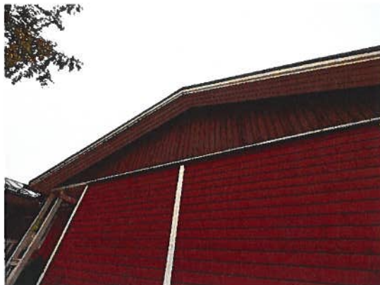
Päätykolmioiden huoltomaalausta suositellaan.
