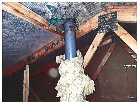
Putkieristeet puutteelliset. Lämpivientien ympärillä ei ole käytetty läpivientikappaleita.
