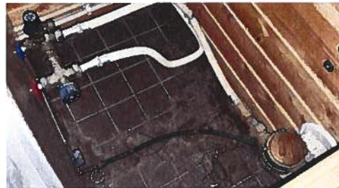
Sähkökäyttöiset lämminvesivaraajat on asennettu saunan lauteiden alle.
