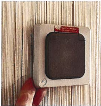
As 2. Kylpyhuoneen pistorasian kiinnitys huono.
