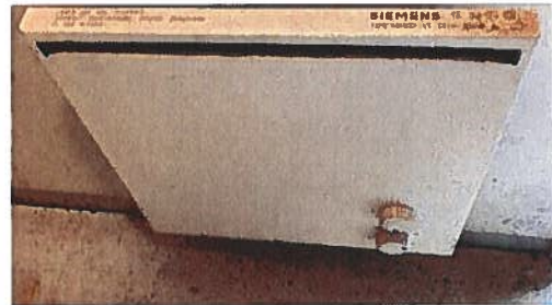
Sähkökeskuksen sähkölämmityspatteri on alkupeiräinen.
