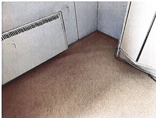
As 2 kuivan tilan lattiamatto in olohuoneen nurkasta irti.
