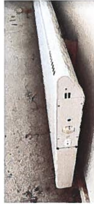
Sähkölämmityspatterit alkavat olemaan käyttöikänsä päässä.
