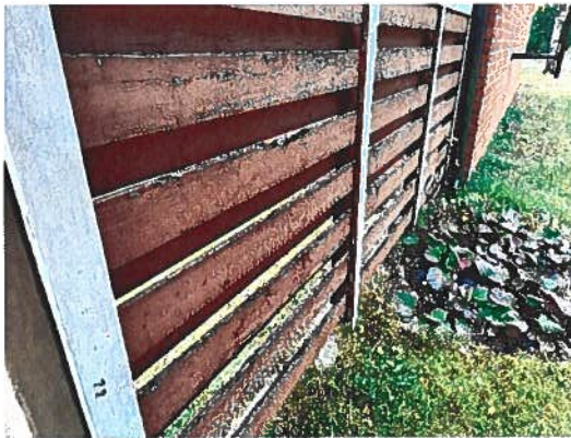
Aitojen puurakenteissa alkavaa lahovauriota.
