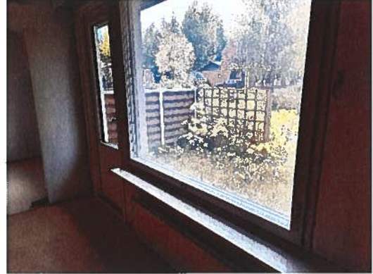
Ikkuna harmaantunut. Ikkunoiden puhdistus.
