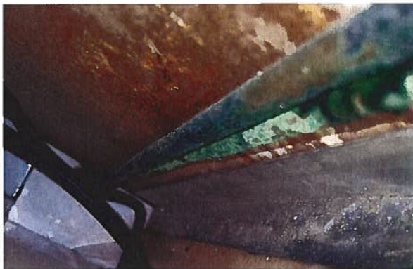
Hellan takana kulkevissa käyttövesijohdoissa korroosiota.
