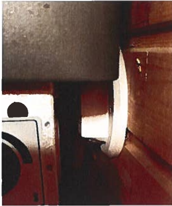
As 2. Saunan kiuas uusittu, mutta liitäntä rasia on liian lähellä kiuasta.
