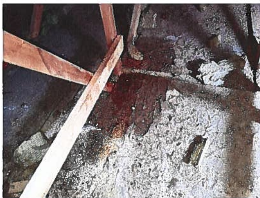
Kosteus/öljyjälkiä eristeissä. Jälki todennäköisesti vanha ajalta ennen vesikattosaneerausta.
