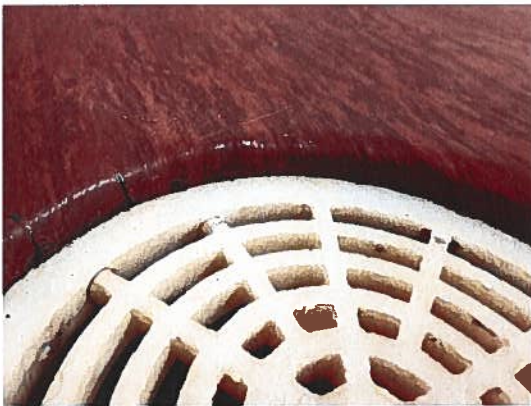
As 2 pesuhuoneen lattiamatto irti kaivolta. liitos epätiivis.
