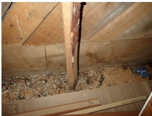
Kuva 10. Seinien paperoinneissa kosteusjälkiä.
