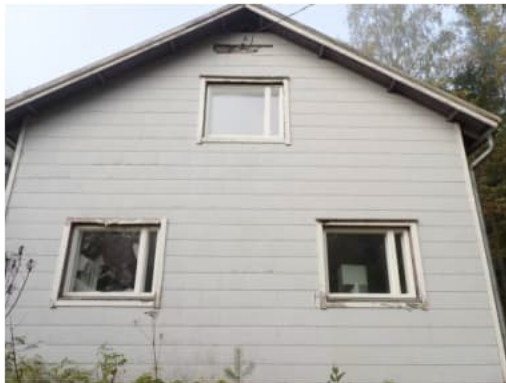
Kuva 34. Yläkerran ikkunoiden alla ei ole hätäpoistumistikkaita.
