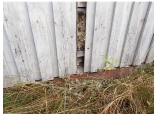
Kuva 15. Seinän lämmöneristettä näkyvillä puuttuvan laudoituksen kohdalla.
