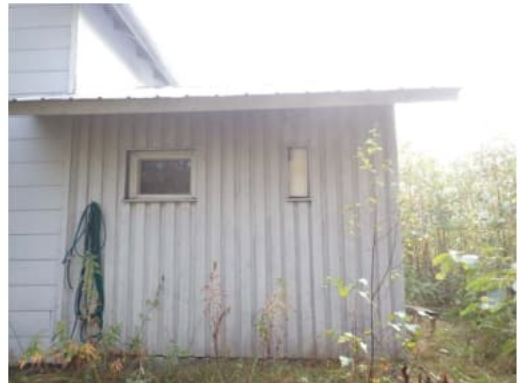
Kuva 24. Laajennusosalla ei ole sadevesijärjestelmää.
