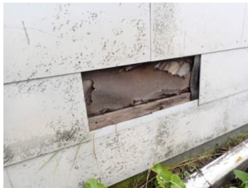
Kuva 14. Seinärakenne näkyvillä rikkoutuneen seinälevyn kohdalla.
