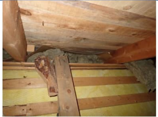
Kuva 9. Vinojen sisäkattojen yläpuolinen tuuletus puutteellinen.
