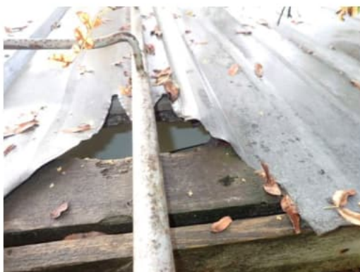
Kuva 21. Vesikatteesta irronnut pala.
