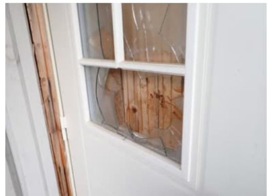
Kuva 18. Ulko-oven lasitus rikkoutunut.
