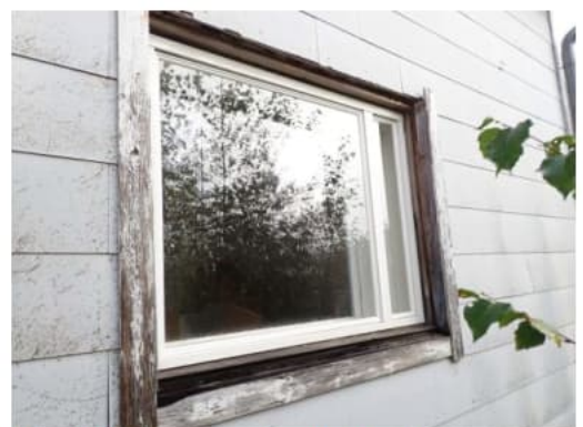
Kuva 20. Ikkunan vesipellityksiä ja peitelistoituksia puuttuu.
