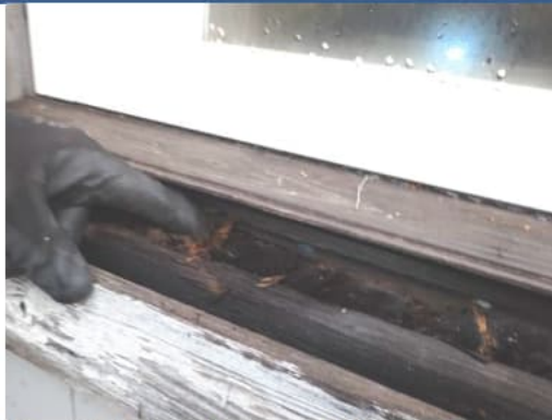
Kuva 16. Seinärakenteessa lahovaurioita ikkunan alla.
