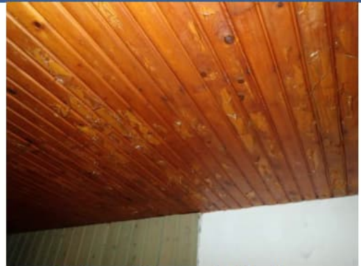
Kuva 41. Katon lakkapinnoite hilseilee.
