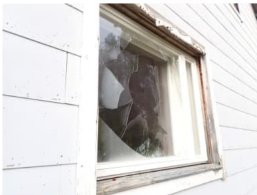
Kuva 19. Ikkunan lasitukset rikki.
