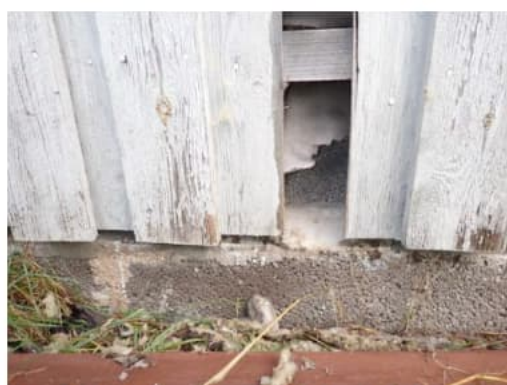
Kuva 4. Laajennusosan harkkosokkelia ei ole pinnoitettu.
