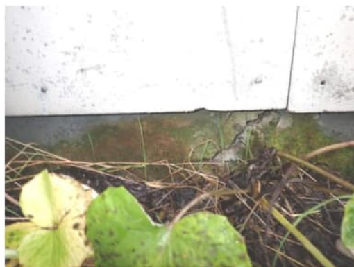
Kuva 3. Sokkelissa paikoin suuria halkeamia.
