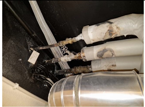
Kuva 2. Putkieristeet rikkoontuneet, eristeissä mahdollisesti asbestia.
