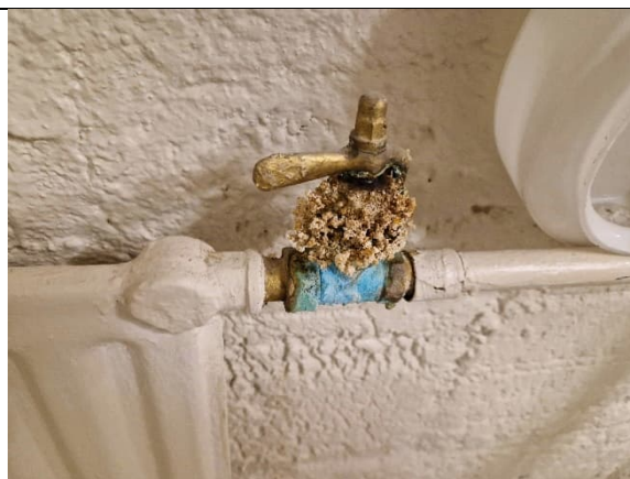
Kuva 8. Patterin käsisäästöventtiili. Voimakasta sinkkika-toa.
