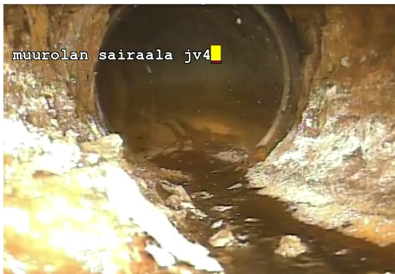
Kuva 3. Korroosiota sekä liitos muovista valuraudaksi.
