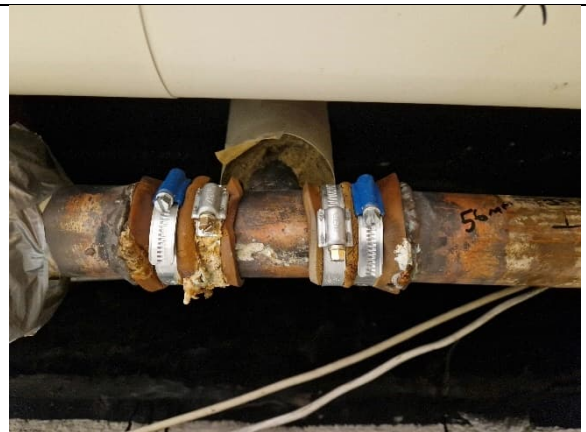
Kuva 4. Lämpimään käyttövesiputkeen tehty kumipaikkaus.
