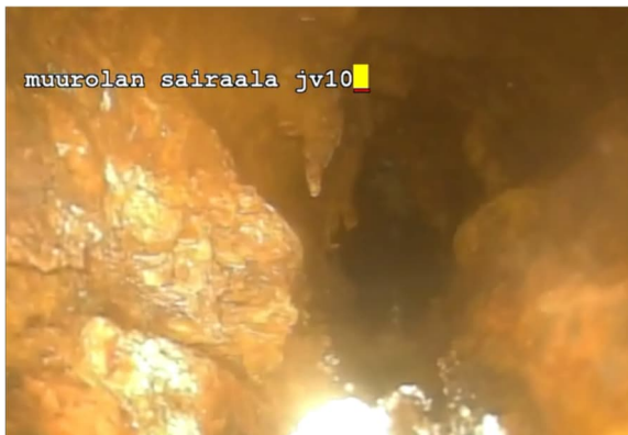
Kuva 7. Viemäriässä rasvanerotuskaivolta runsasta kovaa kertymää.
