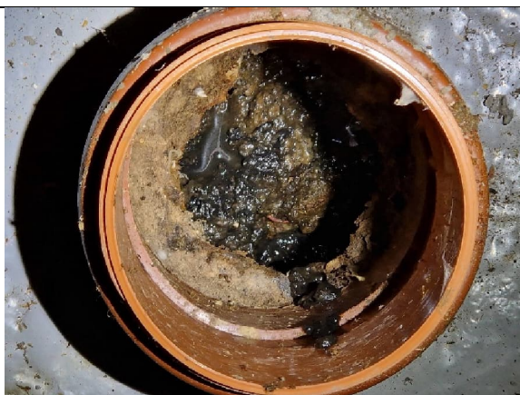
Kuva 7. Jätevesiviemärissä runsasta kertymää.
