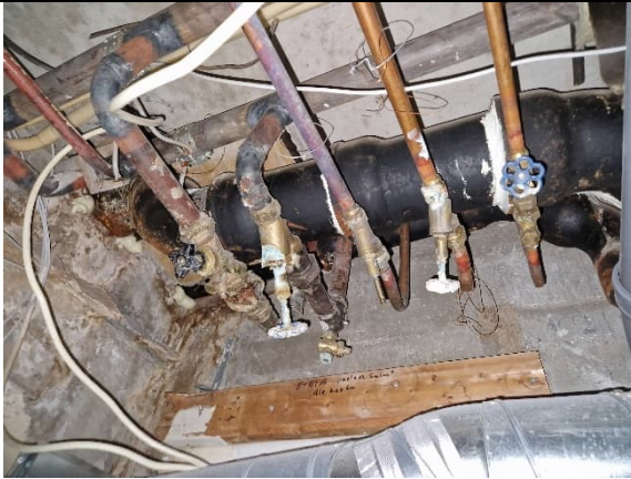
Kuva 1. Lämpöjohto- sekä käyttövesiventtiileitä joissa sinkkikatoa.
