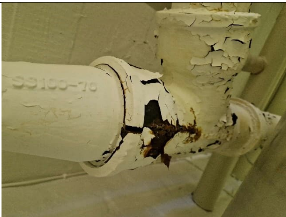
Kuva 3. Valurautaviemäri haljennut, vastaavia havaintoja useita.
