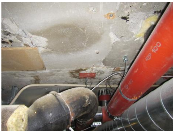
Kuva 114. B-osalla keittiötilan alapuolella vanhoja kosteusjälkiä.
