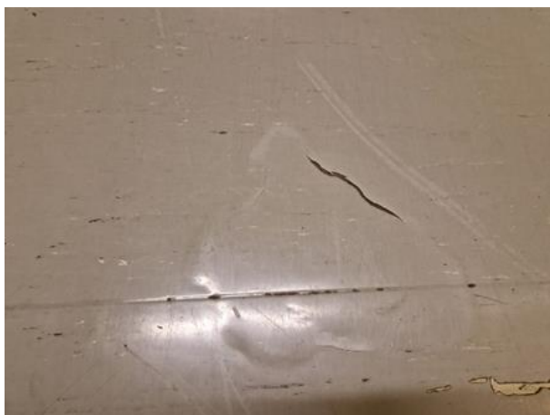
Kuva 118. C-osa, 4. kerros käytävä. Vanhempaa muovimattoja rikkoontunut.
