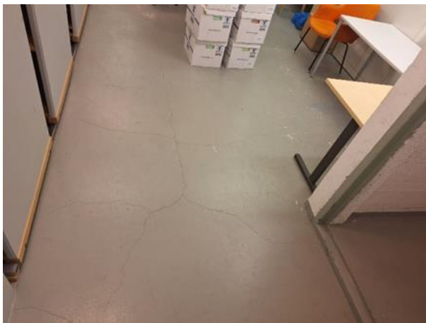
Kuva 8. Arkiston lattiassa halkeamia.
