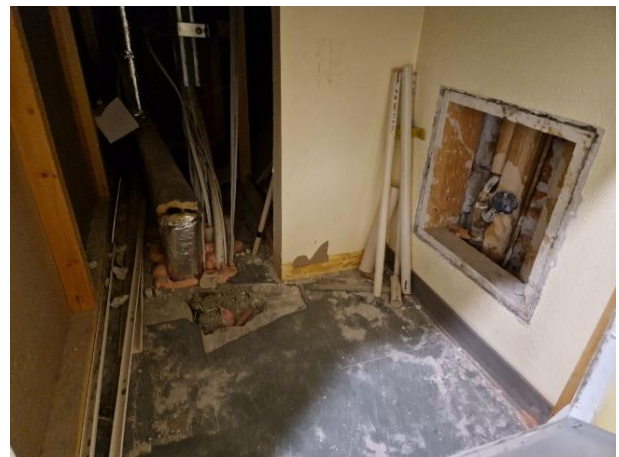
Kuva 105. B-osa 1066 aula. Tiivistämättömiä läpivientejä.
