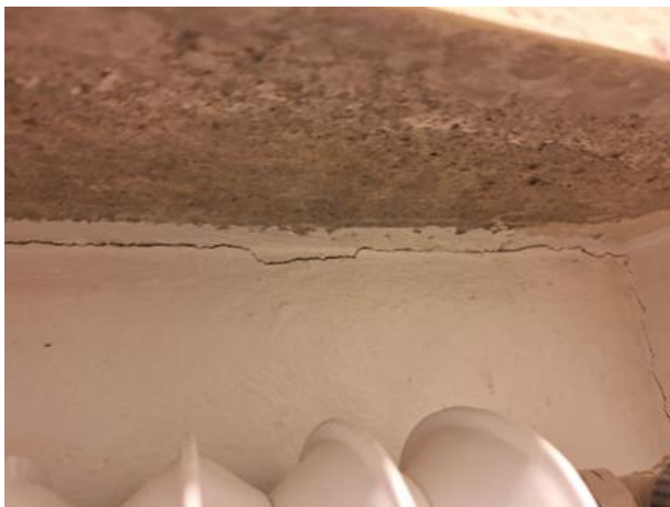
Kuva 93. Rakenneavaus RA51 patterisyvennykseen. Rakenteessa halkeilua.
