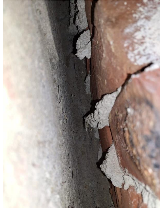
Kuva 90. Kuorimuurauksen takana ilmarako, betonin pinnassa rakenteen alaosalla jäämiä muottipuusta.
