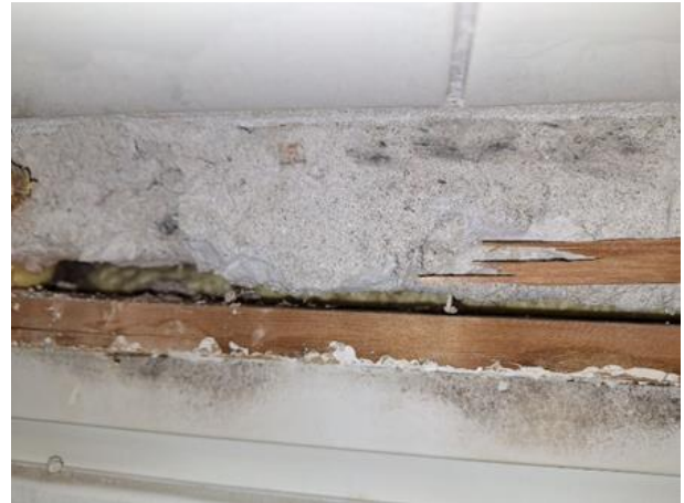
Kuva 85. RA41. Rakenteessa mahdollisesti mikrobikasvustoa.
