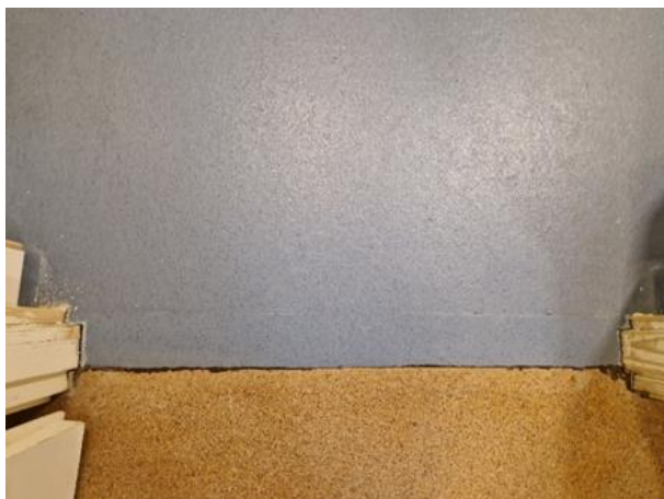
Kuva 112. C-osan 3. kerroksen puku- ja pesuhuonetilojen lattiapinnoitteiden rajapinnan tiiveys epävarma.
