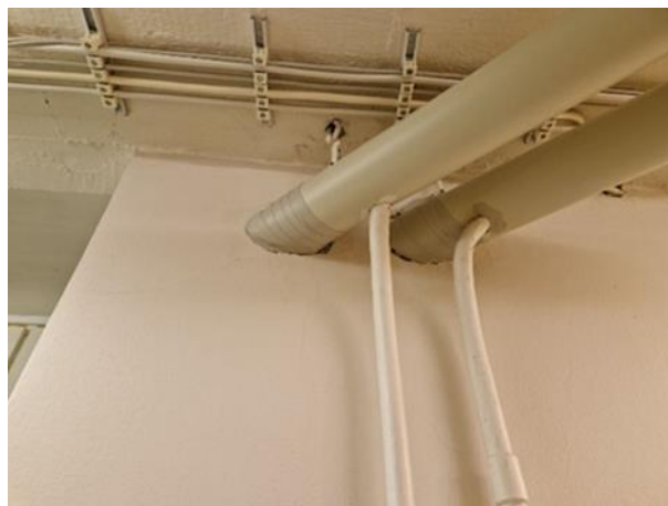
Kuva 45. C-osa, 049. Lämpöjohtojen tiivistämättömiä läpivientejä.
