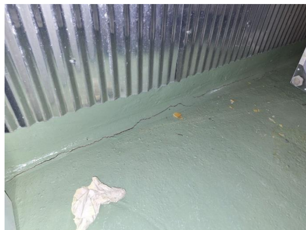
Kuva 17. Kylmätilan lattiassa halkeama.
