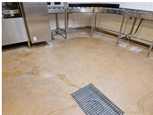
Kuva 111. B-osan keittiössä massapinnoite, monin paikoin halkeamia paikkakorjattu.
