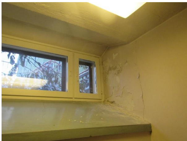
Kuva 42. B-osa, tila 049. Vanha kosteuden aiheuttama vaurio ikkunaliittymässä.
