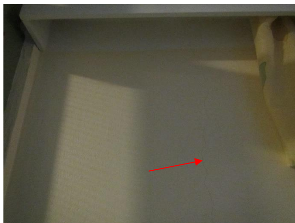
Kuva 103. B- ja C-osien rajalla halkeama.
