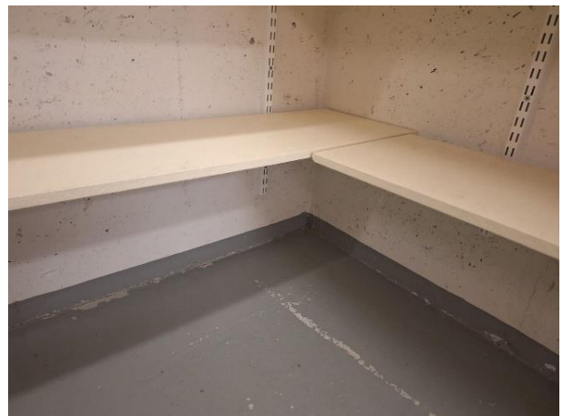
Kuva 9. Ulkoseinän liittymässä rako.
