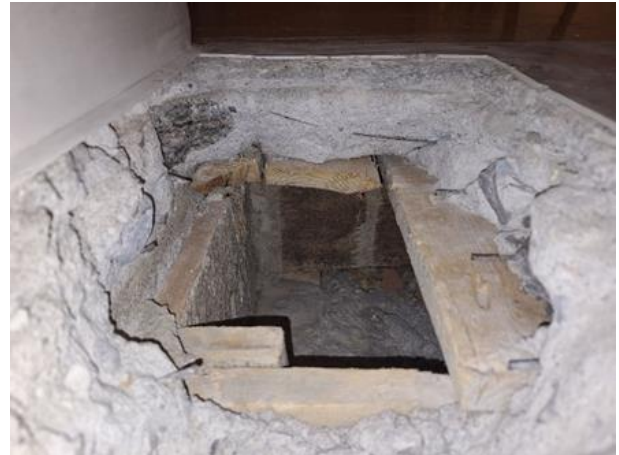
Kuva 146. Muottilaudoituksessa tummentumia ja vanhoja kosteusjälkiä.
