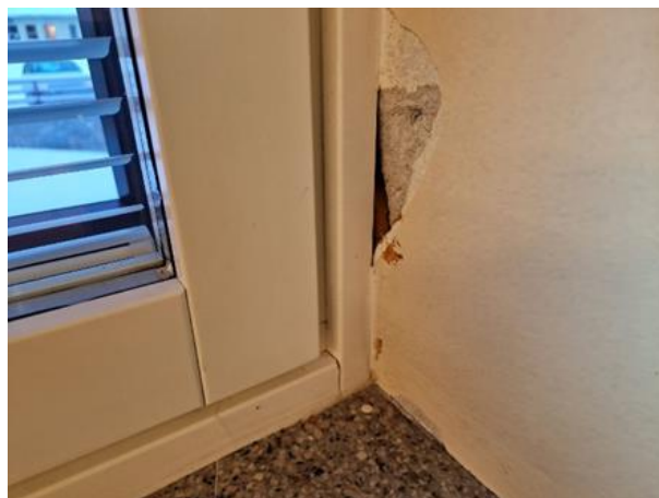
Kuva 66. B-osa, 1097. Ikkunaliittymässä lohkeama.
