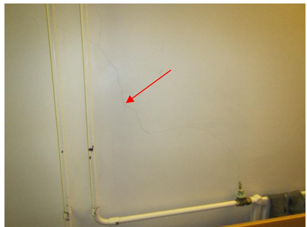
Kuva 43. B-osa, tila 049. Seinärakenteessa halkeama.
