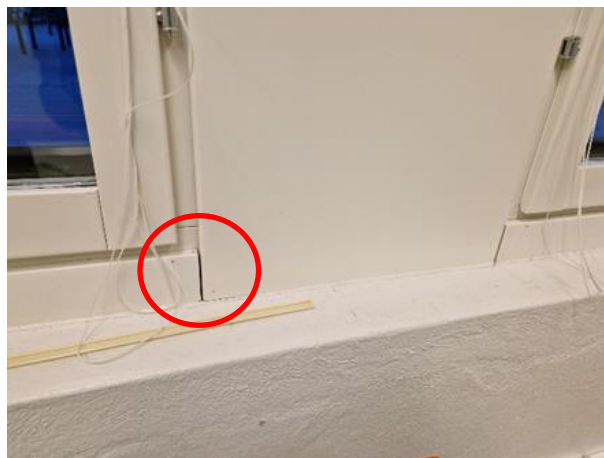
Kuva 64. Levyrakenteet eivät ole tiiviit.
