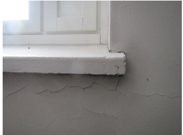
Kuva 49. D-osa, tila 041A. Ulkoseinärakenteessa halkeamia, ilmavuotoa rakenteesta.
