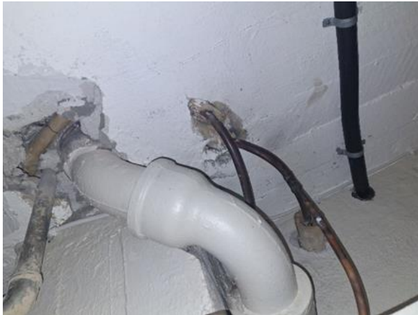
Kuva 106. B-osa, tila 050B. Nousuhormin lähtöä ei ole tiivistetty. Pahvieristeinen putki voi sisältää asbestia.
