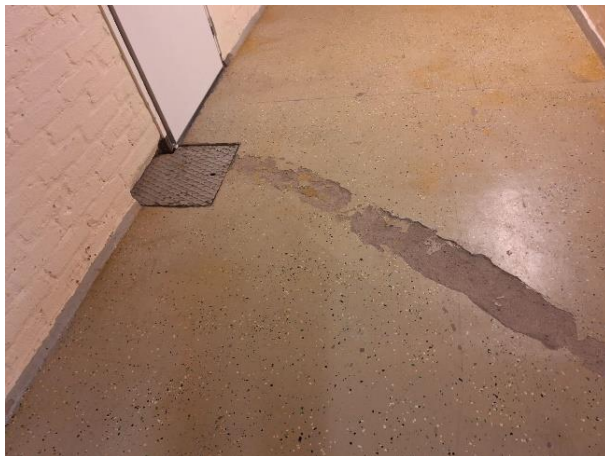
Kuva 12. Pinnoite vaurioitunut. Voi viitata kaivolle menevään roilotukseen.
