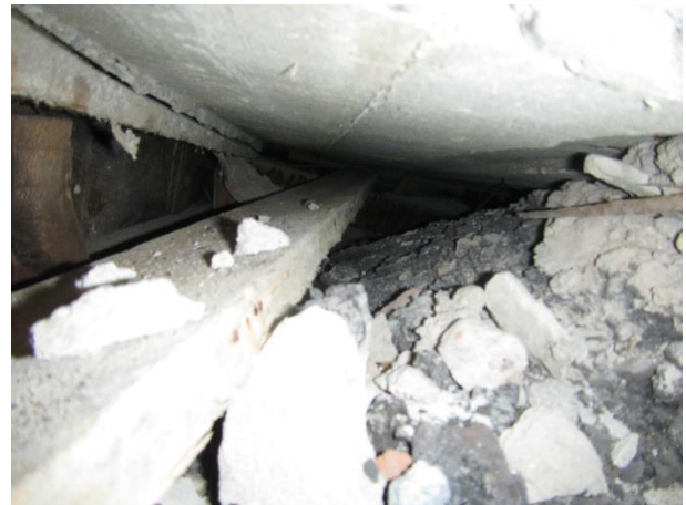
Kuva 130. Muottipuussa kosteusjälkiä ja tummentumia.
