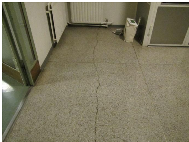
C-osalla 1. kerroksen porrastilan välipohjarakenteessa halkeamia
