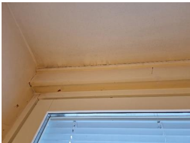
Kuva 65. B-osa, 1097. Ilmavuotoa ikkunaliittymästä, esimerkkikuva.
