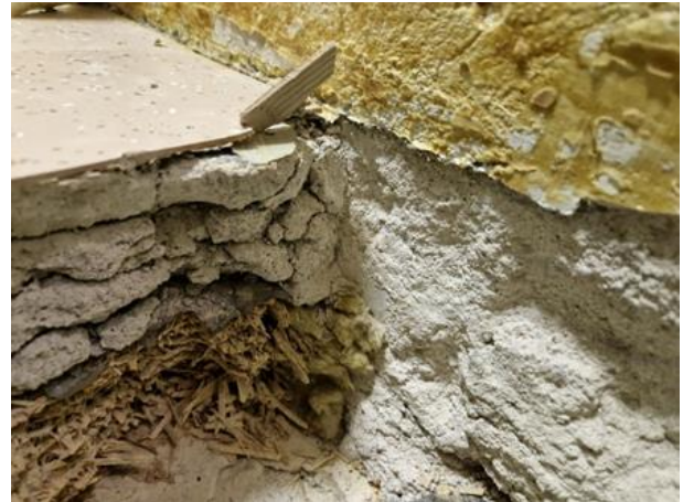
Kuva 125. Lattialiittymä suhteellisen tiivis.
