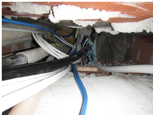
Kuva 113. C-osa, 1. kerros. Sähköasennuksien VP-läpiviennit avoimet.
