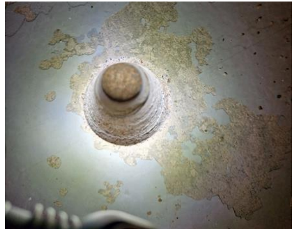
Kuva 29. Hiekkatäyttö kuivaa. Maalipinta hilseillyt.
