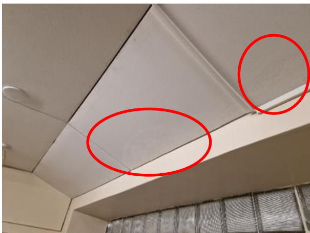
Kuva 165. B-osan 3. kerroksessa keittiön alueella yläpohjassa lastulevyrakennetta. Kosteuden aiheuttamaa kupruilua havaittavissa.
