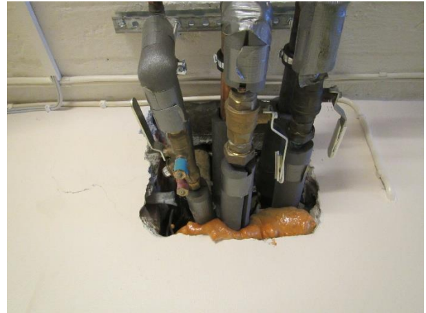
Kuva 107. C-osan kellarikerroksen käytävältä talotekniikan nousuja.
