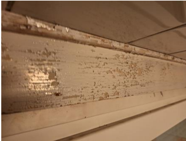
Kuva 84. Tila 1026. Maalipinta varistunut.
