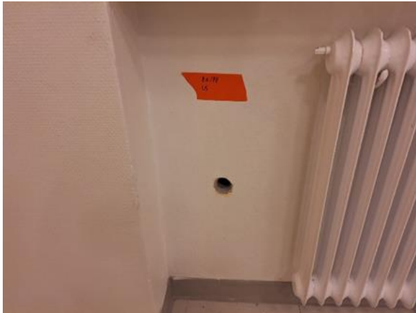
Kuva 91. Rakenneavaus RA51 patterisyvennykseen.
