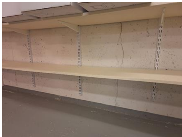
Kuva 101. B A-osan kellarikerroksessa väliseinärakenteessa halkeama.
