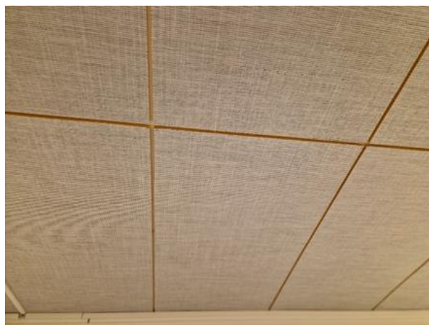
Kuva 123. Mineraalivillalevyissä reunat avoimet.
