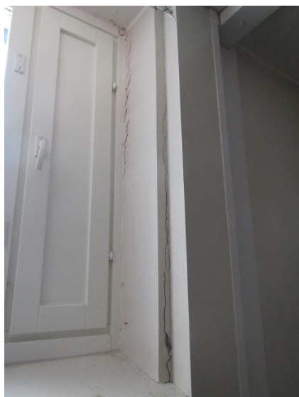
Kuva 46. D-osa, tila 041A. Ikkunaliittymässä halkeilua.
