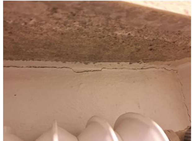
Kuva 68. D-osalla patterisyyvennyksissä halkeamia.
