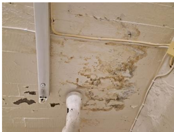
Kuva 115. B-osan tila 056A. Kosteusjälkiä välipohjarakenteessa.
