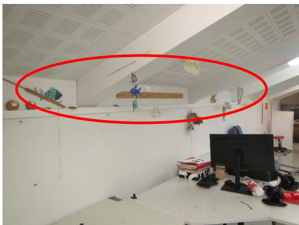
Kuva 7. D-osalla 4.kerrosen monitoimitila. Mikrobeihin viittaavaa hajua ullakotilaan rajoittuvan ulkoseinän kohdalla.
