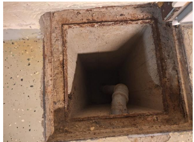
Kuva 13. Kts. kuva 12. Lattialuukku ei ole tiivis.
