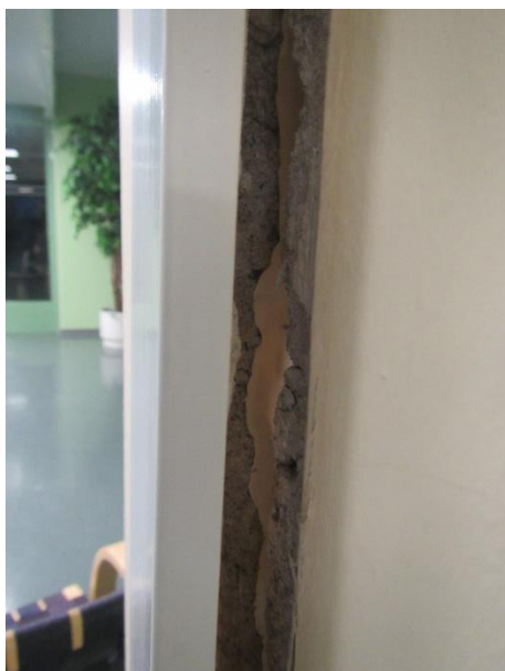
Kuva 102. A- ja B-osien rajalla väliseinärakenteessa massatiivistys.
