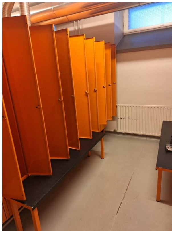
Kuva 19. Muovimaton sauma ratkennut, tila 060.
