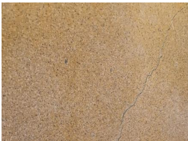
Kuva 110. B-osan keittiö. Massapinnoitteessa halkeama.
