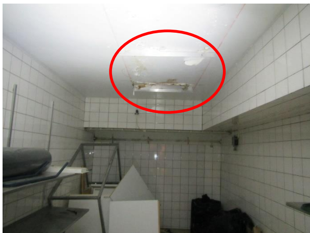
Kuva 5. B-osan kellarin varastotila 077, katossa vaurio.
