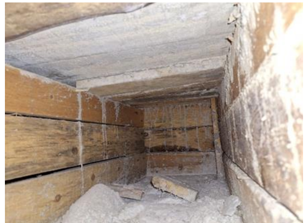
Kuva 158. Muottilaudoituksessa tummentumia ja vanhoja kosteusjälkiä.
