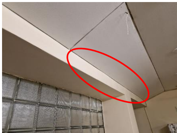
Kuva 166. Ulkoseinäliittymässä ilmavuotoihin viittaavaa tummentumaa.
