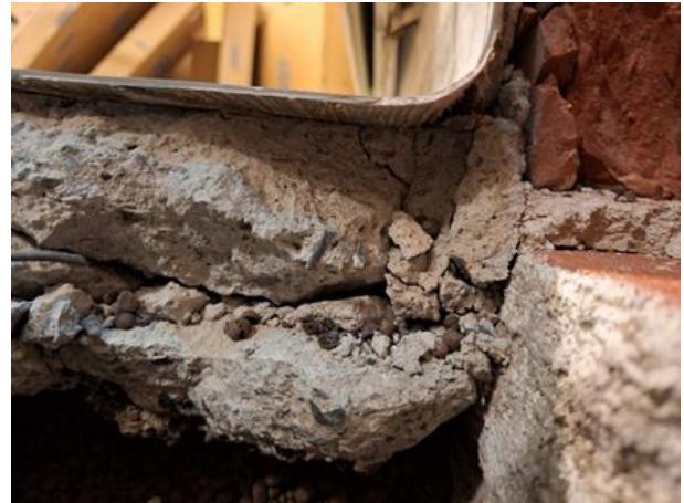
Kuva 41. Pintalaatan ja ulkoseinän liittymän tiiveys epävarma. Muovimatto on nostettu seinällä parantaen tiiveyttä.
