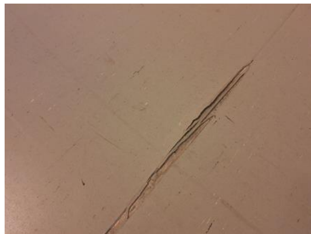
Kuva 21. Tila 002. Muovimaton sauma ratkennut.
