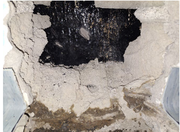
Kuva 10. B ja C osien kellarikerroksen alapohjarakenteen ja maanvaraisen ulkoseinärakenteen vedeneristepiki sisältää asbestia
