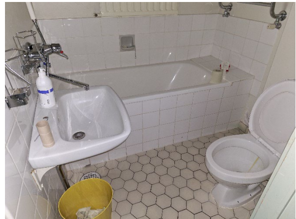
Kuva 8. WC ja pesutilojen seinän pyöreänurkkaisten keraamisten laattojen kiinnityslaasti sisältää asbestia (näyte 8).
