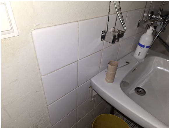
Kuva 7. WC ja pesutilojen seinän "pyöreänurkkaisten" keraamisten laattojen kiinnityslaasti sisältää asbestia (näyte 8).
