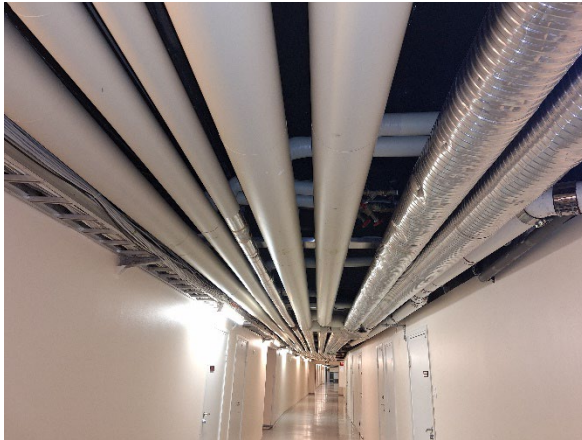
Kuva 1. Asbestipitoisella silotteella ja harsolla pinnoitettuja putkia kellarikäytävän katossa. Mutkissa asbestipitoinen massaeriste. Osa putkia uusittuja ja ulkoapäin pinnoitettuja.
