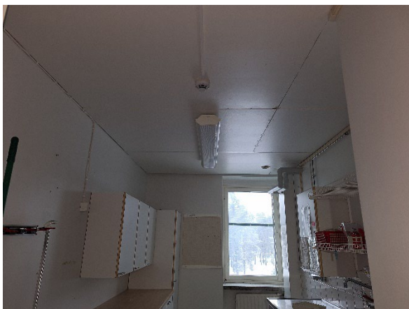
Kuva 13. Asbestipitoisia kuitusementtilevyjä C-osan tilan 4015 katossa.
