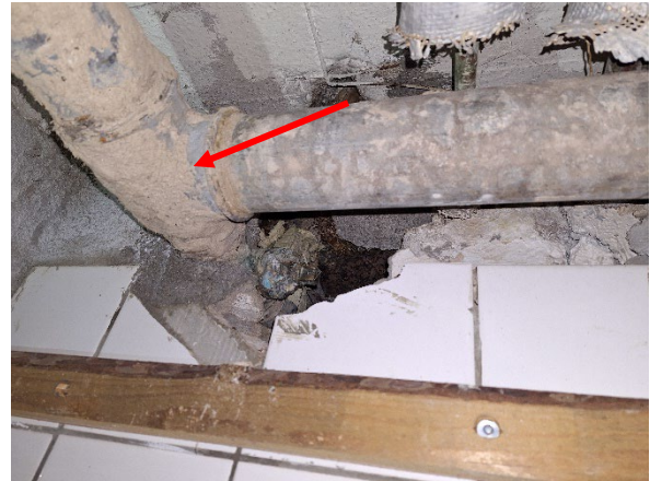
Kuva 2. Putkien pinnalle jäänyttä asbestieristettä tilassa A 071.
