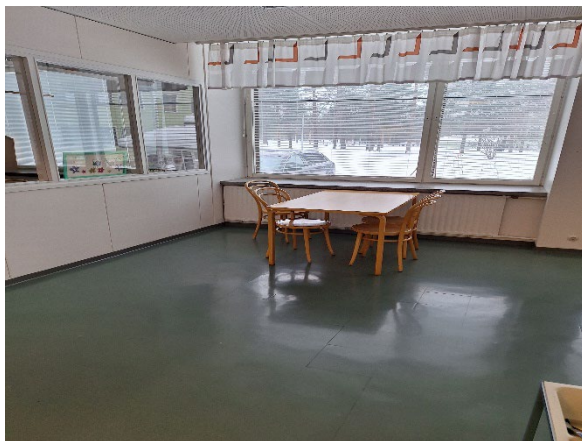
Kuva 5. Asbestipitoisia 250x250mm vinyylilaattoja yhteistilan lattiassa. Vinyylilaatat on kiinnitetty asbestipitoisella mustalla liimalla.
