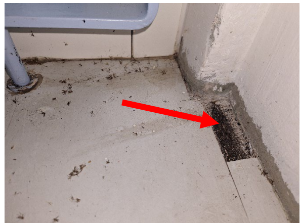
Kuva 6. Asbestipitoisia 250x250mm vinyylilaattoja porrashuoneen lattiassa. Vinyylilaatat on kiinnitetty asbestipitoisella mustalla liimalla (nuoli).
