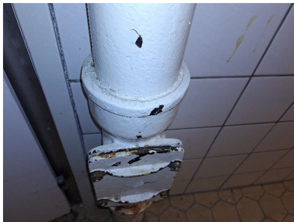
Kuva 22. Lyijypitoista tiivistettä kellarikäytävän pystyviemärin valurautaisessa muhviliitoksessa.
