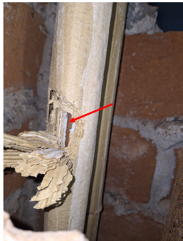
Kuva 4. Hormeissa ja koteloinneissa kulkevien putkien ympärillä on ohut asbestipitoinen eristekerros.
