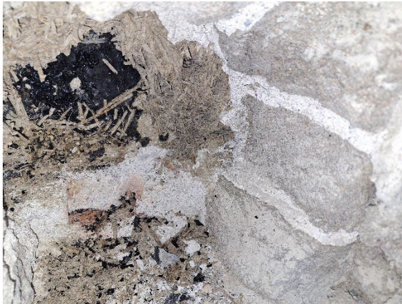
Kuva 9. B ja C osien kellarikerroksen alapohjarakenteen ja maanvaraisen ulkoseinärakenteen vedeneristepiki sisältää asbestia
