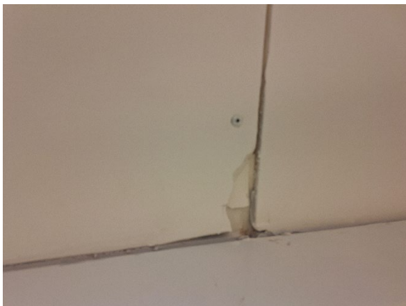
Kuva 11. B-osan käytävän 1066 sisäkattolevytys sisältää asbestia
