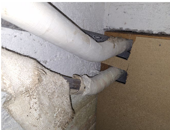
Kuva 3. Pinnoitevikaisia putkia tilassa D 043.
