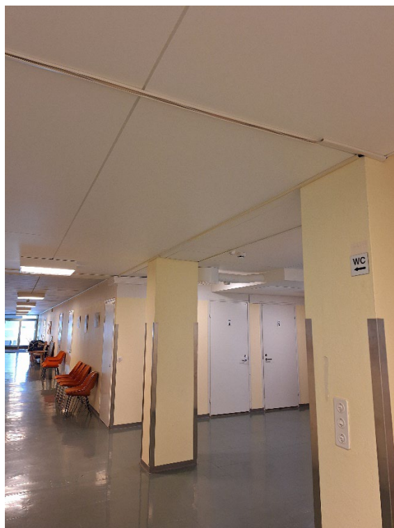
Kuva 12. B-osan käytävän 1066 sisäkattolevytys sisältää asbestia.
