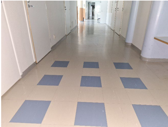
Kuva 19. Uusitut 300x300mm lattiavinyyliilaatat ja niiden kiinnityслиima eivät sisällä asbestia.
