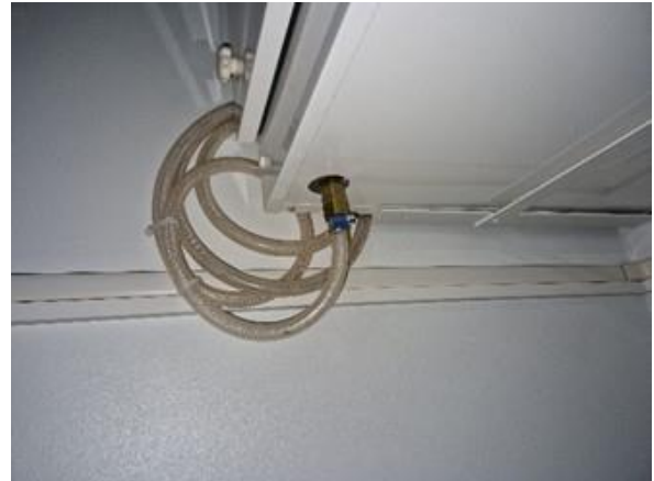
Kuva 16. ILTO 850 – kondenssiveden poistoletku on kierreteellä eikä selkeä varmuutta ole minne vesi ohjataan.
