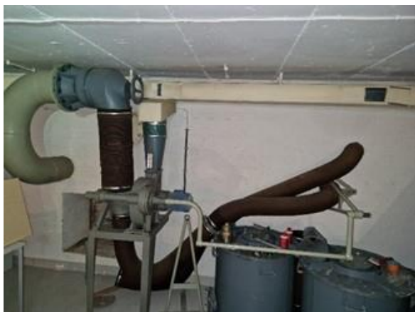
Kuva 17. Väestösuojan ilmanvaihtokone on alkuperäinen.
