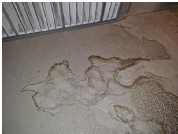
Kuva 13. TK1 TF01 – suodatinkammiossa kosteusjälkiä.
