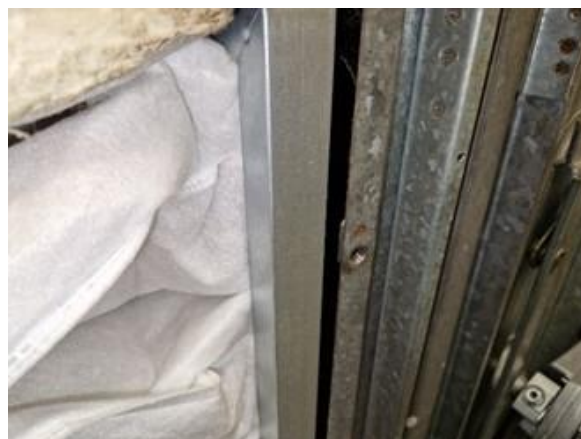
Kuva 14. TK1 TF01 – Raitisilmakammiossa siitepölyä.
