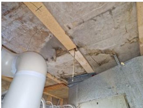
Kuva 5. TK03 – iv-konehuoneen rikki olevat kattoeristeet ovat mahdollisia kuitulähteitä. Eristeissä on myös vuotojälkiä.
