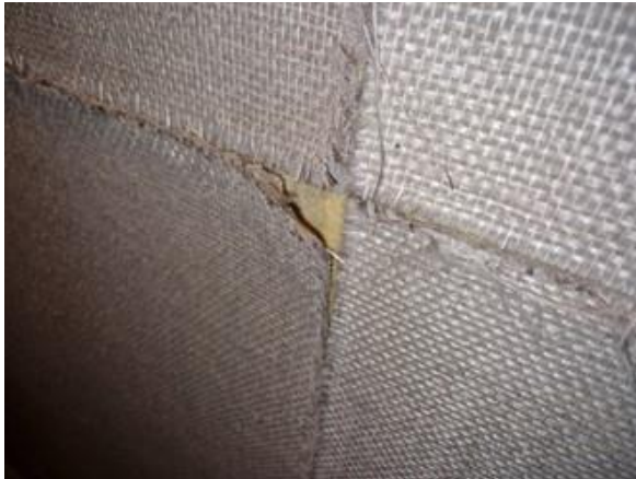
Kuva 15. PF01 – vaikka kyseessä poistoilmakone, niin rikki olevat kammioäänenvaimentimet ovat mahdollisia kuitulähteitä
