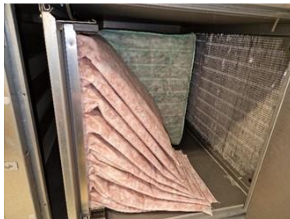
Kuva 10. TK06 PF01 – osa tuloilmakoneen suodattimista on asennettu vaakatasoon (makaavat toistensa päällä).
