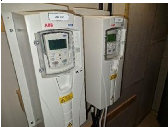
Kuva 7. TK04 ja TK05 – taajuusmuuttajat uusittu noin v. 2005
