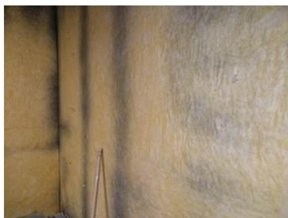
Kuva 8. TK04 ja TK05 – iv-konehuoneessa pinnoittamattomat seinäeristeet ovat mahdollisia kuitulähteitä.
