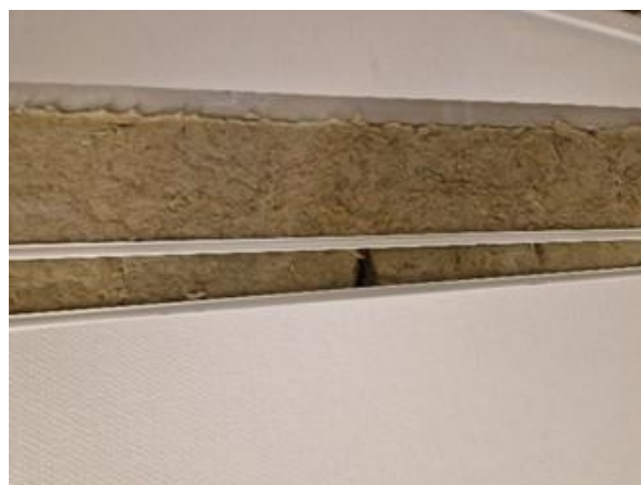
Kuva 22. Kattopaneelien äänenvaimentimena on käytetty pinnoittamatonta teollista mineraalivillaa, jotka toimivat mahdollisina kuitulähteinä.
