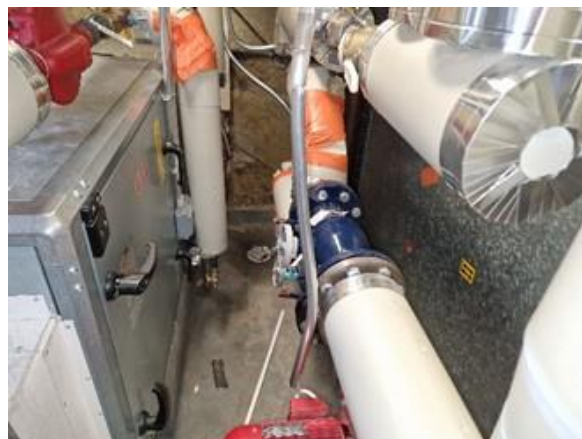
Kuva 6. TK-02 ja TK-03 - välillä kapea huoltoväli. Seinäeriste pinnoittamatta / rikki.
