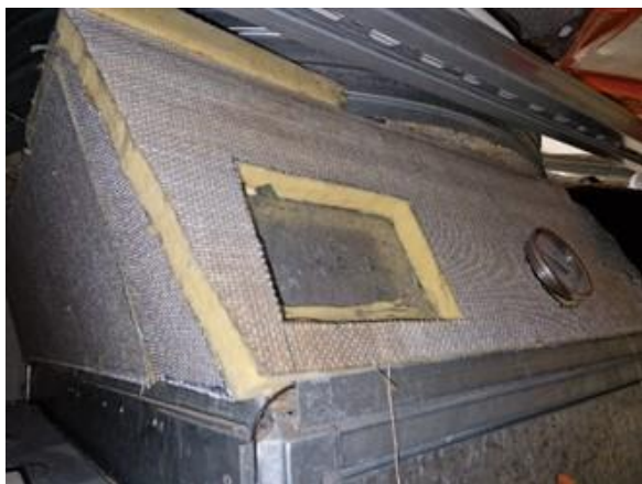
Kuva 9. TK05 – pinnoittamatta olevat ilmanvaihtokanavien eristeet ovat mahdollisia kuitulähteitä.
