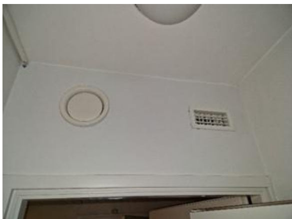
Kuva 19. Useassa tilassa päätelaitteet ovat asennettu samalle seinustalle.
