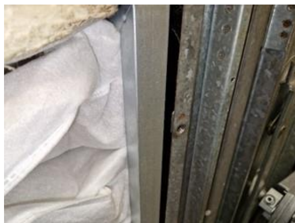
Kuva 2. TK01 -suodatinkehikko on epätiivis. Suodatinpussit vaaka-asennossa.
