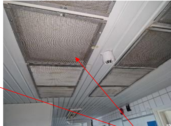
Kuva 24. Keittiössä mahdollisesti alkuperäiset huuvat.
