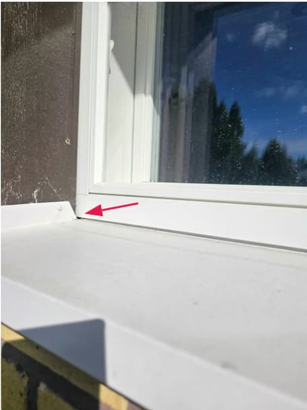
Uuden ikkunan ikkunapelti ei ole tiivis
