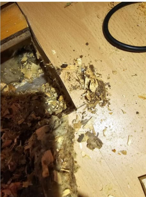
Kutterin lastuissa lahovaurioita ja mikroiperäinen hajupoikkeama
