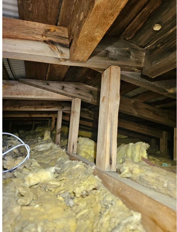
Kattorakenteissa tummentumaa, joka viittaa kosteuden tiivistymiseen rakenteiden pinnalle
