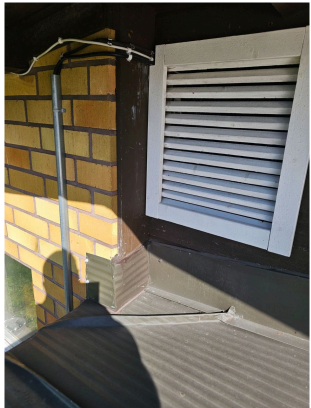
Toisessa päädyssä on reilun kokoinen tuuletusaukko, mutta tämä ei riitä koko yläpohjan tuulettamiseen
