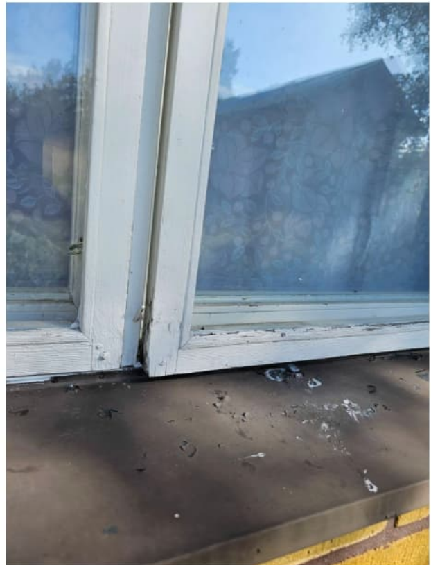
Alkuperäisen ikkunan maalipinta hilseillyt
