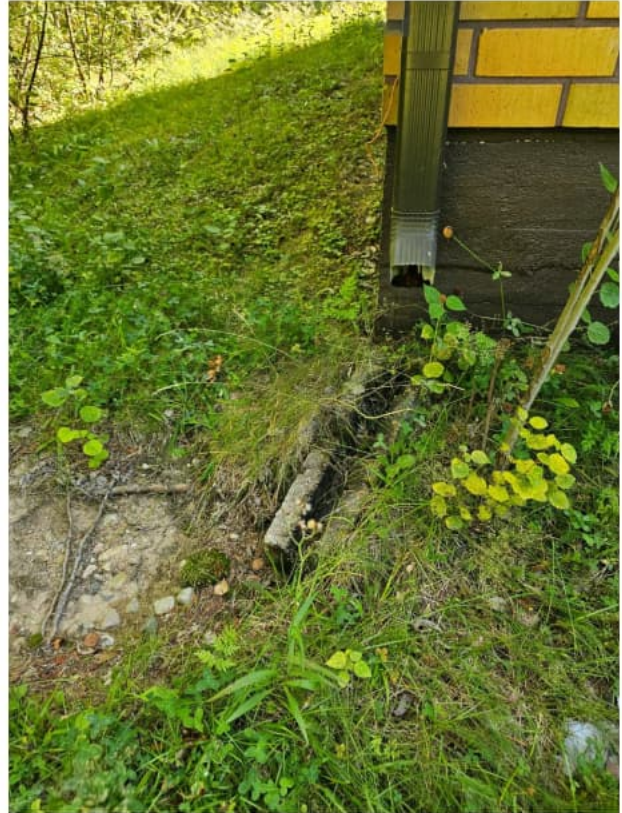
Rännivedet valuvat ja lammikoituvat nurkalle
