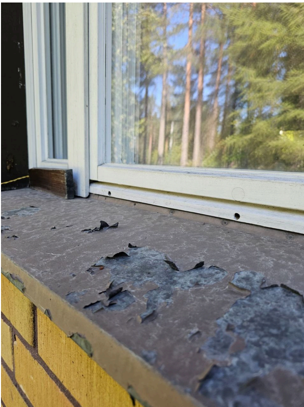
Ikkunapellin maalipinta hilseillyt
