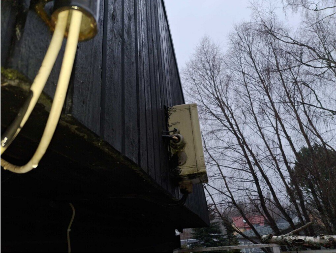
Kuva 77 Tarkastuksella avattiin sähkökaapelin läpiviennin vieressä oleva pääsulakekeskus, minkä sisällä oli vettä.
