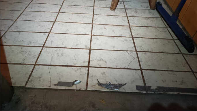
Kuva 21 Pesuhuone- ja saunatilat olivat ikääntyneet ja huonokuntoiset eikä tiloissa havaittu nykyaikaista vedeneristettä. Pesuhuoneessa osa seinä- ja lattialaatoista hajalla.
