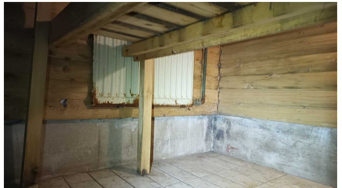
Kuva 28 Pesuhuoneen ja saunan vesikiertoiset lämmityspatterit ja paikoin lämpöjohdot ruostuneet ja huonokuntoiset.
