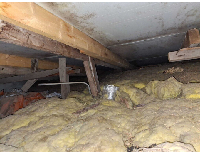
Kuva 71 Yläpohjatilaan on päätetty ilmanvaihtokanavia, joiden kohdalla vesikattorakenteet tummentuneet ilmankosteuden tiivistyttyä rakenteiden kylmälle pinnalle.
