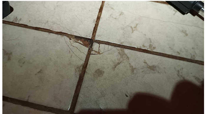
Kuva 24 Pesuhuone- ja saunatilat olivat ikääntyneet ja huonokuntoiset eikä tiloissa havaittu nykyaikaista vedeneristettä. Pesuhuoneessa osa seinä- ja lattialaatoista hajalla.
