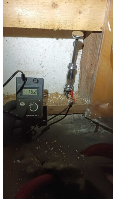
Kuva 10 Piikkimittarilla mitattuna maanvastaisten ulkoseinien puurakenteiden kosteus paikoin lievästi koholla.
