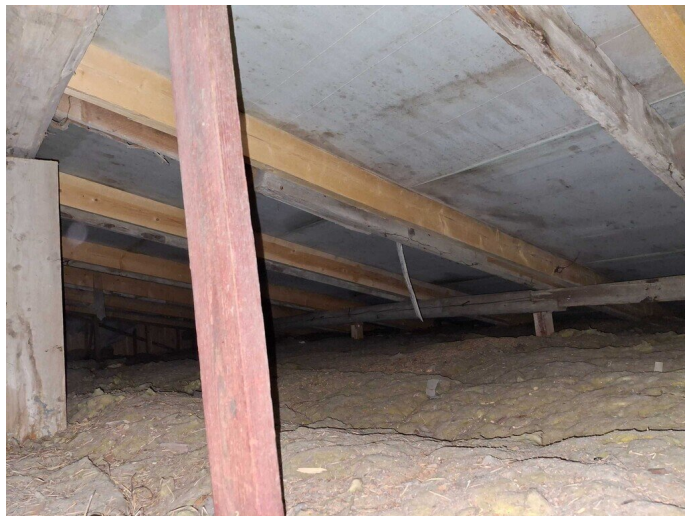
Kuva 74 Yläpohjan lämmöneristeenä mineraalivilla, joka oli silmämääräisesti tarkasteltuna kunnossa. Vesikattosaneerauksessa on uusittu/asennettu vesikaton aluskate. Aluskate on nykyaikainen alapinnastaan kondenssisuojattu muovialuskate. Aluskate on havaintojen mukaan viety sivuräystäslinjoilla yli ulkoseinälinjan.
