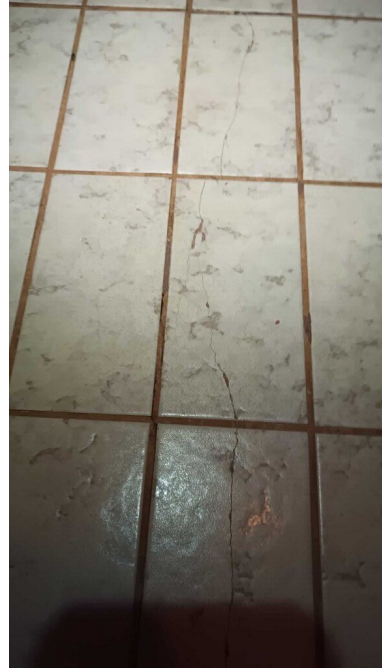
Kuva 22 Pesuhuone- ja saunatilat olivat ikääntyneet ja huonokuntoiset eikä tiloissa havaittu nykyaikaista vedeneristettä. Pesuhuoneessa osa seinä- ja lattialaatoista hajalla.
