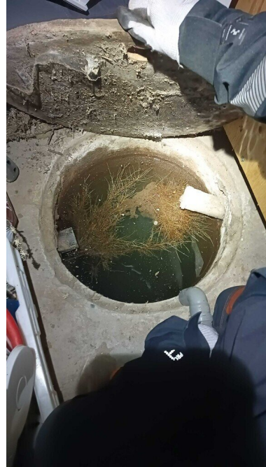
Kuva 34 Kellarin entisen autotallin lattiassa on betoninen jätevesikaivo, minkä purkupaikka ei tarkastuksella selvinnyt. Kaivossa havaittiin risurooskaa ja kaivon vedenpinta tarkastushetkellä melko korkealla.
