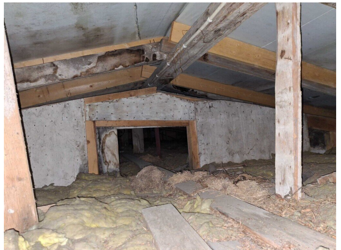
Kuva 68 Yläpohjatilan tuuletus puutteellinen ja yläpohjatilassa havaittiin tummentumaa ja mikrobiperäistä kasvustoa aluskatteen alapinnassa sekä vesikaton puurakenteissa. Yläpohjatilassa huoneistojen välinen palokatko-osastointi puutteellinen.
