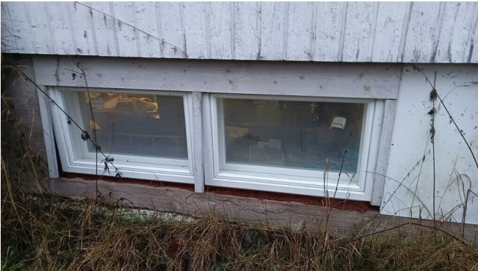
Kuva 51 Osassa kellarin ikkunoiden vesipellitykset ja ulkokuorilaudoitukset puuttuvat.
