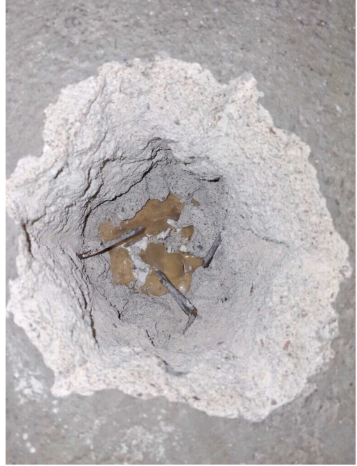
Kuva 4 Kellarin alapohjan maanvaraisen betonilaatan alapuolella oli muovikalvo estämässä maaperän kapillaarista kosteuden nousua siirtymästä alapohjan betonilaattaan. Alapohjalaatan alla oli ohut solumuovieriste, minkä alapuolella hiekkaa/savea. Maanvaraisen betonilaatan rakenneavauskohdassa, alapohjan hiekka-/savitäyttöön kertyi vettä hetki rakenneavauksen tekemisen jälkeen.
