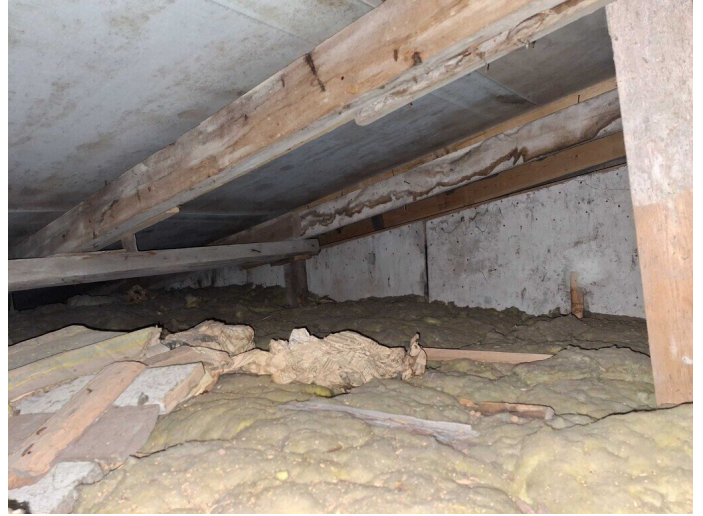
Kuva 70 Yläpohjatilassa havaittiin vanhojen kattovuotojen aiheuttamia kosteusjälkiä sekä tummentumaa vesikaton puurakenteissa.
