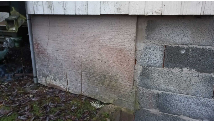
Kuva 39 Havaintojen perusteella perusmuurien patolevyt puuttuvat. Perusmuureja vasten havaittiin paikoin solumuovieriste eli styroksi.
