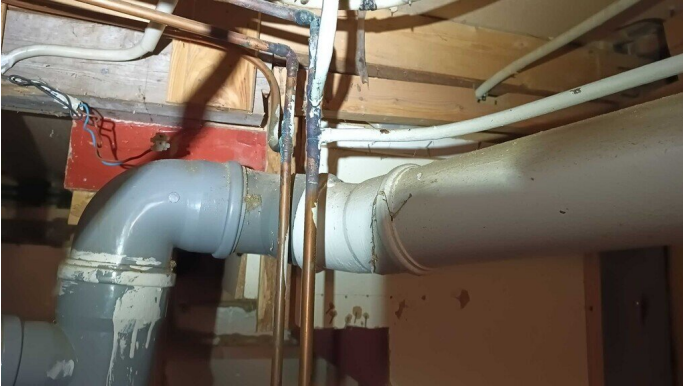
Kuva 33 Kellarissa yläpuolisesta wc-tilasta tulevassa muoviviemäriputkessa havaittiin tiivistetty/korjattu paikkaus putken näkyvällä pystyosuudella. WC-istuimelta pystyviemäriin laskevassa viemäriputkessa oli kallistuspuute putkien muhviilitoksen kohdalla.
