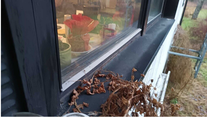
Kuva 53 Asuinkerroksen puuikkunat ikääntyneet ja kuluneet. Ikkunoiden puuosissa laajalti säärasituksen ja ikääntymisen aiheuttamaa halkeilua.
