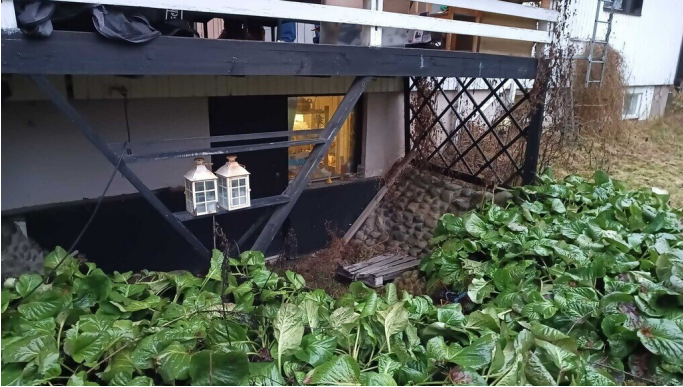
Kuva 37 Maanpinta rakennuksen vierustalla melko tasainen ja maanpinnan kallistus rakennuksesta poispäin puutteellinen.
