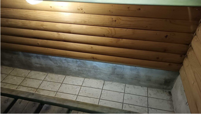
Kuva 31 Saunan seinien ylösnostot rapatut kiviainespinnaiset ja rakennuksen ulkokulmassa seinän ylösnosto tummunut ulkopuolisesta kosteusrasituksesta. Saunan seinien ylösnostojen kosteus oli pintakosteudenosoittimella tarkasteltuna koholla. Saunan seinäpaneloinnin taustalla ei ole riittävää tuuletusrakoa.
