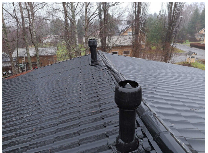
Kuva 64 Vesikaton tehdasvalmisteiset LVI-läpivientippiput ehjät ja kunnossa.
