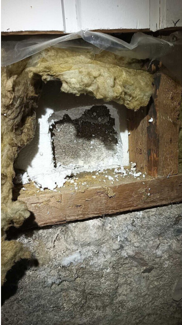
Kuva 9 Puurungon ja betonirakenteen välissä ei ollut kapillaarikatkokaistaa. Päädyn pystypuurunko erotettu maanvastaisesta ulkoseinäperusmuurista 50 mm paksulla solumuovieristeellä. Tarkastetuilta osin maanvastaisten ulkoseinien puurakenteissa ei havaittu lahovaurioita.
