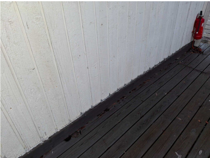
Kuva 47 Julkisivujen lautaverhous on likaantunut ja lautaverhouksessa havaittiin kulumaa ja lahovaurioita pystyverhouksen jatkoskohdissa. Lautaverhouksen maalipinnoite kulunut ja verhouksen kiinnitysnaulat paikoin ruostuneet.
