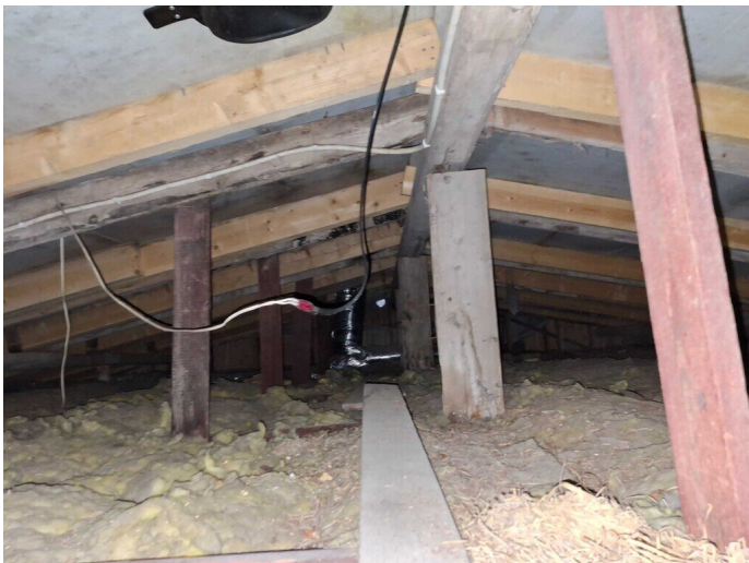
Kuva 73 Vesikaton kantavien puurakenteiden tuenta yläpohjatilassa puutteellinen. Yläpohjan lämmöneristeenä mineraalivilla, joka oli silmämääräisesti tarkasteltuna kunnossa.
