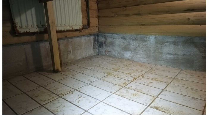
Kuva 30 Saunan seinien ylösnostot rapatut kiviainespinnaiset ja rakennuksen ulkokulmassa seinän ylösnosto tummunut ulkopuolisesta kosteusrasituksesta. Saunan seinien ylösnostojen kosteus oli pintakosteudenosoittimella tarkasteltuna koholla. Saunan seinäpaneloinnin taustalla ei ole riittävää tuuletusrakoa.
