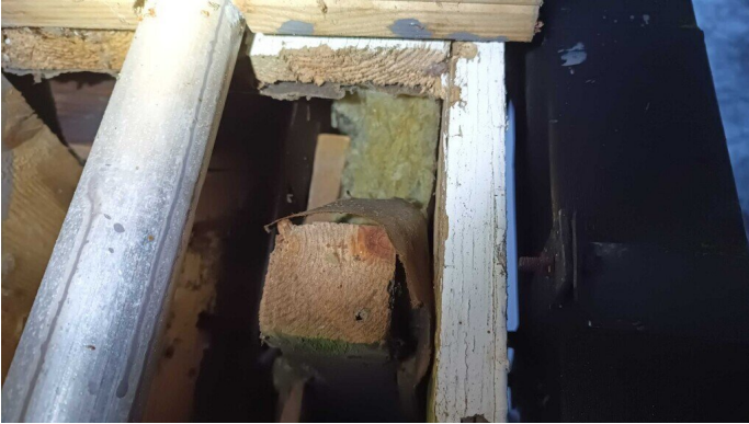
Kuva 49 Julkisivujen lautaverhouksen taustalla ei havaittu tuuletusväliä ja ulkoseinien lautaverhous on asennettu päin seinien mineraalivilla-lisäeristystä.
