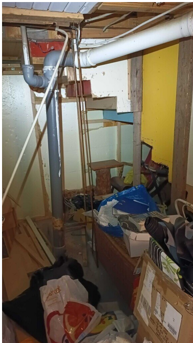
Kuva 35 Kellarissa kulkevien kuparisten käyttövesiputkien kannakointi on puutteellinen.
