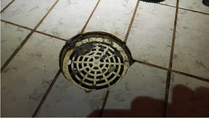
Kuva 25 Pesuhuoneen lattiakaivon ritiläkantta ei saatu poistettua lattialaatoituksen takia.
