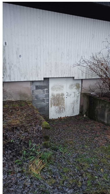
Kuva 56 Kellarin ulko-ovet huonokuntoiset. Ulko-ovet kastuneet ja vaurioituneet ulkopuolisesta kosteudesta johtuen.
