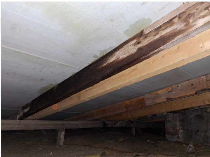
Kuva 75 Yläpohjatilassa havaittiin vanhojen kattovuotojen aiheuttamia kosteusjälkiä sekä tummentumaa vesikaton puurakenteissa.
