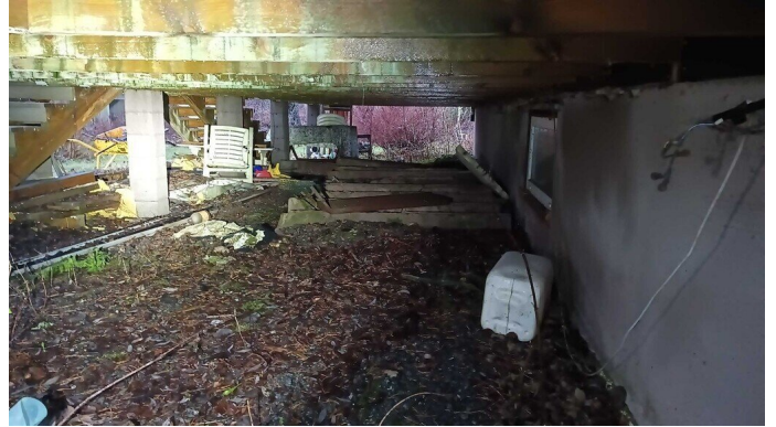
Kuva 58 Huoneiston 2 sisäänkäyntiterassin puurakenteissa säärasituksen ja ikääntymisen aiheuttamaa kulumaa ja halkeilua.
