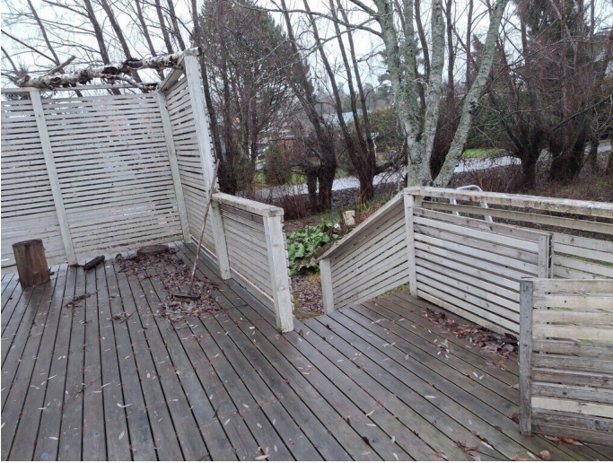
Kuva 57 Huoneiston 2 sisäänkäyntiterassin puurakenteissa säärasituksen ja ikääntymisen aiheuttamaa kulumaa ja halkeilua.
