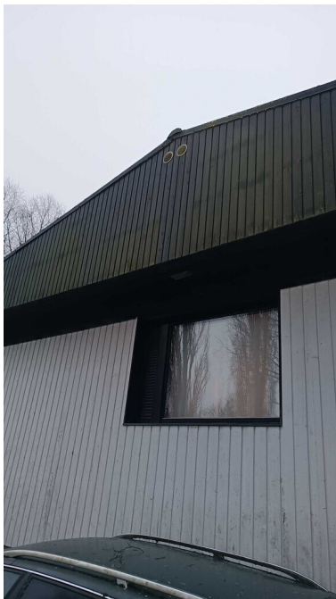
Kuva 67 Päättyräystäään otsapintalaudoituksessa sammalkasvustoa.
