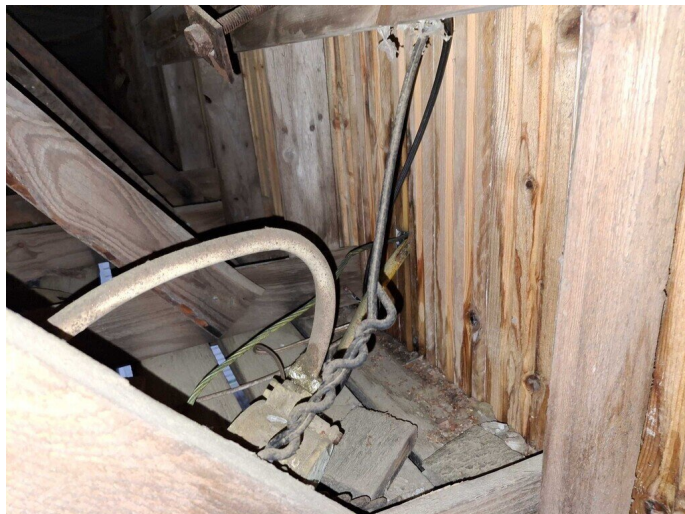
Kuva 76 Päätyräystään otsapinnan sähkökaapelin läpivienti epätiivis ja läpiviennin kautta, kaapeleita pitkin on kulkeutunut vettä päätyräystään sisäpuolelle.
