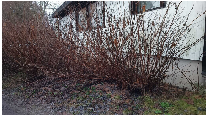
Kuva 36 Rakennuksen vierustalla on paikoin perustusten kosteusrasitusta lisääviä istutuksia ja kasvillisuutta.
