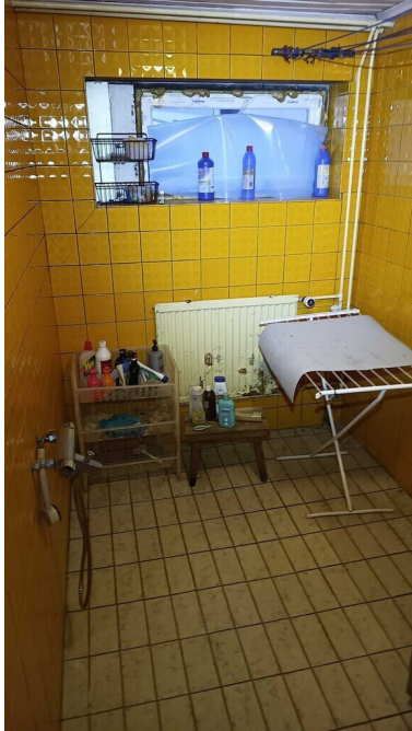
Kuva 19 Pesuhuoneen ja saunan lattiaa tarkasteltiin pintakosteudenosoittimella ja pintakosteuslukemat osoittivat märkää noin 130...145 Gann koko lattian alueella. Pesutilojen lattiassa on havaintojen mukaan vesikiertoinen lattialämmitys eikä tarkastuksella saatu varmuutta, onko pesutilojen maanvarainen alapohjarakenne kauttaaltaan märkä vai onko alapohjan rakennekerroksissa mahdollisesti käytetty esim. alumiinipintaista eristettä tai muuta rakennekerrosta, minkä takia pintakosteusosoittimen ilmoittamat tulokset olivat koholla. Pesuhuoneen seinien alaosien kosteus oli pintakosteudenosoittimella tarkasteltuna koholla.
