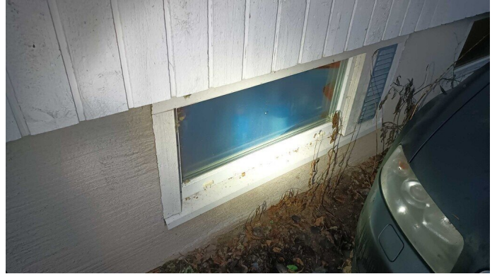
Kuva 50 Kellarikerroksen uusitut umpiolasielementti-ikkunat ehjät ja kunnossa. Osassa kellarin ikkunoiden vesipellitykset ja ulkokuorilaudoitukset puuttuvat.
