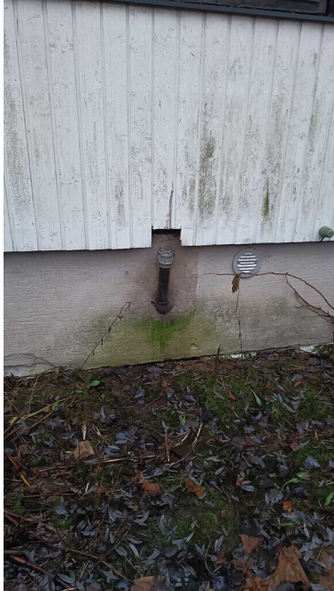
Kuva 41 Sokkelien vierustan karkeasta kiviaineksesta tehty sokkelinvierustäyttö puuttuu ja sokkeleita vasten havaintojen perusteella hienoainesta sisältävä multa-/humusmaa. Rapatussa sokkelissa havaittiin sade- ja sulamisvesistä ja maaperäkosteudesta johtuvaa sokkelipinnoitteen halkeilua ja kosteusjälkiä sekä sammaloitumista.
