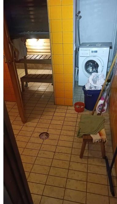
Kuva 18 Pesuhuoneen ja saunan lattiaa tarkasteltiin pintakosteudenosoittimella ja pintakosteuslukemat osoittivat märkää noin 130...145 Gann koko lattian alueella. Pesutilojen lattiassa on havaintojen mukaan vesikiertoinen lattialämmitys eikä tarkastuksella saatu varmuutta, onko pesutilojen maanvarainen alapohjarakenne kauttaaltaan märkä vai onko alapohjan rakennekerroksissa mahdollisesti käytetty esim. alumiinipintaista eristettä tai muuta rakennekerrosta, minkä takia pintakosteusosoittimen ilmoittamat tulokset olivat koholla.
