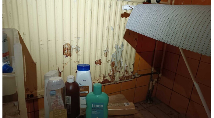
Kuva 26 Pesuhuoneen ja saunan vesikiertoiset lämmityspatterit ja paikoin lämpöjohdot ruostuneet ja huonokuntoiset.
