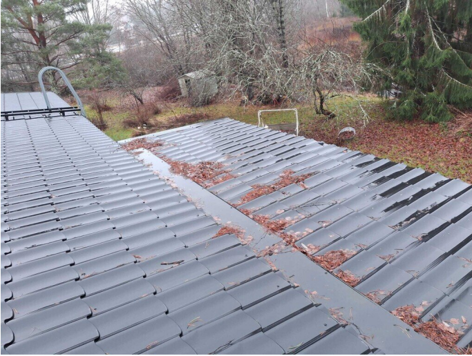
Kuva 61 Uusittu tiilikuvioitu profiilipelti-vesikate pääosin ehjä ja kunnossa. Vesikatteessa paikoin jokusia lommoja ja vesikate paikoin roskaantunut.
