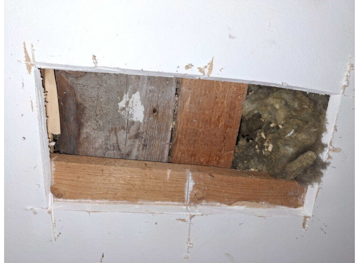
Kuva 16 Asuinkerroksen puualapohjan alapintaan tehdyn rakenneavauksen kautta havaittiin, että alapohjan lämmöneristeenä on mineraalivilla. Asuinkerroksen puualapohjarakenne kallistaa paikoin kellarissa ulkoseinäperusmuuria kohti, mutta tarkastuksella ei saatu varmuutta, onko rakenteisiin tehty muutoksia/korjauksia vai ovatko rakenteet painuneet.
