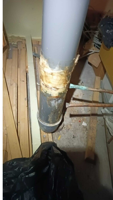
Kuva 32 Kellarissa yläpuolisesta wc-tilasta tulevassa muoviviemäriputkessa havaittiin tiivistetty/korjattu paikkaus putken näkyvällä pystyosuudella. WC-istuimelta pystyviemäriin laskevassa viemäriputkessa oli kallistuspuute putkien muhviitoksen kohdalla.
