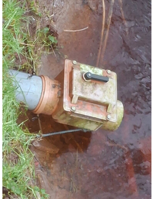
Kuva 46 Viemäriputken päässä on takaiskuventtiili, mikä estää veden virtaamisen viemäriputkeen ja kohti rakennusta ojan tulviessa.
