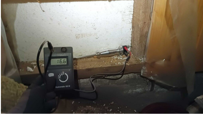
Kuva 11 Piikkimittarilla mitattuna maanvastaisten ulkoseinien puurakenteiden kosteus paikoin lievästi koholla.
