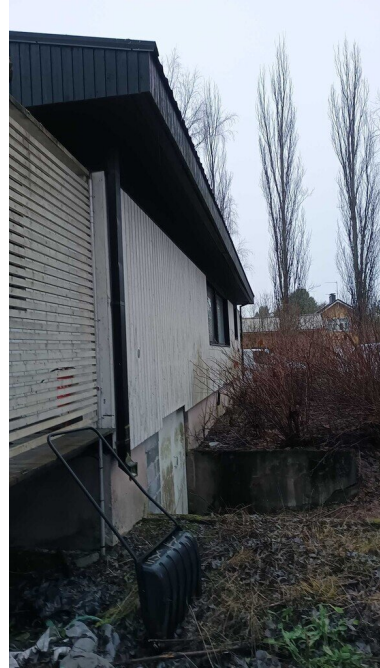
Kuva 38 Maanpinta rakennuksen vierustalla melko tasainen ja maanpinnan kallistus rakennuksesta poispäin puutteellinen.
