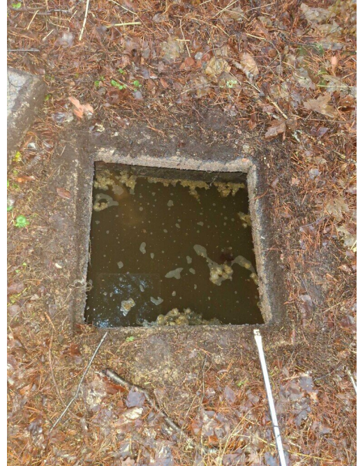
Kuva 44 Rakennuksen jätevesiviemäriin todennäköisesti alkuperäinen betoninen saostuskaivo tontin takapihalla tarkastettiin silmämääräisesti. Saostuskaivossa vedenpinta tarkastushetkellä oli hyvin korkealla ja kaivolta purkava viemäriputken suuaukko vedenpinnan alapuolella. Vettä jätevesiviemäriin laskettaessa havaittiin saostuskaivossa vedenpinnan lievää virtausta, mikä viittaa siihen, että jätevesi poistuu kaivosta hiljalleen. Saostuskaivosta jätevedet johdettu tontin rajalla olevaan avo-ojaan muoviviemärillä.
