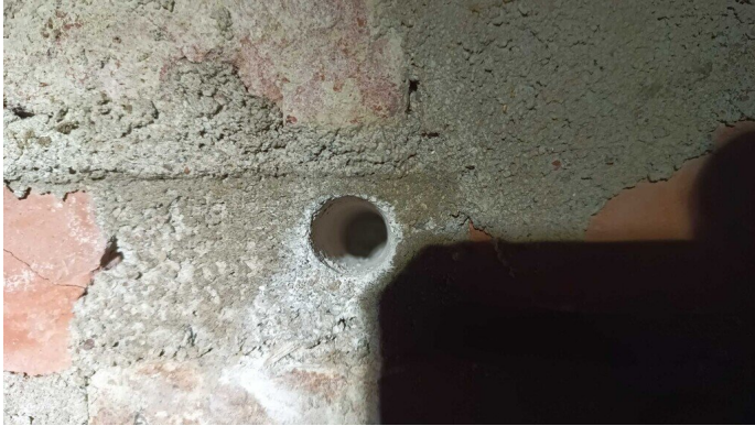
Kuva 15 Takapihan puoleisella maanvastaisen ulkoseinän sisäpuolinen rivinteeri-muuraus on tehty suoraan vasten ulkoseinäbetoniperusmuuria eikä välissä havaittu lämmöneristettä tai ilmarakoa.
