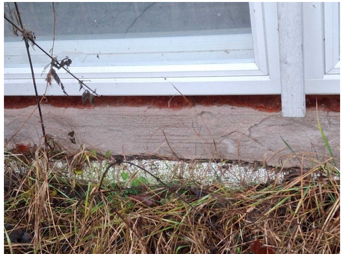
Kuva 40 Havaintojen perusteella perusmuurien patolevyt puuttuvat. Perusmuureja vasten havaittiin paikoin solumuovieriste eli styroksi.
