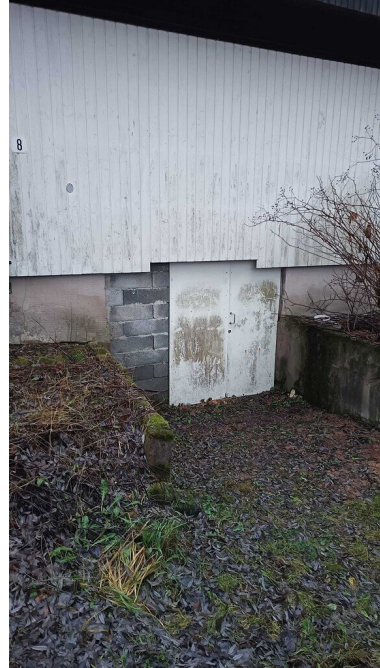
Kuva 12 Kellarin entisen autotalliluiskan kohdalla ei havaittu sadevesiviemäröintiä eikä oven kohdalla ole kynnystä. Oven alaosan kautta sade- ja sulamisvedellä kulkeutumisreitti kellarisiin.
