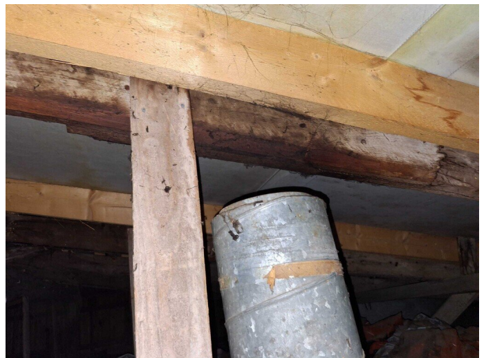
Kuva 72 Yläpohjatilaan on päätetty ilmanvaihtokanavia, joiden kohdalla vesikattorakenteet tummentuneet ilmankosteuden tiivistyttyä rakenteiden kylmälle pinnalle.
