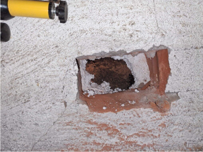
Kuva 3 Kellarin maanvastaisten ulkoseinäperusmuurien rivinteerimuurauksen taustalla ohut solumuovieriste oli kostea tarkasteluhetkellä. Rivinteerimuuraus tehty päin eristettä eikä rivinterin taustalla havaittu ilmarakoa.
