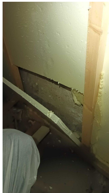
Kuva 14 Takapihan puoleisella maanvastaisen ulkoseinän sisäpuolinen rivinteeri-muuraus on tehty suoraan vasten ulkoseinäbetoniperusmuuria eikä välissä havaittu lämmöneristettä tai ilmarakoa.
