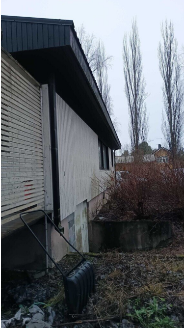
Kuva 43 Rakennuksen kattosadevesien sadevesiviemärointi sekä räystäskourut ja syöksytorvet puuttuvat ja sadevedet johdettu vesikatolta suoraan maahan rakennuksen vierustalle.
