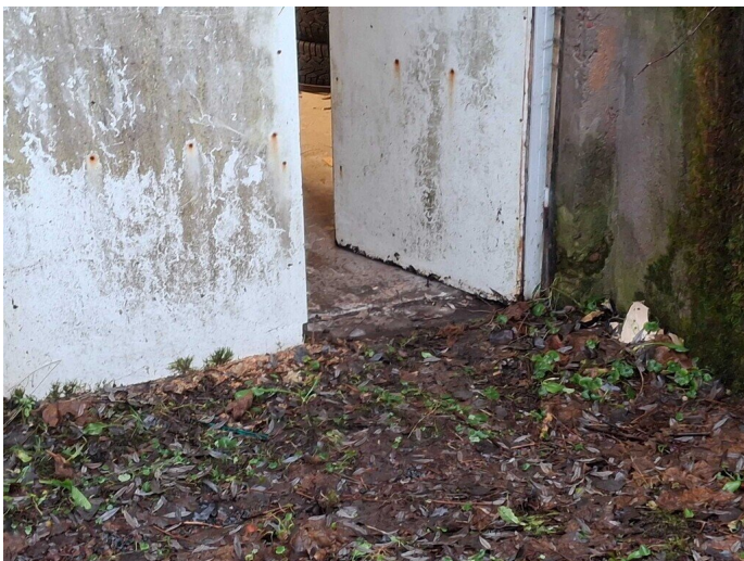
Kuva 13 Kellarin entisen autotalliluiskan kohdalla ei havaittu sadevesiviemäröintiä eikä oven kohdalla ole kynnystä. Oven alaosan kautta sade- ja sulamisvedellä kulkeutumisreitti kellarisiin.
