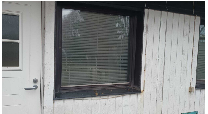
Kuva 52 Asuinkerroksen puuikkunat ikääntyneet ja kuluneet. Ikkunoiden puuosissa laajalti säärasituksen ja ikääntymisen aiheuttamaa halkeilua.
