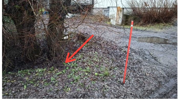
Kuva 78 Tontin sisäänajoliittymän kohdalla tonttivesijohdon sulkuventtiilin suojaputkessa vettä ja sulkuventtiin kara veden alla.
