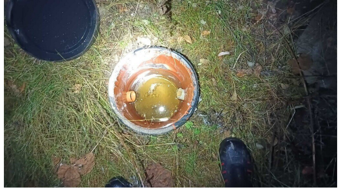
Kuva 42 Rakennuksen mahdollisen salaojajärjestelmän tarkastuskaivot yhtä lukuun ottamatta puuttuvat tai ovat maanpinnan alapuolella eikä salaojajärjestelmän kunnosta tai olemassaolosta saatu varmuutta. Takapihalla tarkastettiin todennäköinen salaojan tarkastuskaivo. Tarkastuskaivoon johdetut salaojaputket ovat halkaisijaltaan kapeaa muoviputkea ja putkien päät nousseet ylöspäin kaivon routimisesta johtuen.
