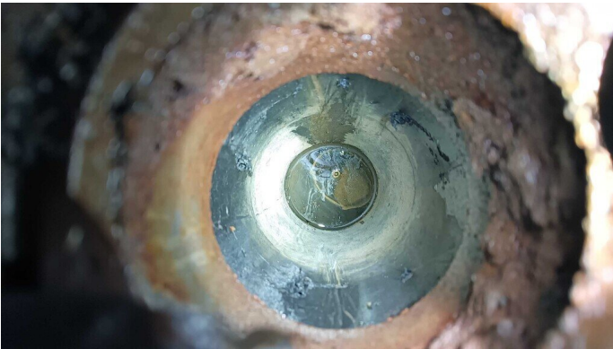
Kuva 79 Tontin sisäänajoliittymän kohdalla tonttivesijohdon sulkuventtiilin suojaputkessa vettä ja sulkuventtiin kara veden alla.
