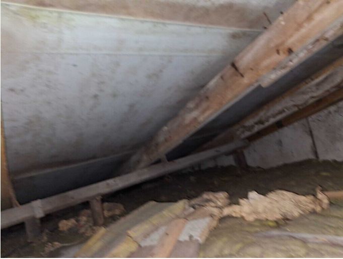
Kuva 69 Yläpohjatilan tuuletus puutteellinen ja yläpohjatilassa havaittiin tummentumaa ja mikrobiperäistä kasvustoa aluskatteen alapinnassa sekä vesikaton puurakenteissa.
