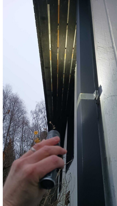
Kuva 66 Vesikaton räystäsrakenteet ja räystäänauluslaudoitukset pääosin ehjät ja kunnossa. Vesikaton räystäskourut puuttuvat. Syöksytorvet entiset piiloräystäskourujen syöksytorvet, mitkä jääneet paikoilleen vesikattosaneerauksessa.
