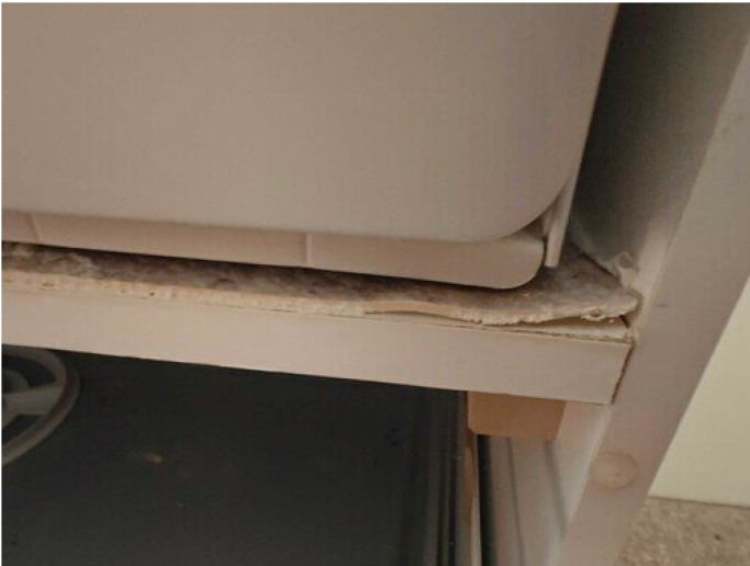
Kuva 46 Astianpesukoneen alla on muovimatto ja massatiivistys
