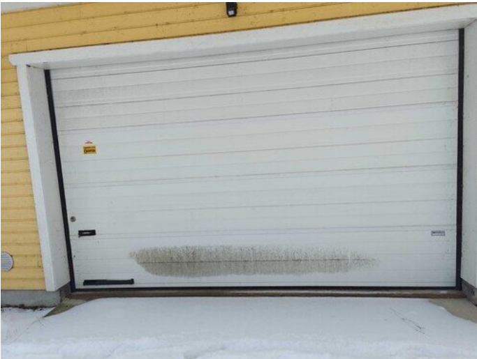
Kuva 19 Autotalli laajennuksen uusittua ovea ja oven pinnan likaantumista
