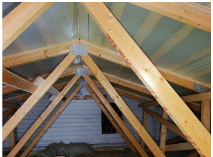
Kuva 26 Autotalliosan aluskatetta ja alkuperäisen osan tarkastusaukkoa
