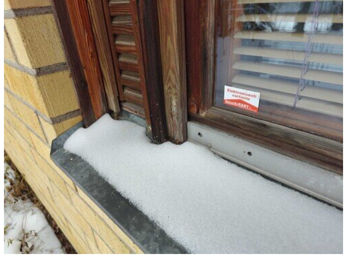
Kuva 18 Ikkunan puuosien pinnan haristumaa sekä ikkunan pellityksen ja pielirakenteen tiiveyttä
