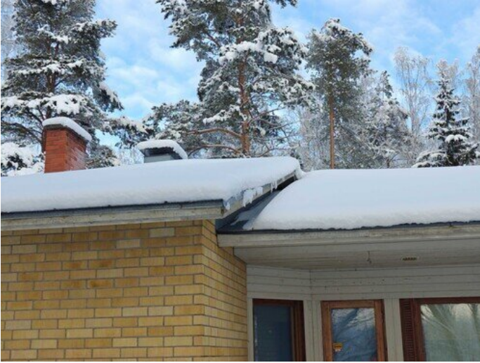
Kuva 22 Vesikaton lumipeitettä ja takakuistin kohdalla ei ole lumiesteitä
