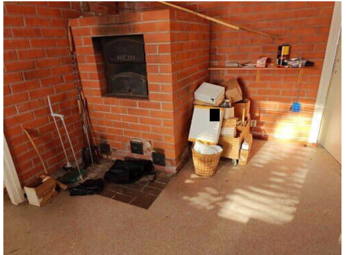
Kuva 47 Leivinuunin ympärillä kivrakenteisessa lattian seinän alaosissa kohdalla olevaa kosteutta.
