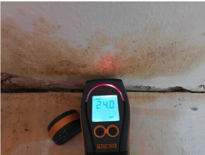
Kuva 52 Piikkimittarilla seinän alaosa märkä 24,0 paino% suositus alle 18 paino%.
