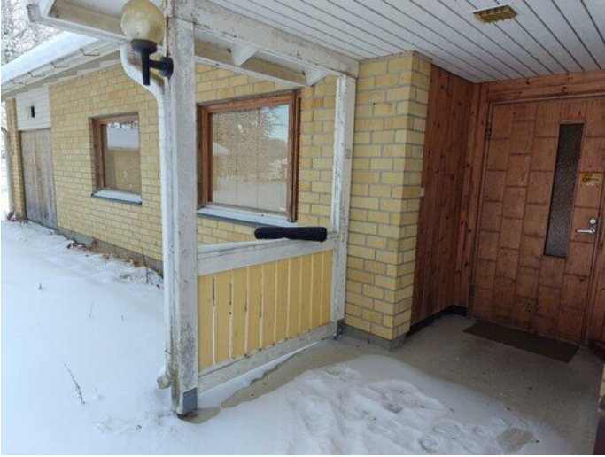
Kuva 8 Kuistin puupintojen haristuminen
