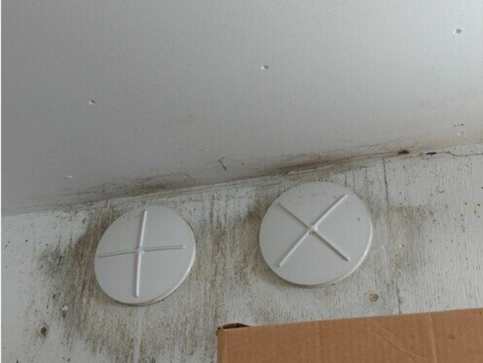
Kuva 62 Raikas ilmaventtiilin kohdalla seinäpinnan vaurioita
