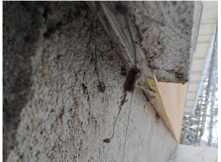
Kuva 11 Laajennusosan puuverhouksen alaosa ei ole todettavaa tuuletusrakoa
