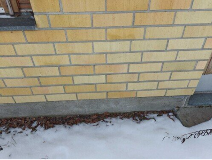
Kuva 16 Tiiliverhouksessa ei ole tuuletusrakoja
