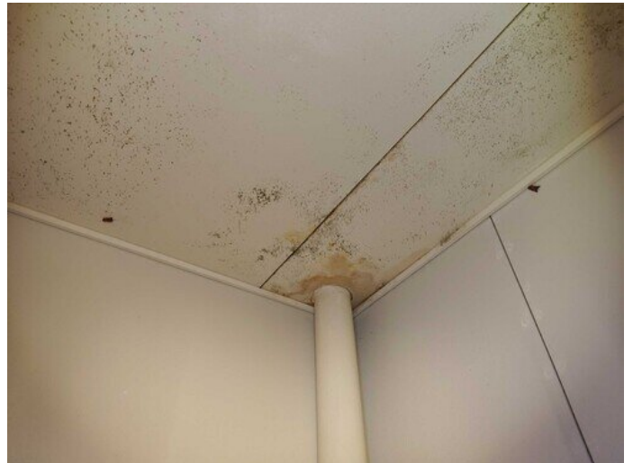
Kuva 34 Sisäkaton vaurio- ja kosteusjälkiä
