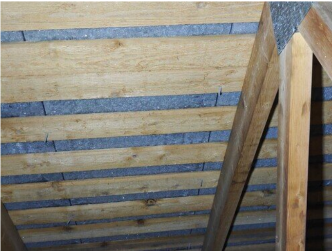
Kuva 33 Alkuperäisen osan peltikaton alla ei ole aluskatetta
