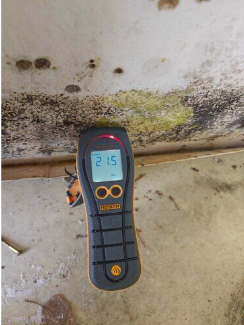
Kuva 58 Teknisen tilan seinä puun piikkimittarilla märkä 21,5 paino%, suositus alle 18 paino%
