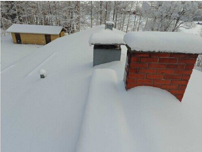
Kuva 24 Läpivientikappaleita ja sisäänkäynnin kohdalla olevia lumiesteitä. Savupiipun päällä ei ole säältä suojaavaa sadehattua.
