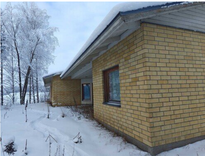
Kuva 7 Takapihan sadevesikouru ja syöksytorvi puuttuu
