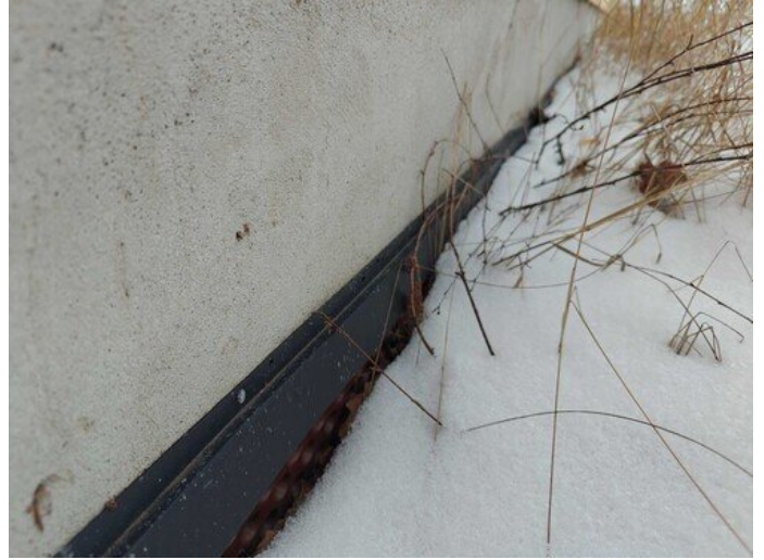
Kuva 2 Patolevyä laajennusosalla ja sokkelin vierustaa
