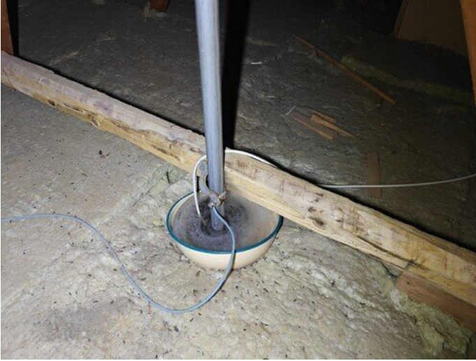
Kuva 31 Antennin putken alapuolella on vati jossa jäätä
