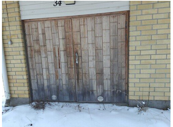
Kuva 20 Alkuperäisen autotallioven pinnan haristumaa
