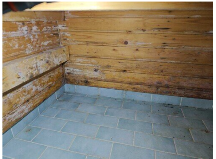
Kuva 39 Saunan paneloinnin pinnan vaurioita
