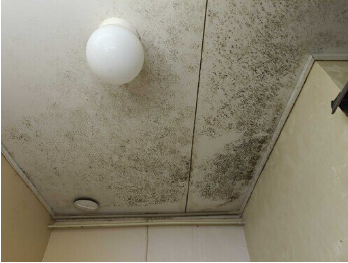
Kuva 35 Sisäkaton pinnan vauriojälkiä
