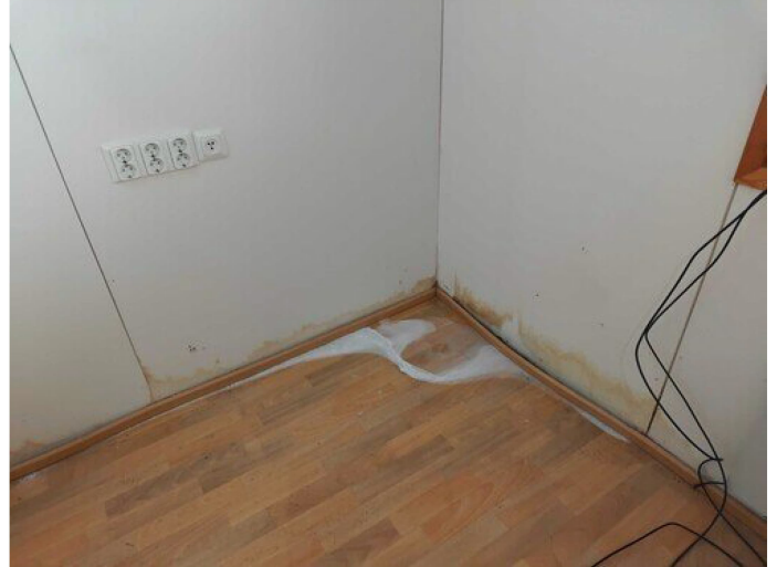
Kuva 51 Teknistä tilaa vasten olevaa makuuhuone vauriojälkiä
