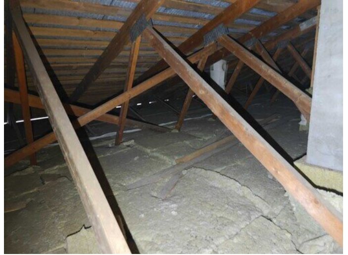
Kuva 28 Alkuperäisen vesikatteen alla ei ole aluskatetta
