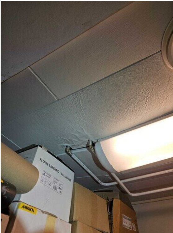
Kuva 1 Sisäkatossa vesiputkien kohdalla kosteusjäljet. Kts. pohjakuvan 1, Liiketilän 9b pohjapiirros_2026012314080403840000007727 merkintä 1.
