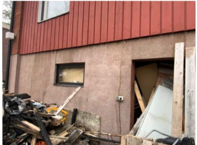
Kellarikerros betonirakenteinen. Valumäjälkiä kellarin seinissä.
