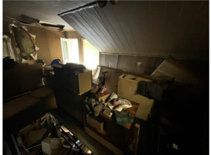
Yläkerran aulatilän irtaimistoa. Yläkerran irtaimisto on kärsinyt palovaurioita sekä nokeentunut voimakkaasti ja kastunut sammutusvedestä.
