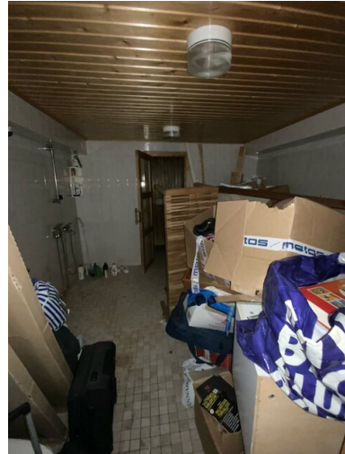
Kellarikerroksen pesutilat. Kellarikerroksessa rakenteista valuu sammutusvettä. Kellarin pesutilat laatoitettu, katto paneloitu.
