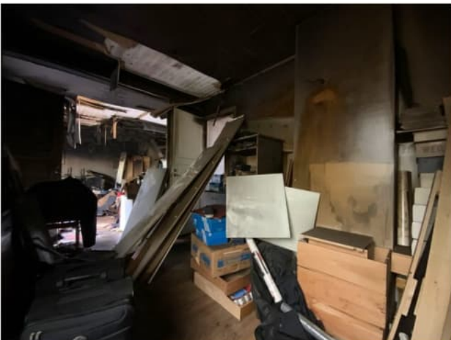
Keskikerroksen takahuoneen irtaimistoa. Keskikerroksen irtaimisto on kärsinyt palovaurioita sekä nokeentunut voimakkaasti ja kastunut sammutusvedestä.
