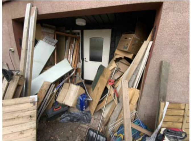
Kellarin sisäänkäynnin kohdalla runsaasti tavaraa.
