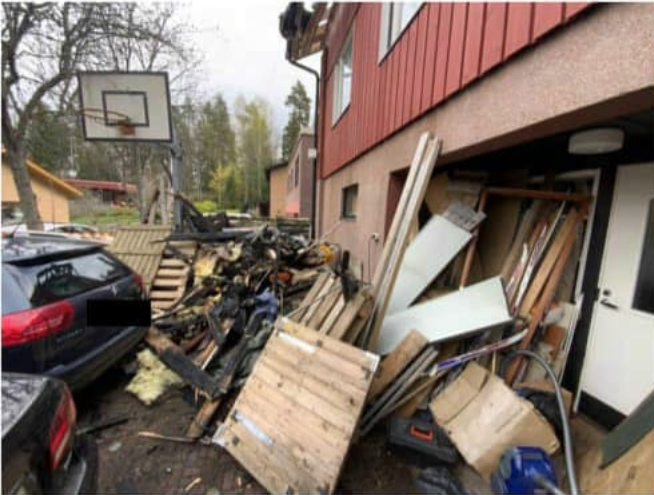
Palokunta nostanut pihalle palojetettä. Pihalla myös runsaasti irtaimistoa. Kellari betonirakenteinen.
