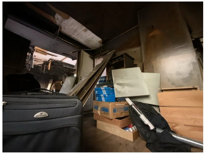
Keskikerroksessa palovaurioita. Kaikki pinnat nokeentunut voimakkaasti. Keskikerroksessa sammutusvettä kaikkialla. Katot paneloitu. Lattia laminaattia.
