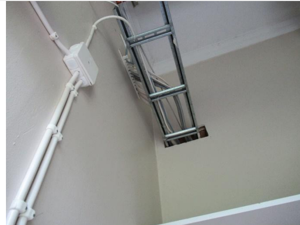
Kuva 20. Päärakennuksen johtoteitä ja kaapelasennuksia.
