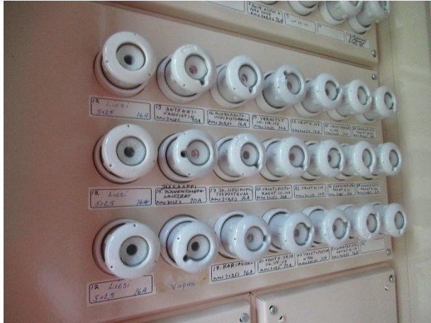
Kuva 21. Päärakennuksen jakokeskuksen JK101:en sulaketäulu.
