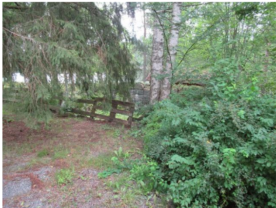
Kuva 3. Olutkellarin raunioiden aita on heikkokuntoinen
