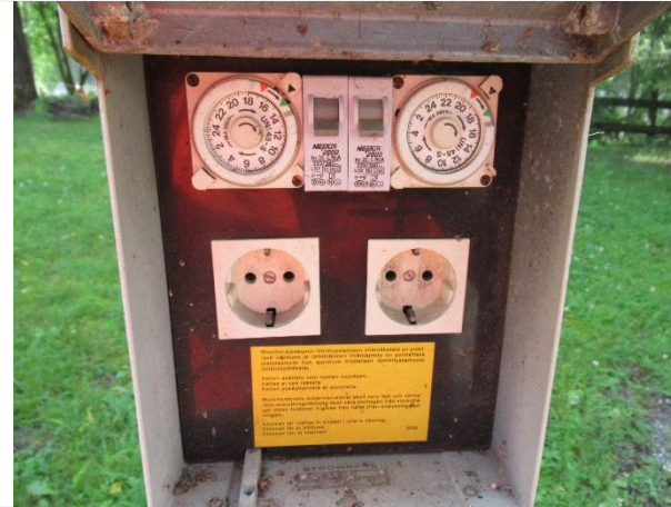
Kuva 22. Pihan autolämmityspistorasiakotelon sisältö
