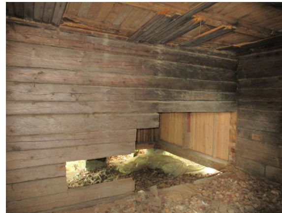
Kuva 4. Rannan saunarakennus on purkukuntoinen
