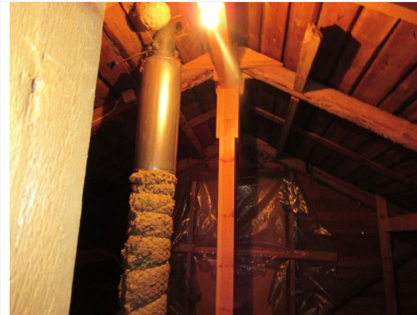
Kuva 20. Ilmanvaihtokanaviston eristys tulee tarkastaa ja tarvittaessa korjata
