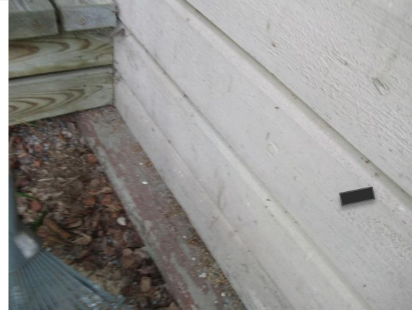
Kuva 2. Retkeilymajan ulkoseinä on kosketuksissa maan pintaan
