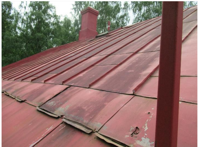
Kuva 15. Vesikatto räystään vaurioita, päärakennus
