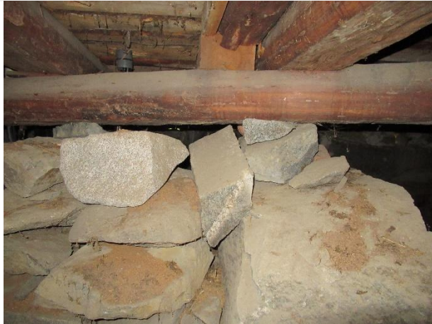
Kuva 5. Päärakennuksen alapohjan epämääräinen kiviladontuenta
