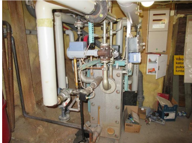
Kuva 17. Kaukolämpöalakeskus on lähes teknisen elinkaarensa päässä.
