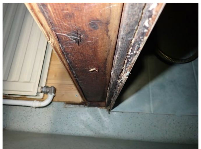
Pesuhuoneen ja saunan välisen seinän alaosassa kosteusvaurioita.
