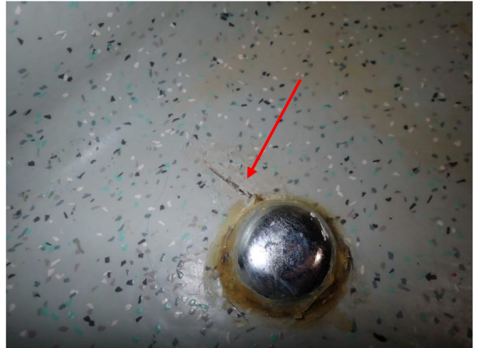
Pesuhuoneen lattian muovimatossa rakoilua.
