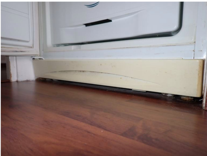
Vuotokaukaloita ei ole asennettu kylmälaitteen tai astianpesukoneen alle.
