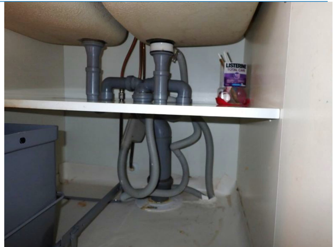
Keittiön allaskaapin putkiliitoksia.
