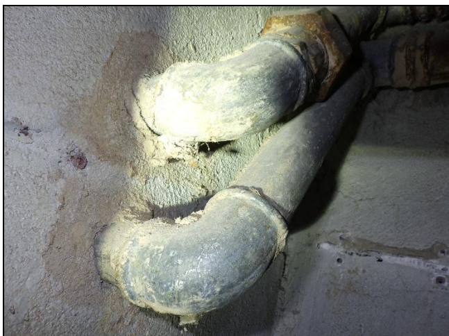
Kuva 29. Massaeristeen jäämiä putkien pinnalla.
