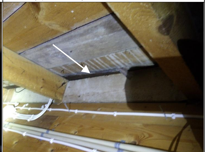
Kuva 15. Tuuletusrakoa ei ole.
