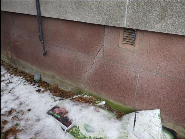
Kuva 1. Sokkelikorkeus on asianmukainen. Halkeama.
