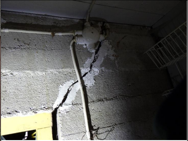
Kuva 2. Halkeama kellarin seinässä.
