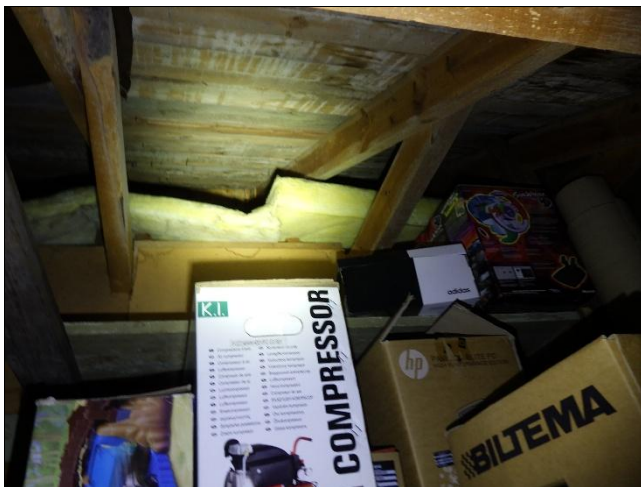
Kuva 16. Harjan alapuoliseen tilaan ei päästy.
