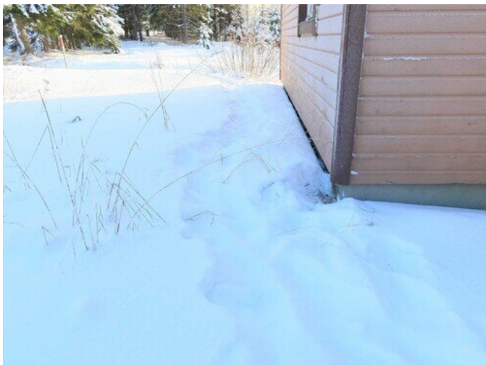
Kuva 1 Kadun puolen maanpinnan kallistus on loivasti rakennukseen päin
