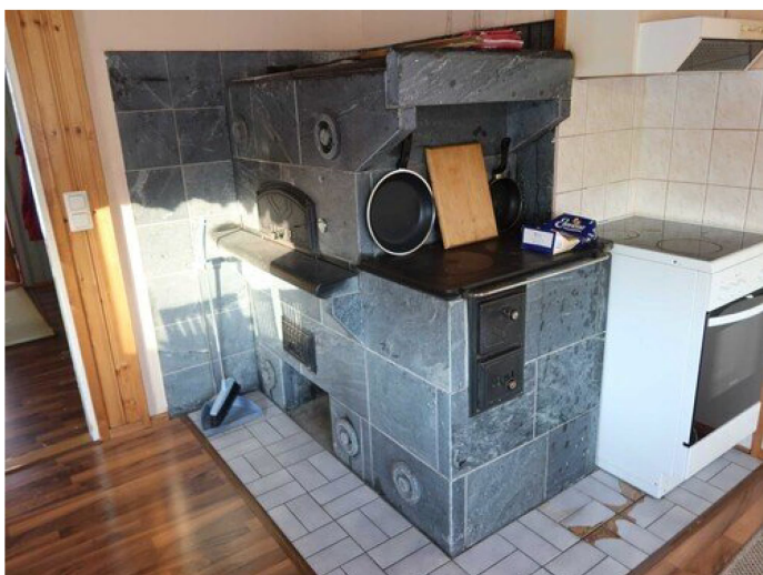
Kuva 47 Leivinuunia, puuhellaa ja sähköliettä, jonka yläpuolella liesituuletin
