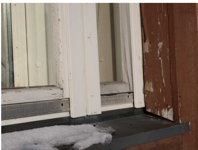
Kuva 26 Ikkunan pellityksen ja pielirakenteen liitosta sekä pintojen haristumaa
