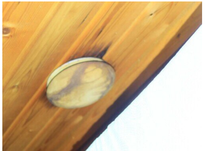
Kuva 40 Sisäverhouksen vaurioitumista ilmanvaihdon venttiilin kohdalta
