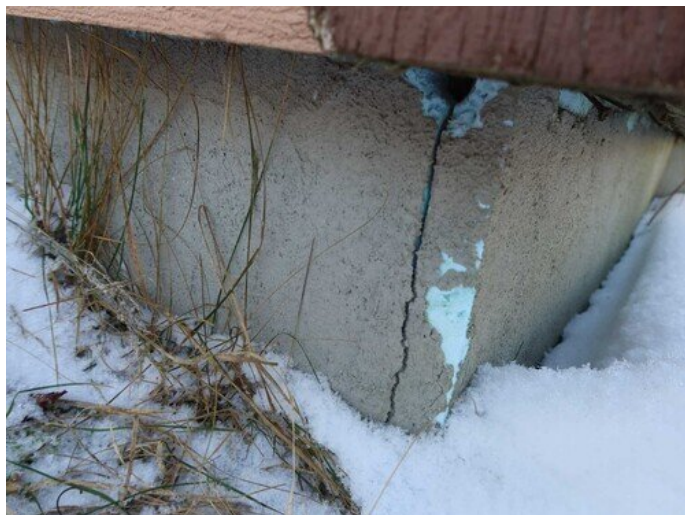
Kuva 2 Sokkelin pinnoitettua XPS eristelevyä ja pinnoitteen irtoamaa
