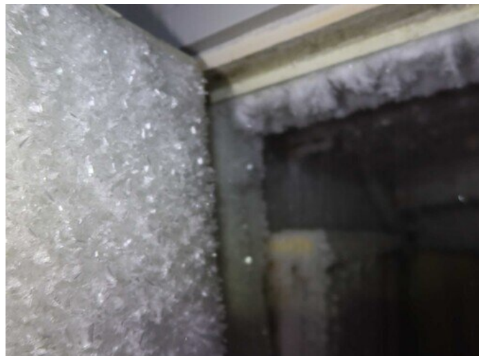
Kuva 6 Kellarin ovea ja sen pinnan kuuraa
