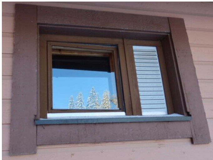
Kuva 25 Laajennusosan ikkunan ulkolasin halkeamaa
