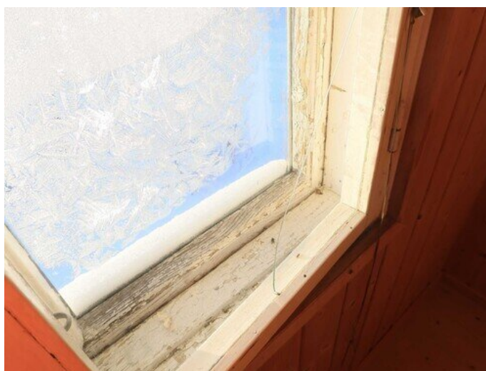
Kuva 27 Sisälasin halkeamaa ja pintojen haristumaa
