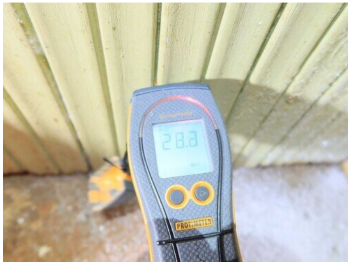
Kuva 8 Puuverhotun kellaritilan verhous märkä puun piikkimittarilla 28,3 paino%, suositus alle 18paino%
