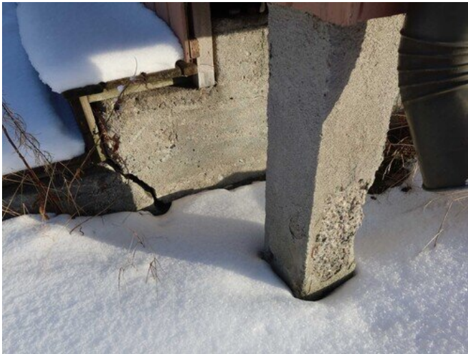
Kuva 3 Pilarin pinnan rapautuminen
