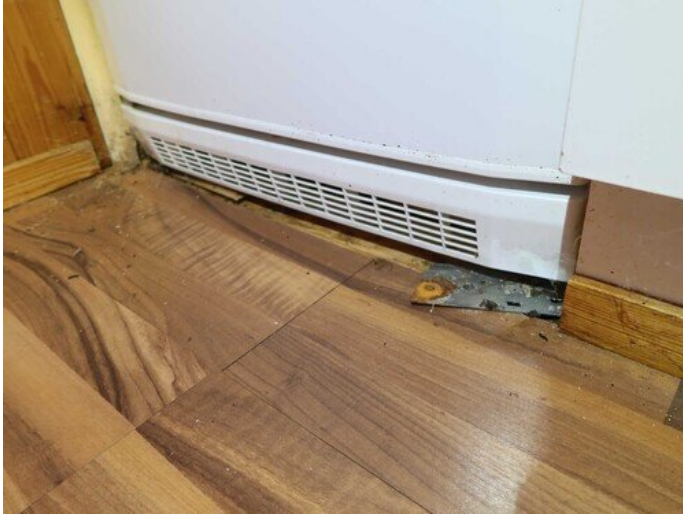
Kuva 49 Kylmälaitteen alla ei ole valumakaukaloa
