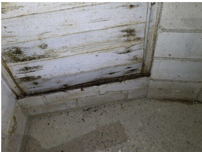
Kuva 11 Vaurioitunutta puuovi rakennetta
