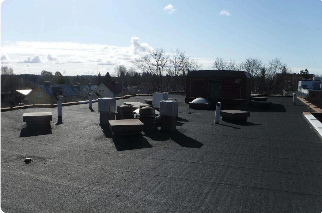
Havainto 1 Katoille ei ole asennettu turvaköyden kiinnityspisteitä.
