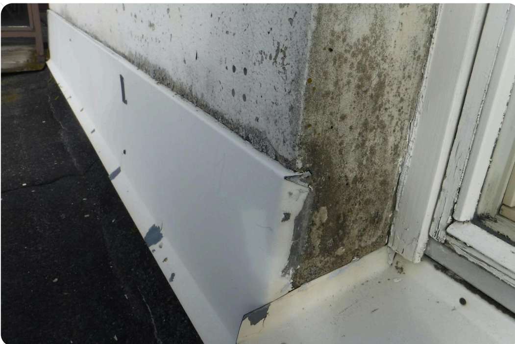
Havainto 15 Seinärakenteisiin liittyvien pellitysten yläreunojen tiivistyksissä on havaittavissa puutteita.
