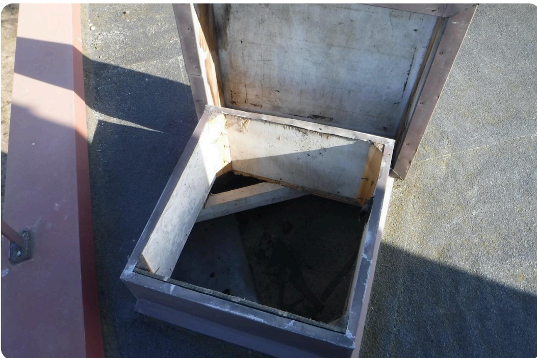
Havainto 11 A-rakennuksen huoltoluukun kansista puuttuvat putoamissuojaketjut.
