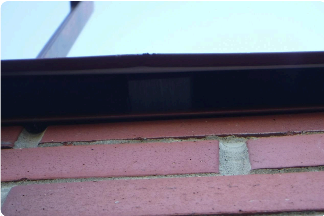
Havainto 14 Pistokokein tarkastettuna räystäälle ei ole asennettu myrskypellityksiä.
