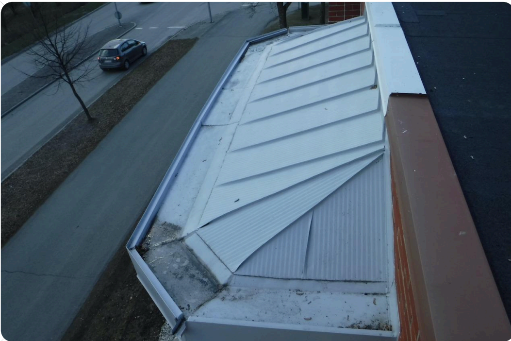
Havainto 6 Parvekkeiden konesaumakatteissa havaittiin eriaisteisia puutteita mm. pellitysten nostokorkeuksissa, kaadoissa ja saumojen ohennuksissa.
