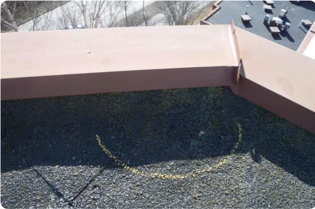
Havainto 4 Molempien rakennusten katoilla havaittiin kovettuneita höyrypusseja.
