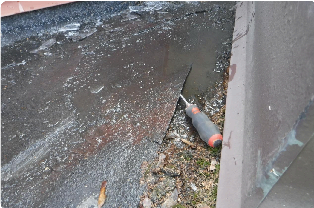
Havainto 3 Avoin kermisauma kohdassa jossa kallistukset puutteelliset. Seisova vesi pääsee vapaasti kermien väliin.
