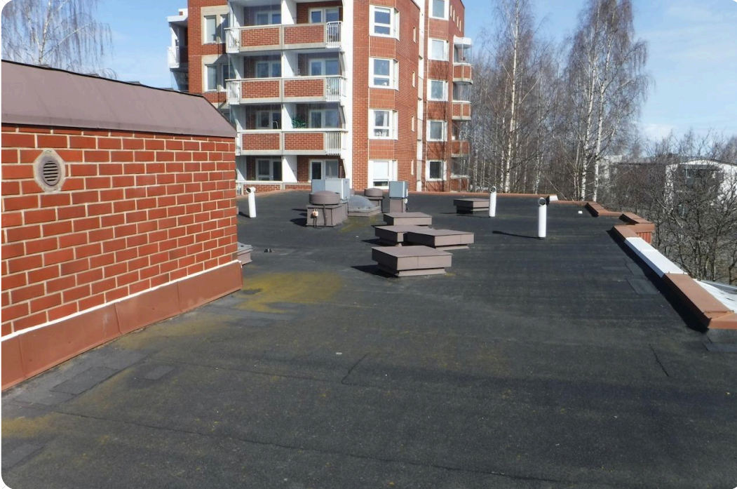
Havainto 2 Vesikattojen kermikate on elinkaarensa päässä. Kermikerrokset ovat varsin kovettuneita, minkä seurauksena pintakermikerros haurastuu ja halkeilee.
