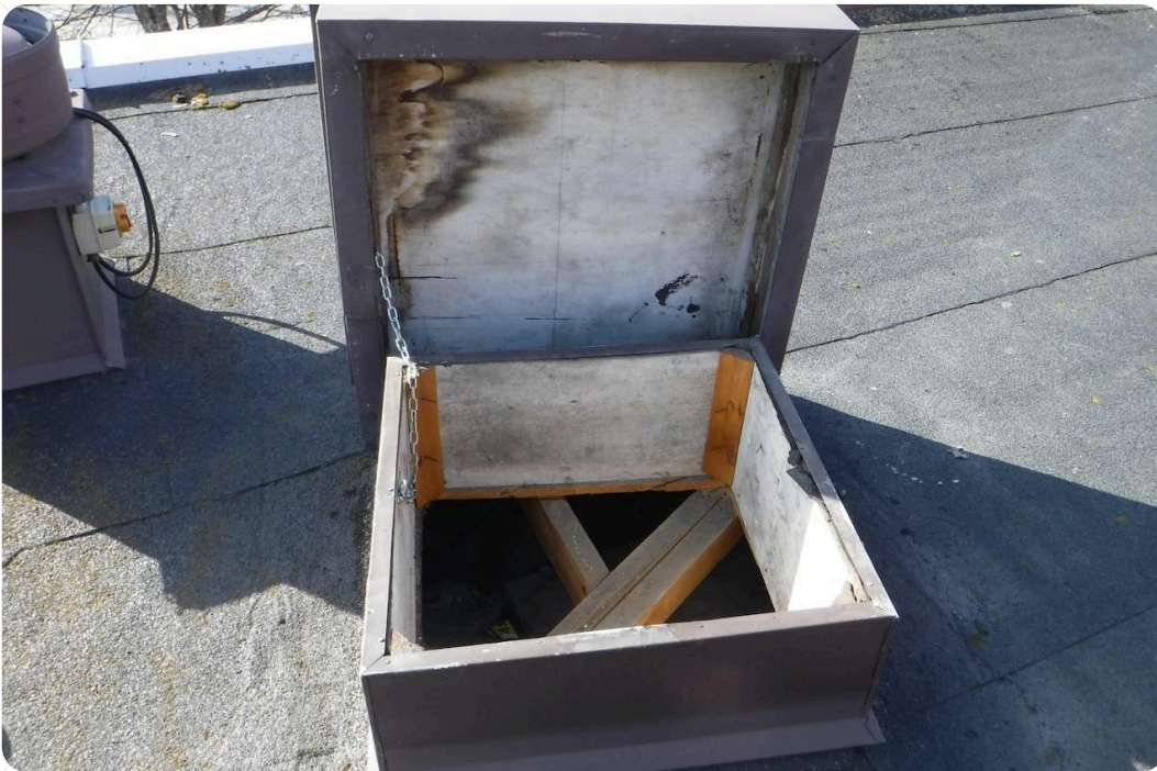
Havainto 10 Tarkastusluukkujen kansissa havaittiin kosteusjälkiä. Puutteellisen yläpohjan tuulettavuuden takia tuuletusilma poistunut tarkastusluukkujen kansiosien/kehyskaulusten välistä.
