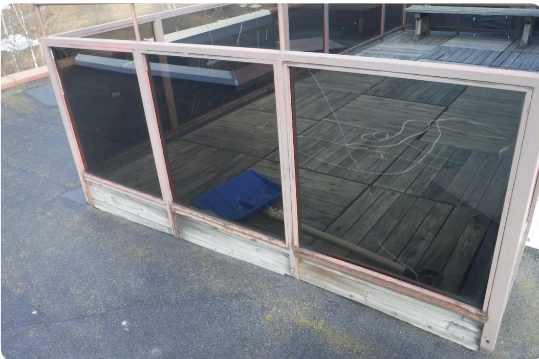
Havainto 7 Parvekkeen runkorakenne on painunut osittain pintakermikerroksen lävitse.
