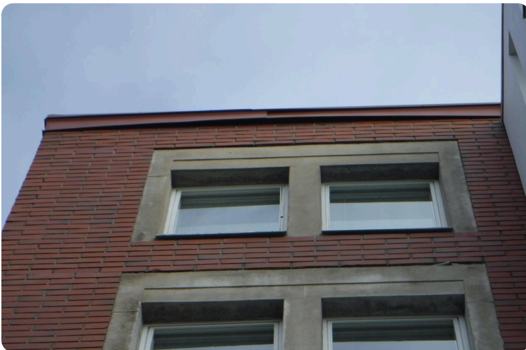
Havainto 13 Räystäspellitysten ulkoreunoja kiinnityksissä havaittiin puutteita. Paikoin on havaittavissa tuulen aiheuttamaa vääntymistä.
