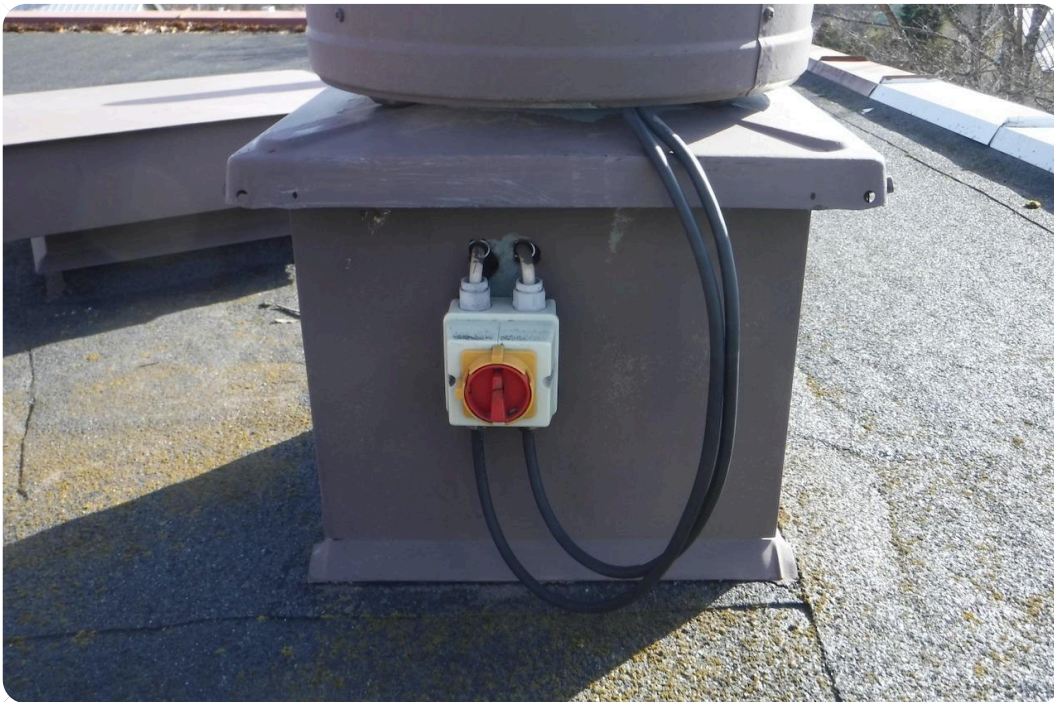
Havainto 8 Iv-läpivientejä lävistävien sähköjohtojen tiivistyksissä on paikoin puutteita ja turvakytkimille ei ole asennettu sadekatoksia.
