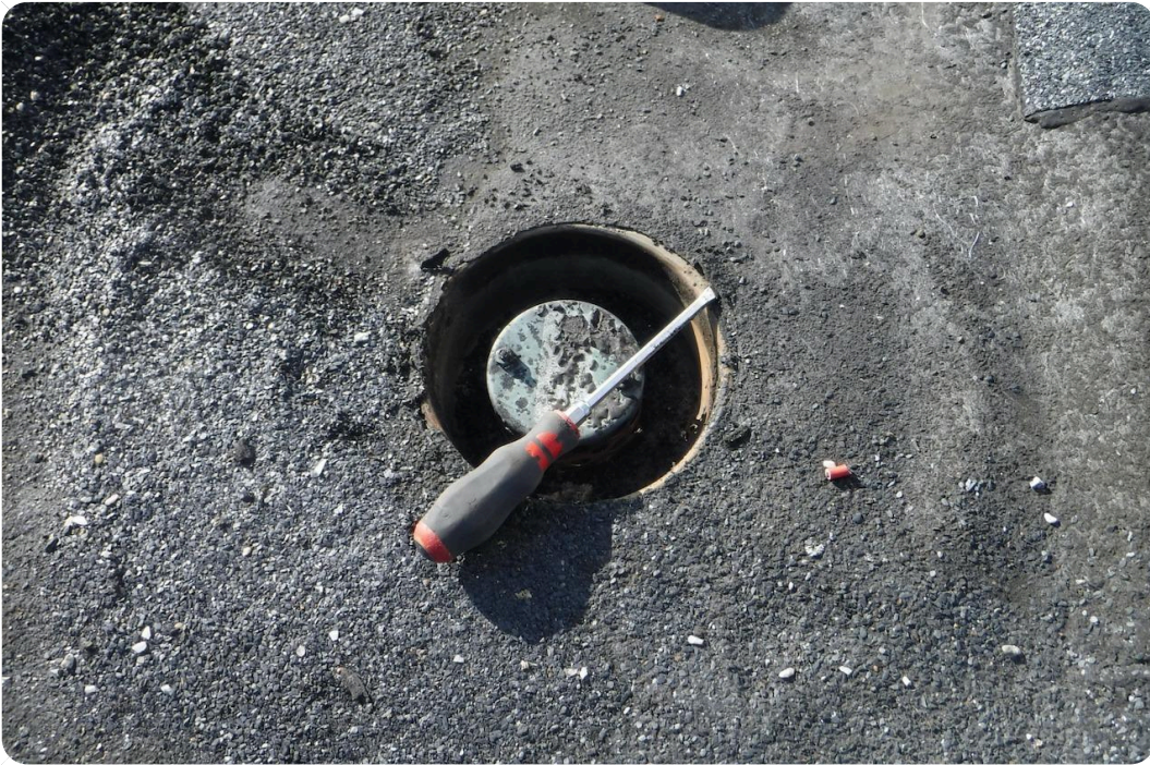
Havainto 16 Kattokaivon laipan kermiliitoksen havaittiin vähäisesti löystyneen
