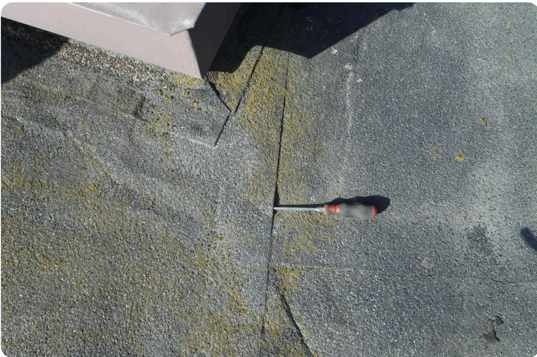
Havainto 5 Katteessa on paikoin avoimia pintakermin saumoja läpivientien ja reunanostojen juurissa.
