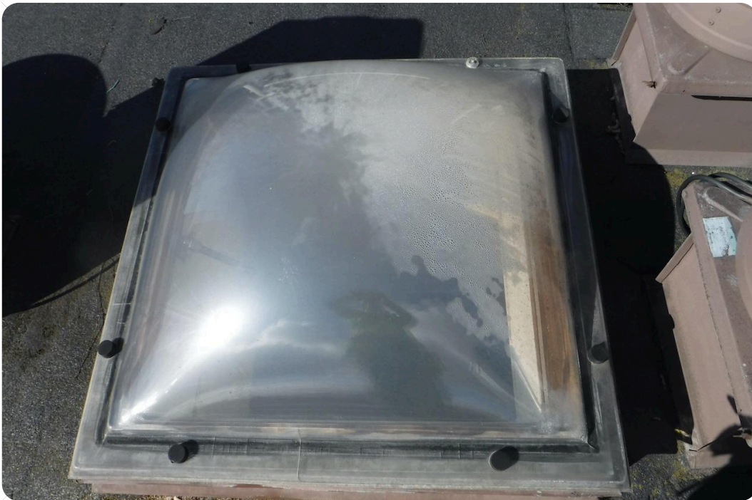
Havainto 12 Valokuvuissa havaittiin halkeilua. Yksittäinen kiinnikkeen muovinen suojahattu puuttuu. Kattokupujen kehyskorkeus on matala n. 200-250mm.
