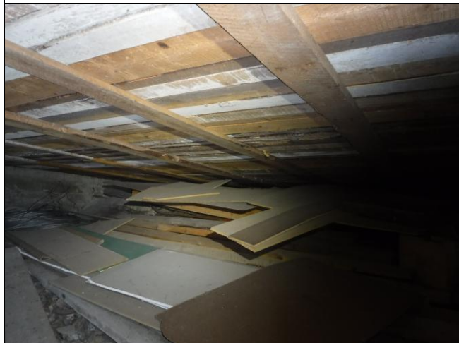
Kuva 3 Ryömintätilassa puu ja levymateriaalia varastoituna.
