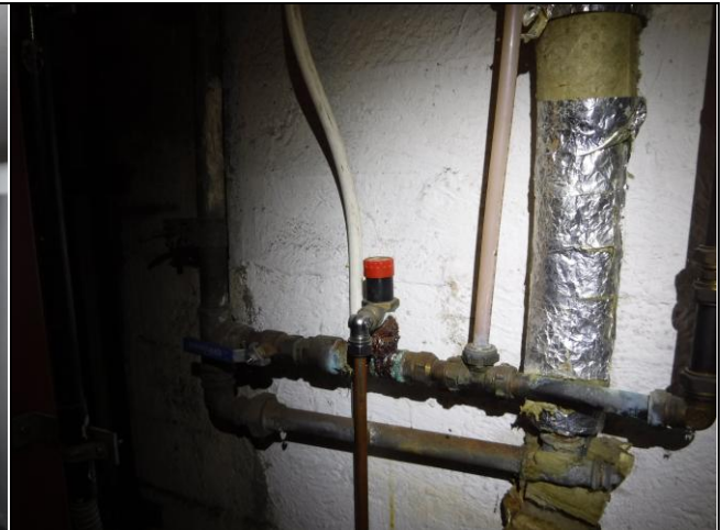
Kuva 37 Varoventtiilin liitos huonokuntoinen
