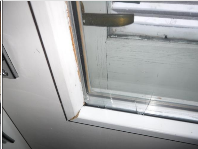
Kuva 14. Yläkerran parveke ovea
