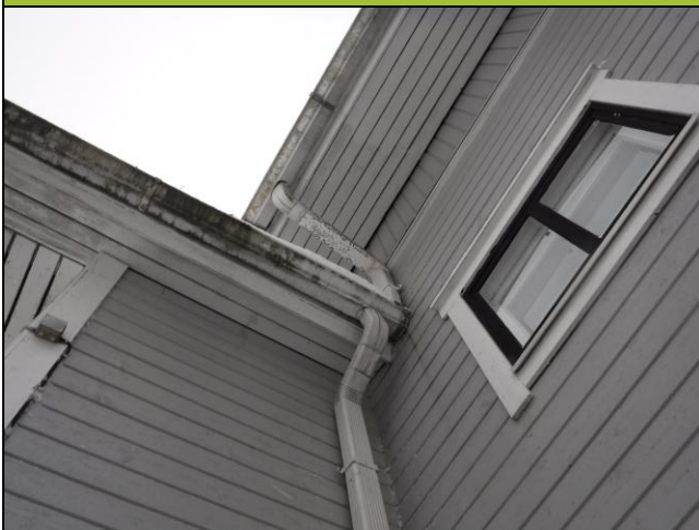
Kuva 9 Julkisivussa jo huoltomaalauksen tarvetta
