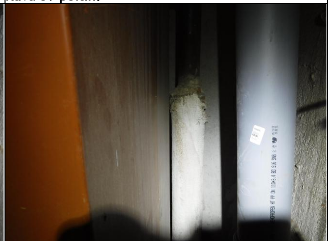
Kuva 41 Mahdollista asbesti eristettä
