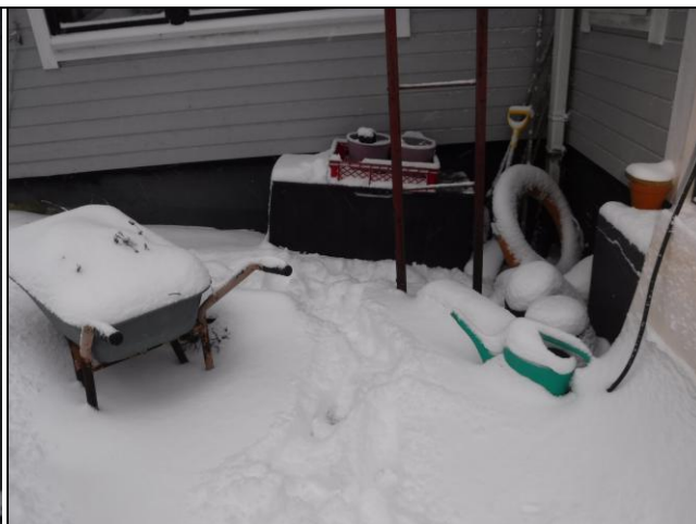
Kuva 6. Vierusta laskee osin taloon päin.
