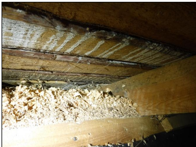
Kuva 17 Eristeen välissä pieni tuuletusrako ja puurakenteessa pientä tummentumaa yläreunassa
