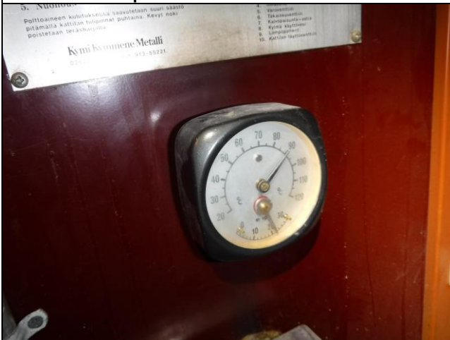
Kuva 38 Kattilan lämpötilaa ja painetta
