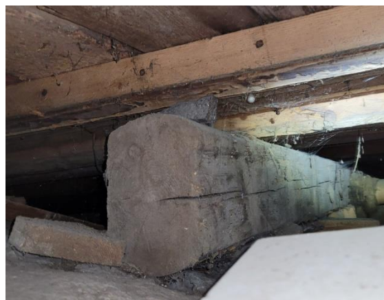
Kannatinhirret ovat paikoin maata/ kalliota vasten. Rossitilan vapaan ilmatilan korkeus oli paikoin vähäinen, mikä rajoitti pääsyä alapohjatilaa.
