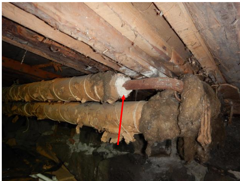
Kuva 3. Vanhat eristeet sisältävät todennäköisesti asbestia.
