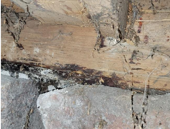
Alimman hirren alapinnassa on pikisivelyä, kreo-soottiöljyä tms.
