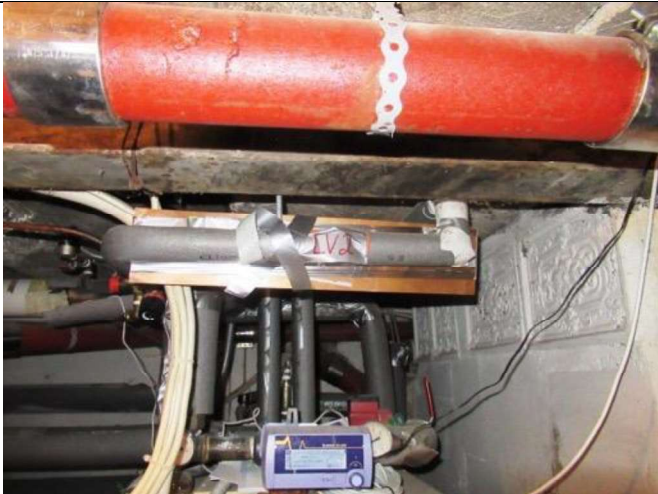
Kellarikerros, Lämmönjakohuonetila; Lv-runkolinja tilan katon rajassa lähellä lämmityskattilaa 22/1,0 mm
