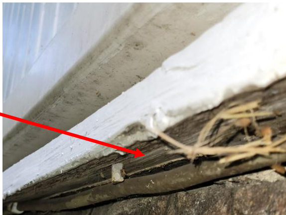
Julkisivuverhouksen alaosassa ei ole korvausilmareittiä.
