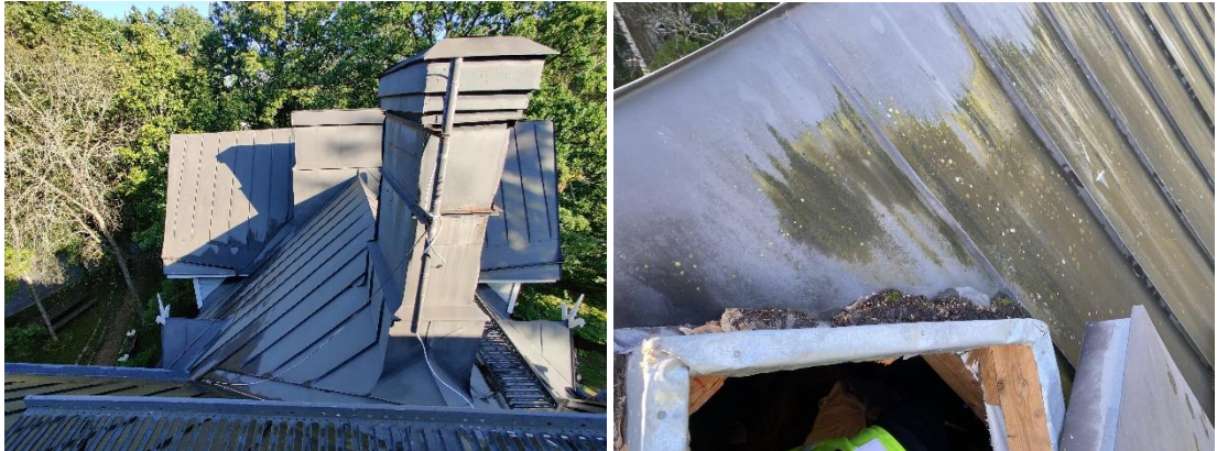
Kuvat 27 ja 28. Peltikatteen maalipinta on yleisesti hyvässä kunnossa. Varjokohdissa peltikatteessa on likaa ja sammaloitumista.
