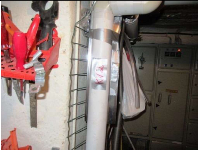
Kellarikerros, Lämmönjakohuonetila; Kv-run- kolinja tilan seinustalla lähellä vesimittaria 22/1,0 mm
