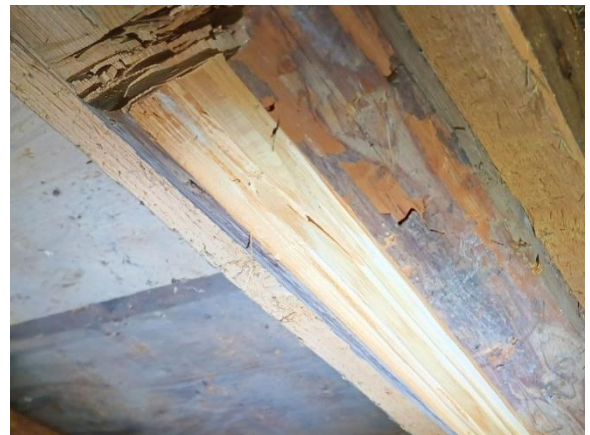
Osanäyte 2 otettiin rossitilasta sellaisesta kohdasta hirttä, jossa ei ollut näkyvissä merkittäviä vaurioita.
