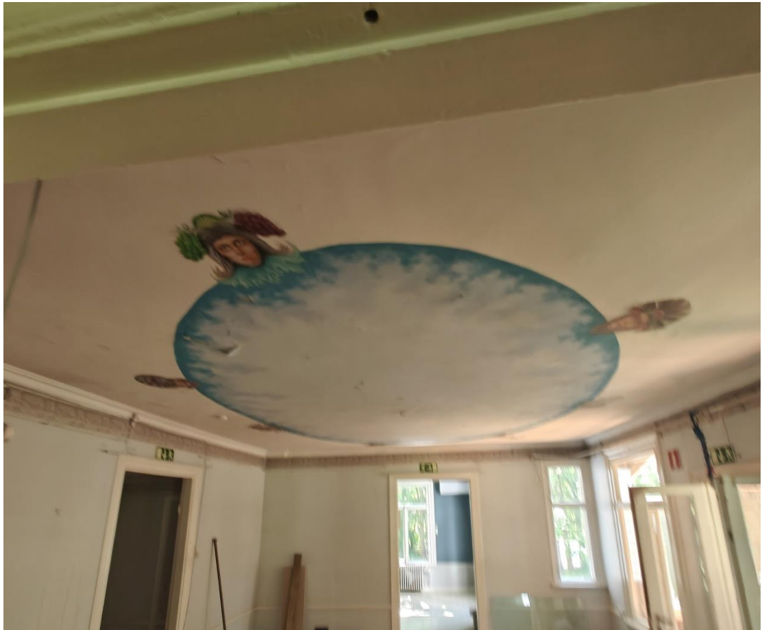
Kuva 23. 1. ja 2. kerroksen välinen välipohja. Muutamassa kohdassa havaittiin välipohjassa notkahduksia.
