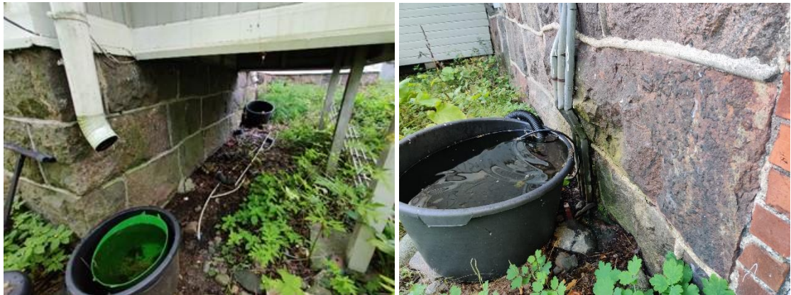
Kuvat 2 ja 3. Sadevedet katolta on ohjattu rännien kautta erillisiin paljuihin, joihin vesi jää seisomaan. Osassa paljuista vesi on päässyt kastelemaan sokkelirakennetta.
