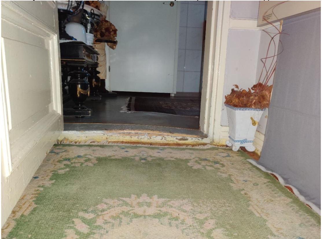
Kuva 13. Ensimmäisessä kerroksessa vessojen edessä havaittiin lattiassa notkahdus.
