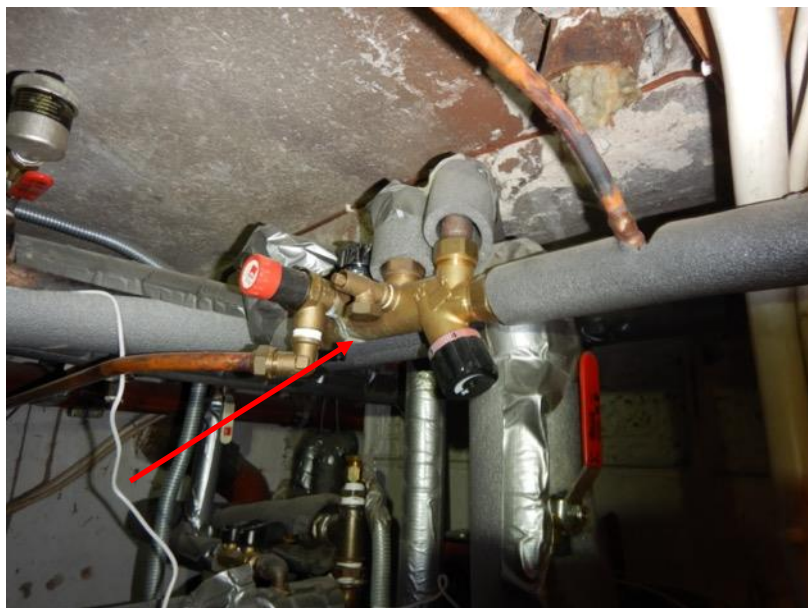
Kuva 9. Yleiskuva käyttöveden sekoitusventtiilistä.
