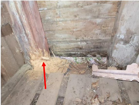
Varastossa oleva pystytolppa on lahonnut lähes poikki.
