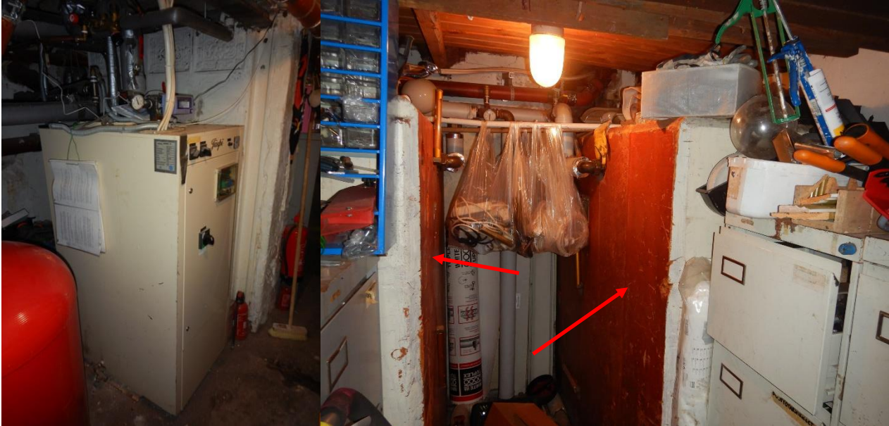
Kuva 1. Yleiskuva kattilasta ja varaajista.
