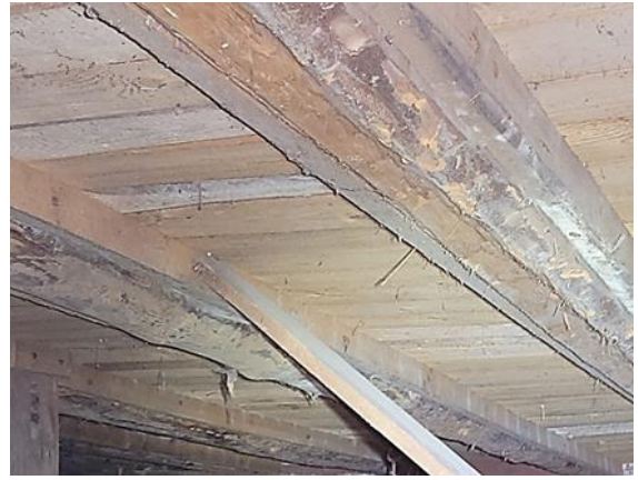
Osa alapohjan kannatinlaudoista on uusittu sahapintaiseksi laudaksi. Näiltä osin laudoitus oli pääosin hyväkuntoinen.
