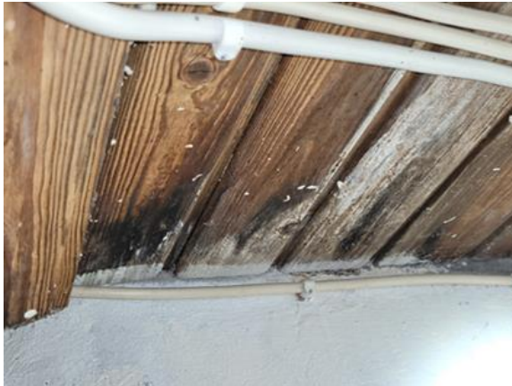
Lämmönjakohuoneen ikkunasyvennyksen ylä-osa. Perusmuuria vasten olevissa laudoissa on kosteudesta aiheutunutta mustumaa.
