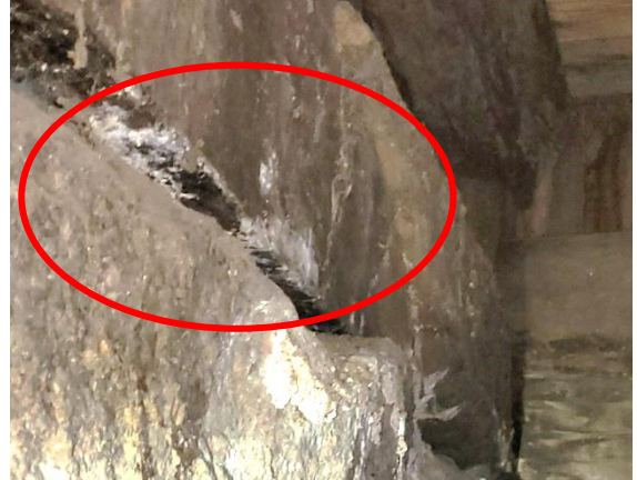
Pääsisääkäynnin kohdalla alapuolisissa hirsissä oli paikallisia kosteusjälkiä.
