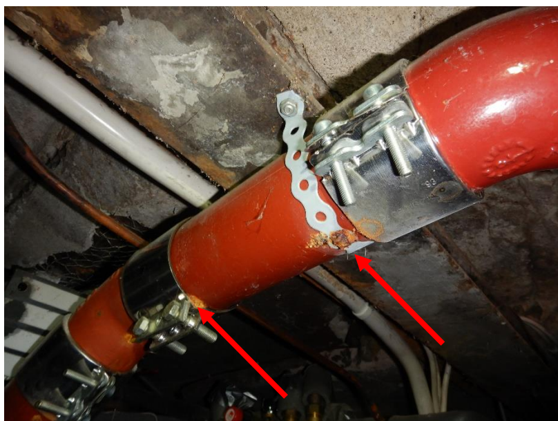
Kuva 12. Rasvaviemärit ovat läpisyöpyneet.
