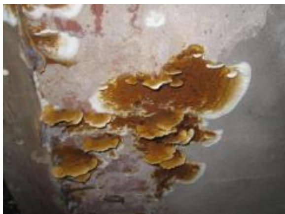
Kuva Tommi Pirttimäki Mikrobivaurioituneen ryömintätilan korjaustapasuunnitelma, opinnäy- tetyö Metropolia Amk
