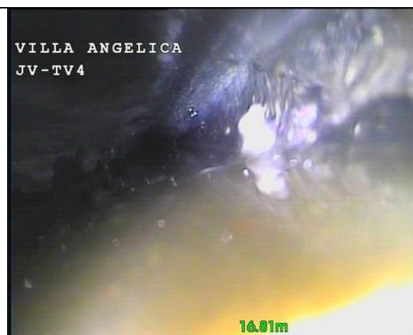
JV-TV4: Viemärissä on painumaa.
