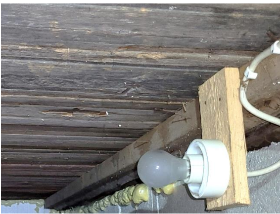
Alapohjassa sijaitsevassa jälkeempään tehdyssä varastotilassa kannatinlaudoissa on pintavaurioita.
