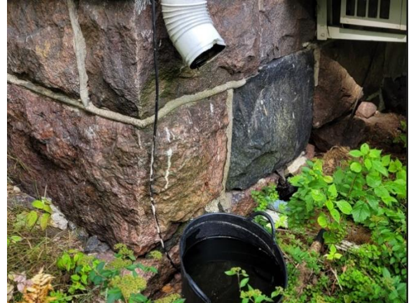
Hulevesien poisjohtaminen on puutteellista.
