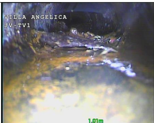
JV-TV1: Korroosiokertymä padottaa virtausta.
