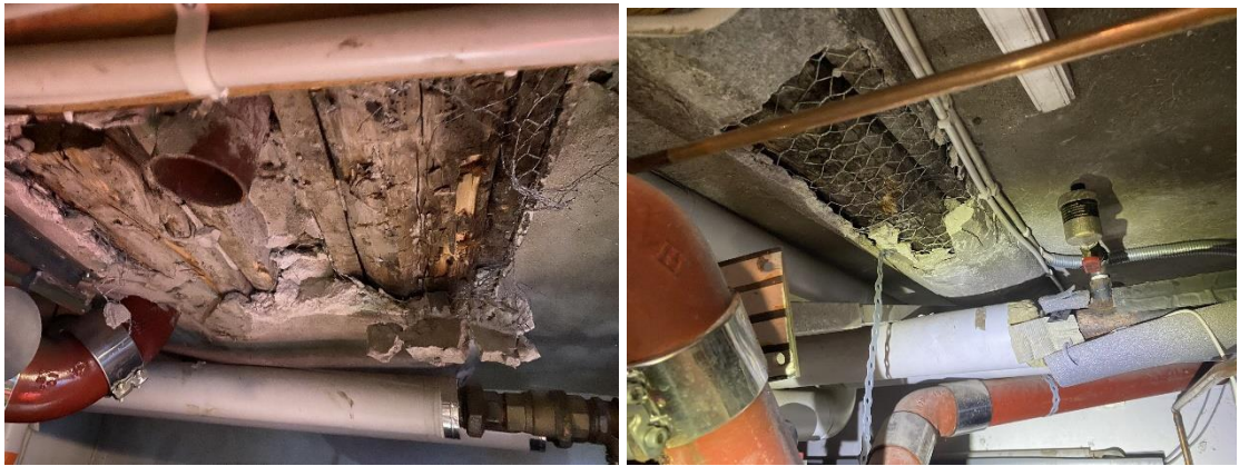
Kuvat 11 ja 12. Puupalkin rappaus vaurioitunut. Käytöstä poistettu viemäri tulppaamatta.
