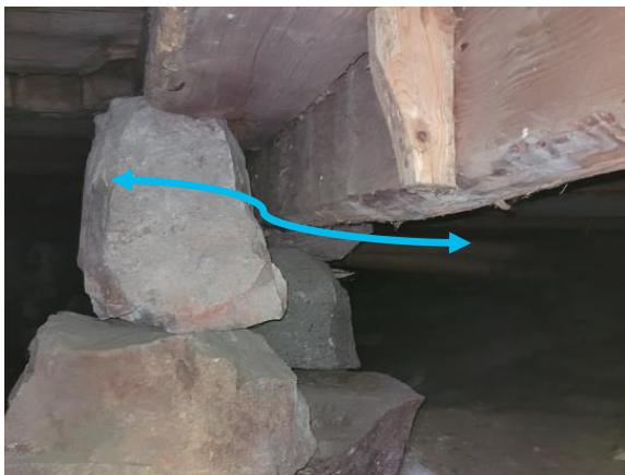
Puinen kannatinpalkki (haltiaparru) on tuettu irtonaisten kivien varaan. Kuva on otettu länsisivulla sijaitsevan pääsisäänkäynnin alapuolelta. Perustuskuvasta poiketen sisäänkäynnin alapuolinen osio on ilmayhteydessä muuhun alapohjatilaan.
