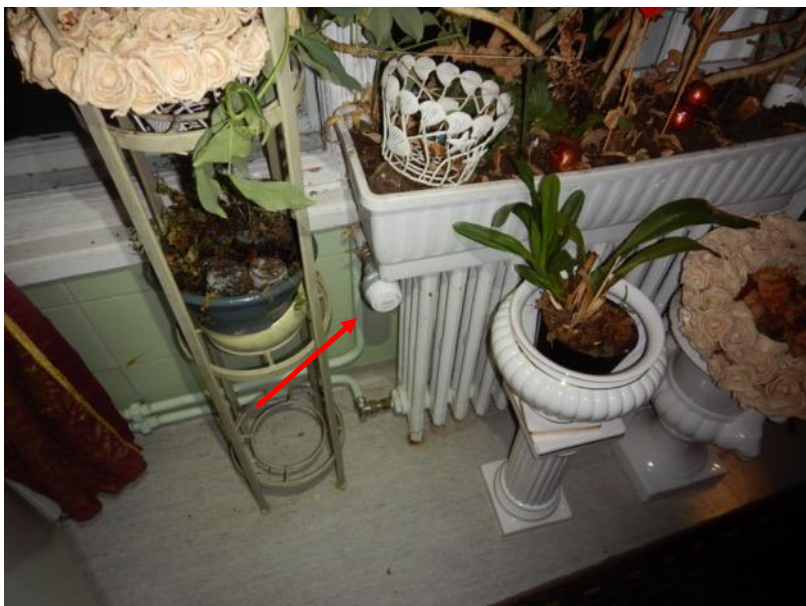
Kuva 4. Yleiskuvat lämpöpatterista ja patteriventtiilistä.
