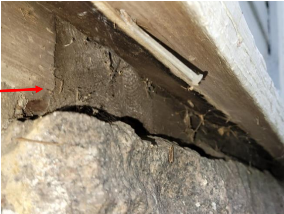
Tippalista ei suojaa riittävästi hirttä, ulkopuolelta tehdyn arvion perusteella hirren alapinnassa ei havaittu kosteudeneristettä.
