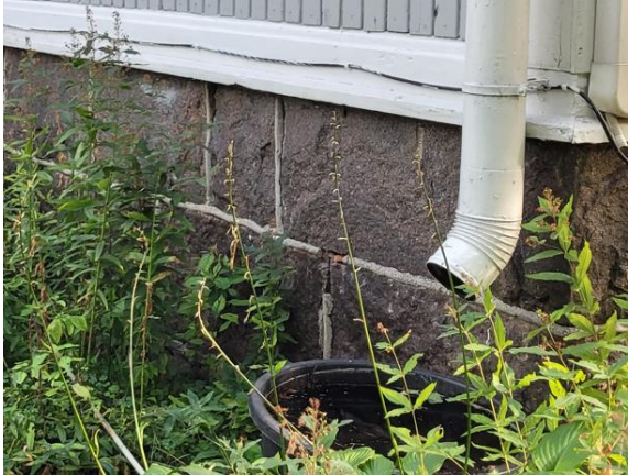
Hulevesien poisjohtaminen on puutteellista.
