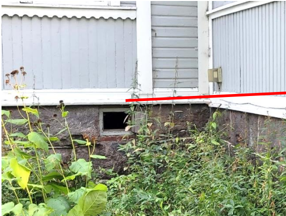
Pääsisääkäynnin kohdalla julkisivuverhouksen alaosassa oleva tippalista ei suojaa kunnolla hirsikehikkoa. Kivijalassa on paikoin tuuletusluukuja.
