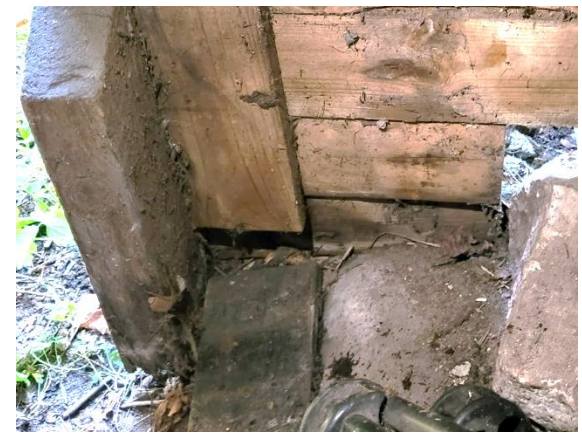
Osa varaston puurakenteista on lähes maassa kiinni. Puurakenteessa on kosteusjälkiä.
