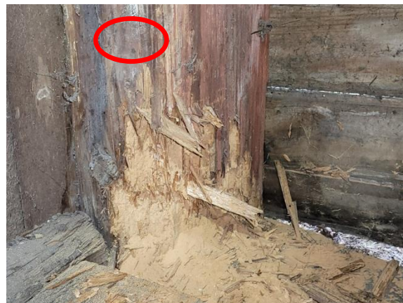
Osanäyte 4 otettiin itäisivulla olevan portaikon alla olevan varaston tolpasti lahonneen/ vaurioituneen osan yläpuolelta.
