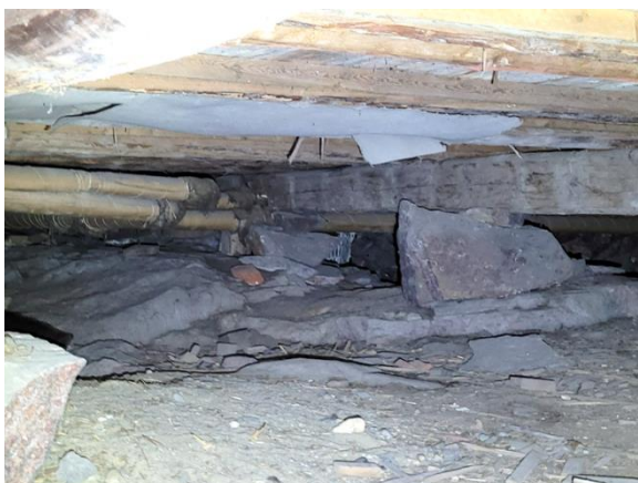
Rakennuspohjan kallio on osin näkyvissä, osin kallion päällä on maa-ainesta, jonka päällä on rakennusjätettä. Kannatinhirsi (haltiaparru) on tuettu irtonaisten kivien varaan.
