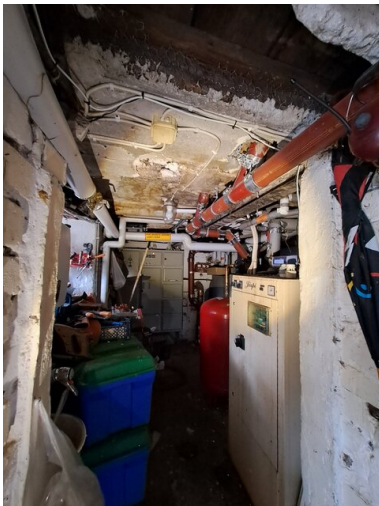
Kellarin katon rappauspinnalla valumajälkeä
