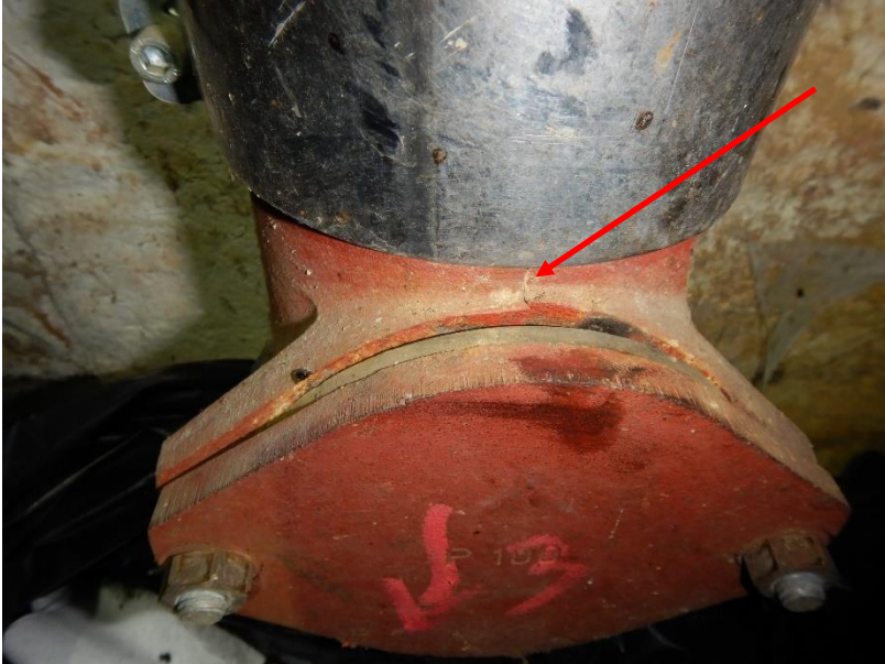
Kuva 13. Viemäri halkesi luukun kiristämisen yhteydessä voimakkaan syöpymisen vuoksi. Viemäri korjattiin tutkimuksen aikana.
