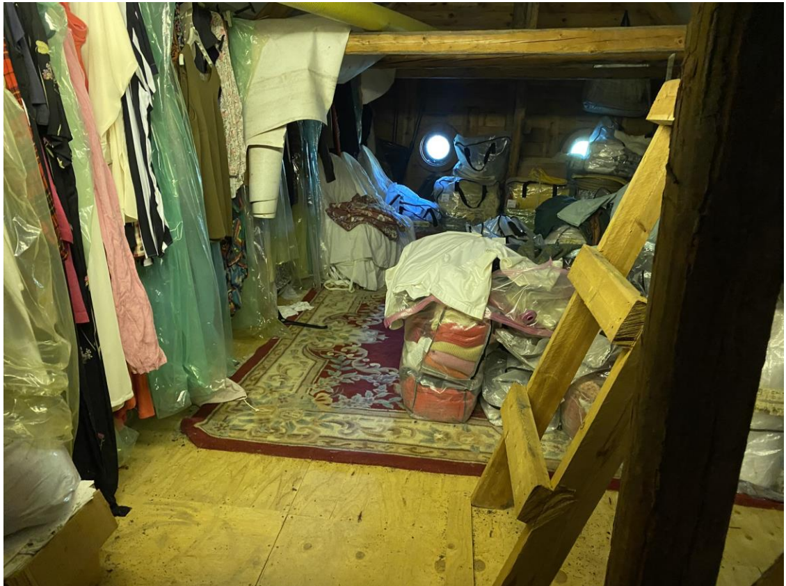
Kuva 30. Ullakkotilassa on paljon tavaraa, joka lisää palokuormaa.
