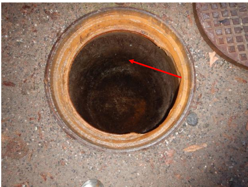
Kuva 6. Yleiskuva viemärikaivoista, kaivossa on juurikasvustoa.
