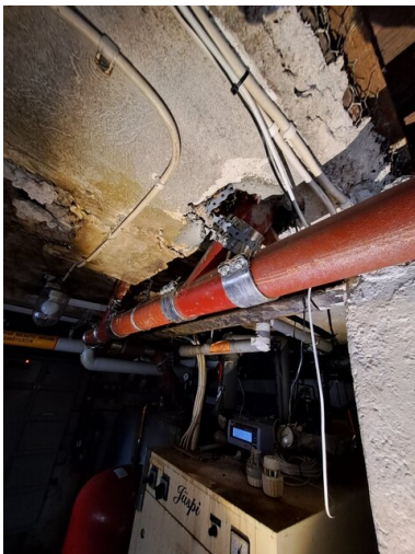
Viemärin läpivienneissä mm. puutteellinen palokatko.
