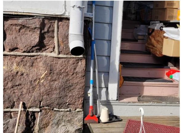
Portaikun ja siinä yhteydessä olevan varaston korkomaaailma poikkeaa merkittävästi muusta rakennuksesta. Hulevesien poisjohtaminen on puutteellista, sokkelikivi saattaa ajoittain kylmänä pintana kondensoida kosteutta siinä kiinni olevaan panelointiin yms.
