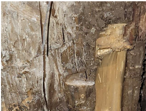
Osanäyte 1 otettiin lämmönjakohuoneesta, hirsien pinnasta. Hirsien pinnassa oli näkyvissä värimuutosta, kuten valkeita pilkkuja. Heti pinnan jälkeen puuaines oli kovaa ja "terveen" näköistä.
