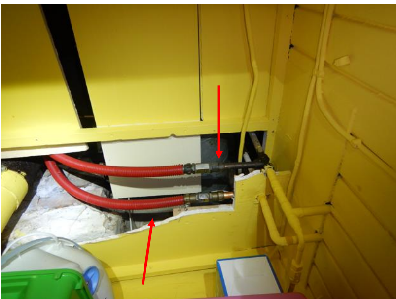
Kuva 8. Muoviputkien kannakointi on puutteellinen, tukipisteet puuttuvat muoviputken ja metalliputken välistä.
