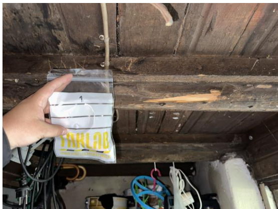
Kuva 18. Teknisen tilan alapohjan puupalkki ei sisällä PAH-yhdisteitä.
