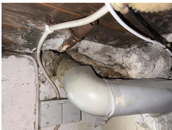
Kuva 7. Asbestimassajäämiä teknisessä tilassa.
