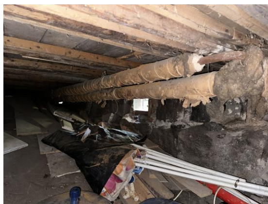
Kuva 8. Asbestipitoisia putkieristeitä alapohjatilassa.
