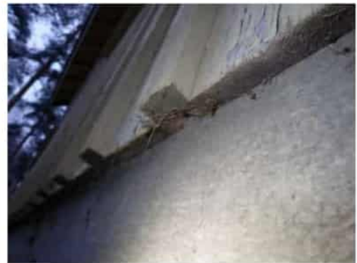
Kuva 18. Julkisivuverhoilun takana ei ole tuuletusrakoa.
