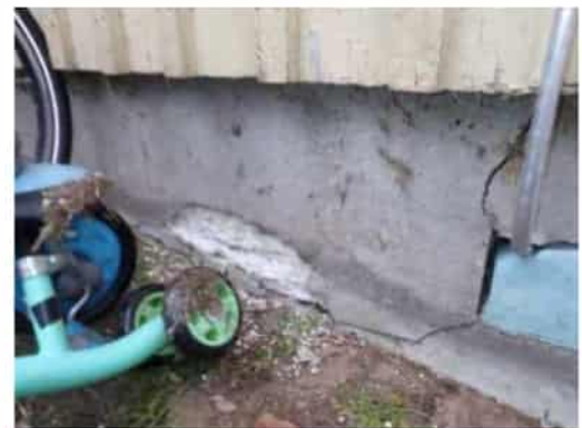
Kuva 4. Sokkelilevy paikoin rikkoutunut.
