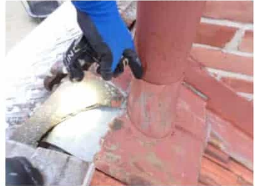
Kuva 25. Viemärin tuuletusputken ja peltisen kauluksen välissä rakoa.
