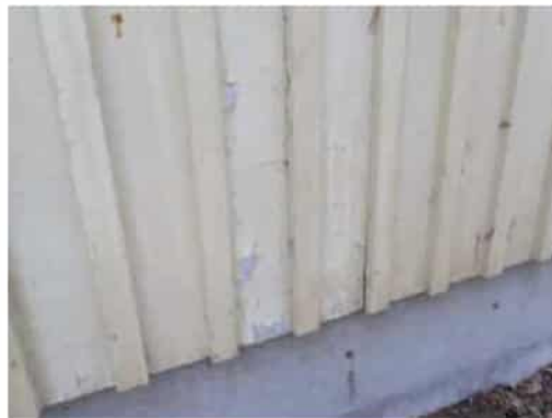
Kuva 17. Puuosissa huoltomaalauksen tarvetta.
