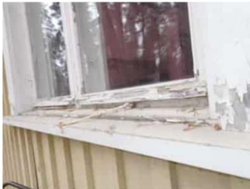
Kuva 22. Ikkunoiden maalipinnat hilseilevät.
