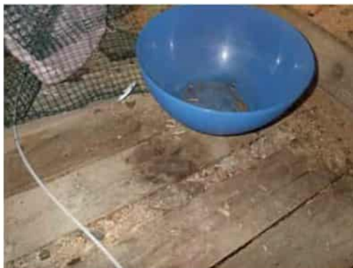
Kuva 11. Lahovaurioita sivu-ullakon lattiassa.
