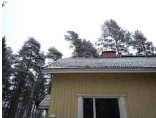
Kuva 30. Sadevesijärjestelmää ei ole asennettu.
