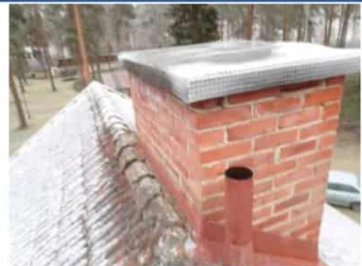
Kuva 35. Piippua ei ole pellitetty eikä sadehattua asennettu.
