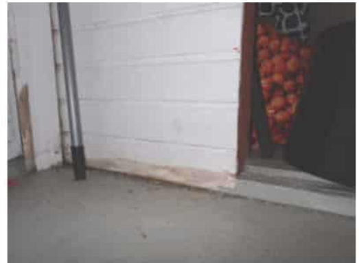
Kuva 55. Kellarin puurakenteissa kosteuden aiheuttamaa värimuutosta.
