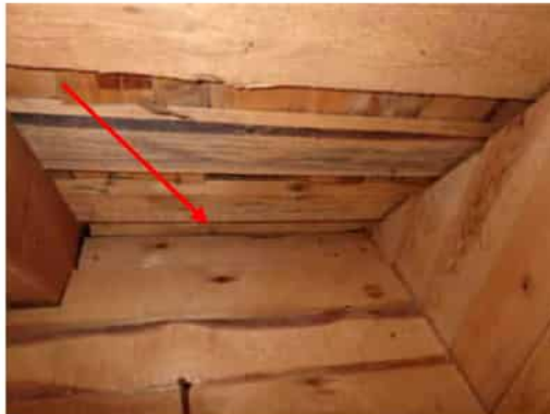
Kuva 13. Vinon sisäkaton tuuletus puutteellinen.
