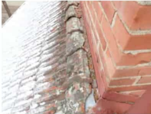
Kuva 26. Savupiipun läpivientikaulus ei ole tiivis.
