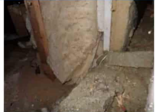
Kuva 6. Putkien villaeristeet kiinni maaperässä.
