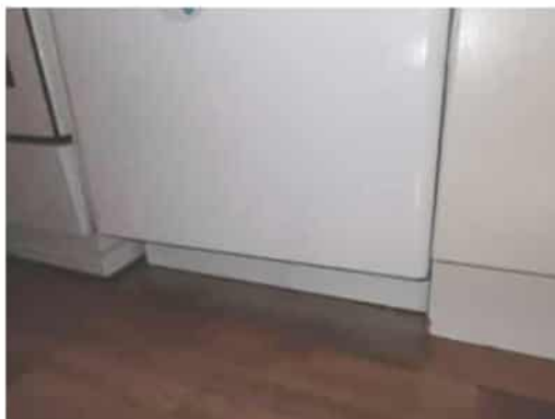
Kuva 53. Astianpesukoneen alla vuotokaukalo.
