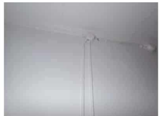
Kuva 41. Osittain alkuperäisiä sähköasennuksia jäljellä.
