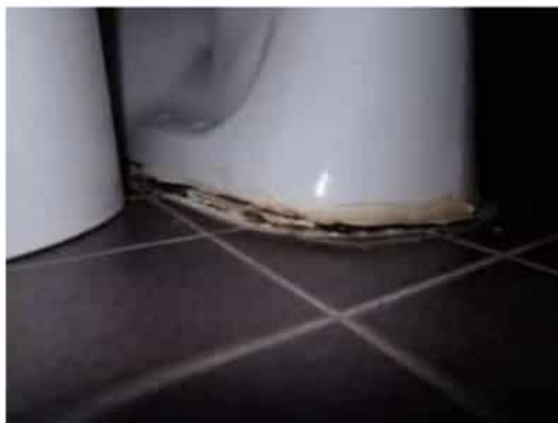
Kuva 48. Wc-istuimen kiinnitys puutteellinen.
