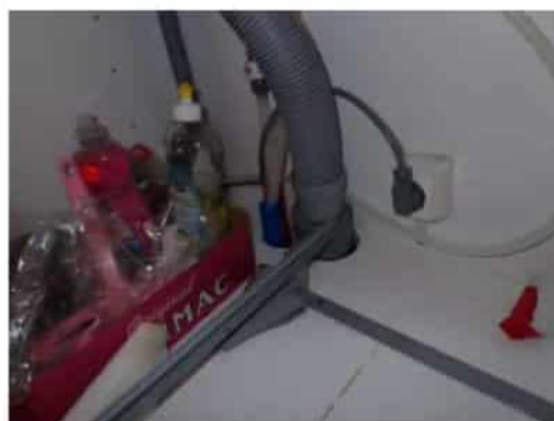
Kuva 52. Keittiön allaskaapin pohjalevyä ei ole tiivistetty.
