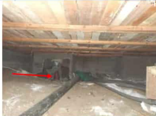
Kuva 4. Viemäriputki osin eristämättä ryömintätilassa.
