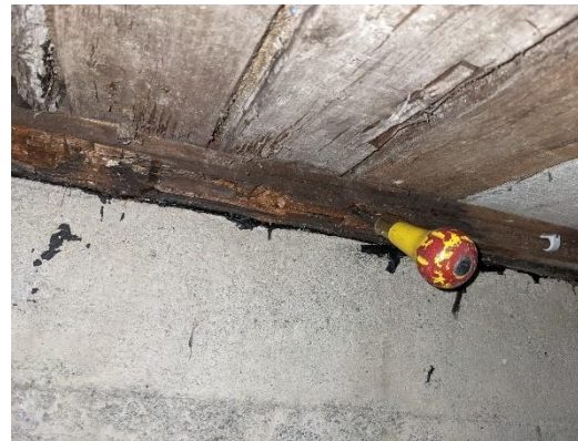
Ulkoseinän alajuoksussa lahoa
