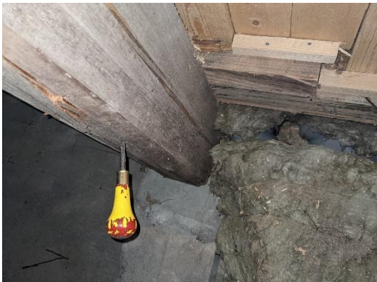
Rossipohjan kantavassa primääripalkissa lahoa
