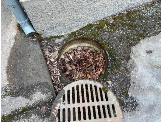
Hulevesikaivo täynnä roskaa, syöksy johtaa vedet kaivon viereen
