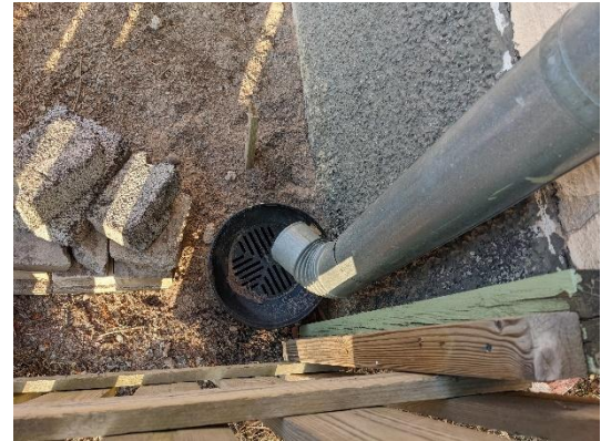
Sisäpihan puolella on muoviset sadevesikaivot
