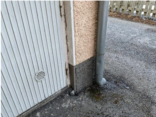
Vanhan autotallin kohdalla sadevedet johdetaan osin asfaltille
