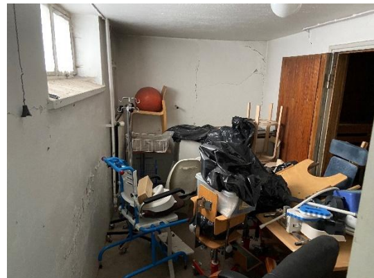
Pesuhuone 009 on varastokäytössä. Seinässä vanhoja kosteuden aiheuttamia pintavaurioita
