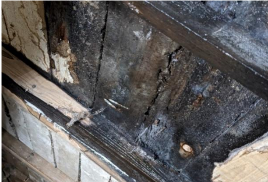
Aluslaudoituksen kosteusvaurioita vuotavan vie- märin kohdalla
