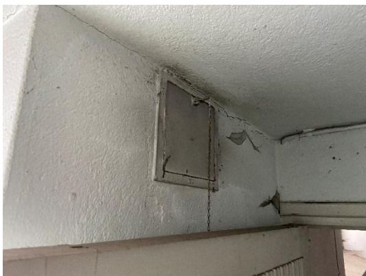
Tuuletusventtiili kellarin ulkoseinässä
