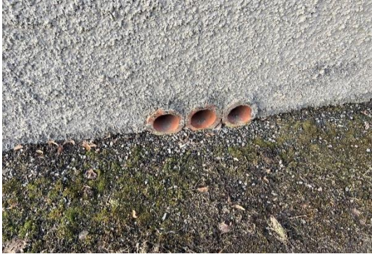
Ryömintätilan vanhat tuuletusputket kadun pu- lella.
