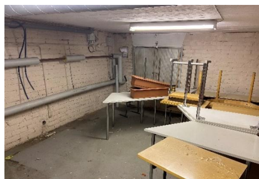
Vanha halkovarasto 012, jossa on myöhemmin ollut öljysäiliötila. Tilassa on öljymäinen haju.
