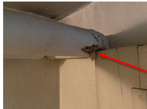
Kuva 6. Rikkoutunut putkieriste pukuhuoneen edustalla
