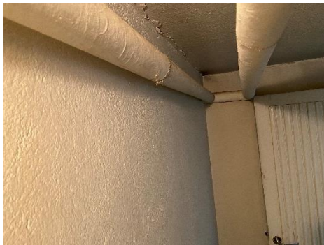
Kuva 5. Asbestipitoinen putkieriste kellarikerroksessa
