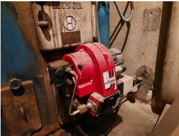
Kuva 13. (vas.) Lämmönjakohuoneen vanha öljypoltin
