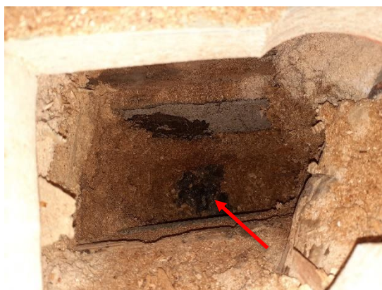
Kuva 3. Välipohjassa sijaitseva bitumisively/eristepahvi kantavan betonilaatan päällä sisältää asbestia
