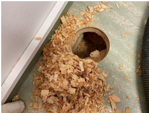
Kuva 2. Opetustila 115 lattiarakenteessa olevat liimajäämät sisältävät asbestia
