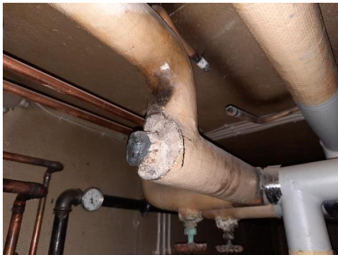
Kuva 7. Asbestimassaputki lämmönjakohuoneessa sisältää asbestia
