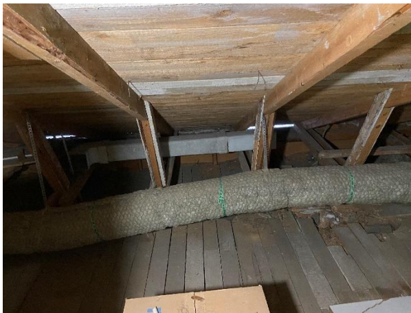
Kuva 15. Yläpohjan asbestisementtisen IV-kanavan pätkä
