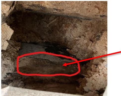
Kuva 4. Bitumikermi (purun alla) sisältää asbestia
