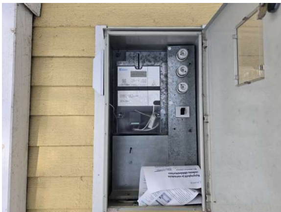
Sähkölaitteet ja pääsulakkeet laajennusosan terassilla.
