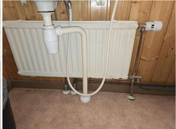
Altaan ja pattereiden putkistoja.
