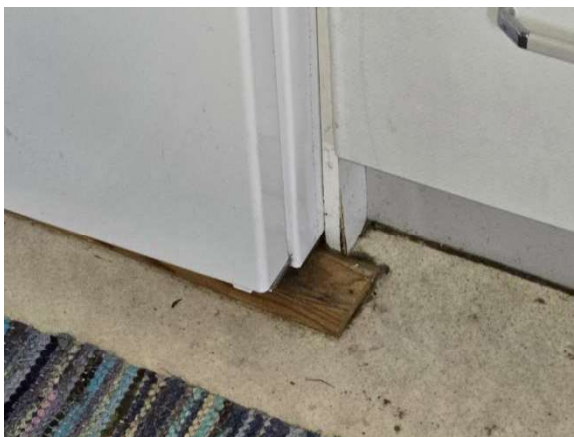
Jääkaapin kohdalla vähäisiä kosteusjälkiä.
