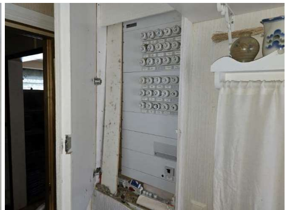
Sulaketaulu keittiössä. Taulun kohdalla oletettavasti hiirten tekemiä jälkiä. Puhallusvillaa varissut yläpohjatilasta.
