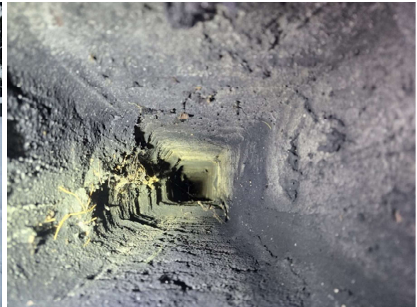
Piipussa on yhteensä 4 hormia, joista yksi on tulisijakäytössä.
