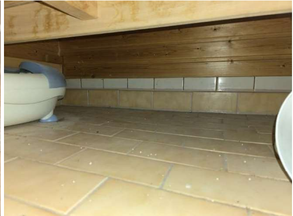
Kuva lauteiden alta. Laatoitus "kopisee".
