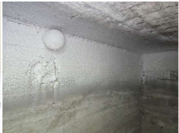
Kellarissa betonirakenteiden kastuminen muodosta kosteusvaurioriskin yläpuolisissa puurakenteissa ja lämmöneristyksissä.
