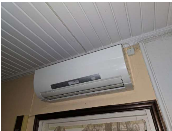
Ilmalämpöpumput juhlasalissa ja eteisessä.
