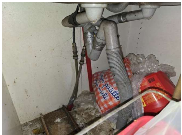
Allaskaapin putkistoja. Putket tulisi kannakoida.
