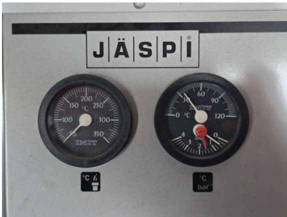
Paine oli matala. Kattilan lämpötila oli hieman yli 30 astetta.
