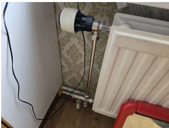
Alakerran etupihan makuuhuoneen patteri.
