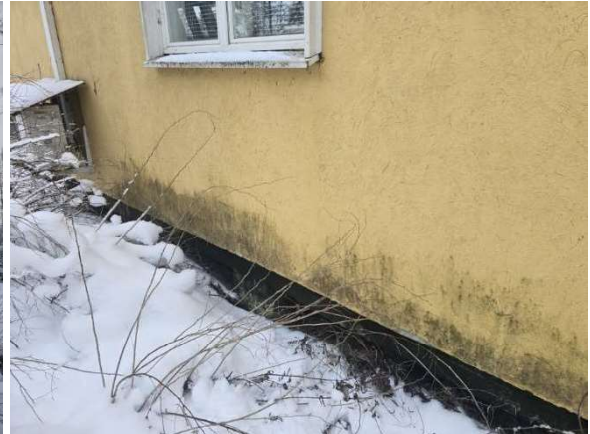
Seinän alaosassa kastumiseen viittaavia jälkiä.
