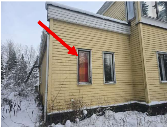
Etupihan makuuhuoneen ikkuna on rikki.
