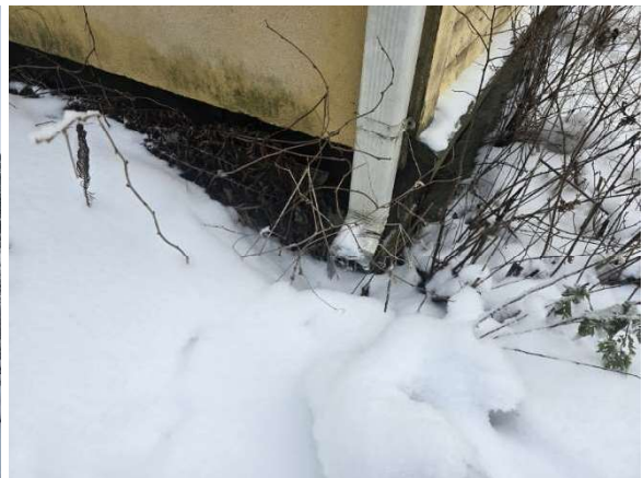
Kattosadevedet valuvat perustusten vierelle.
