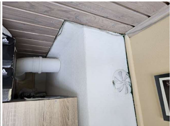
Vanhan osan piipussa on ilmahormeja. Kuva yläkerran makuuhuoneesta.
