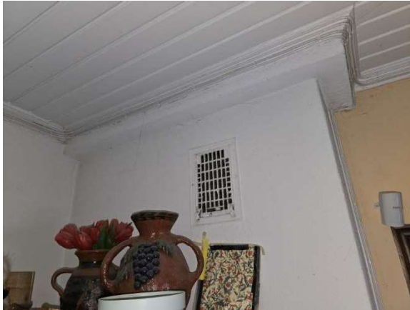
Alakerran eteistilassa poistoventtiili ilmahormiin.
