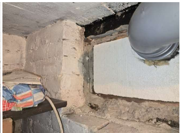
Kellarin seinissä on ns. rivinteerausmuuraus, jonka takana havaintojen perusteella on ilmarako.
