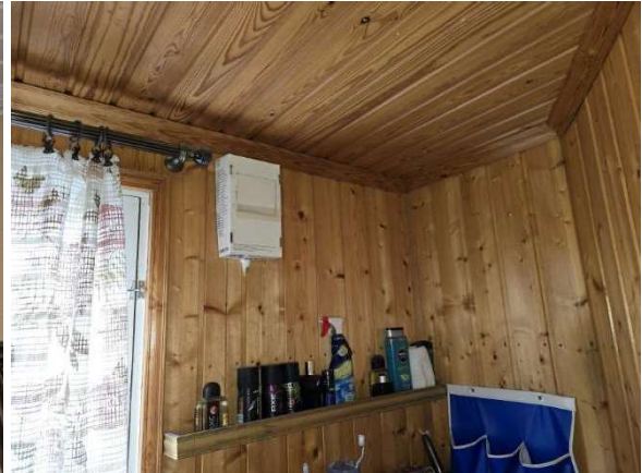
Yläkerran wc:ssä kanavapuhallin ulkoseinässä.
