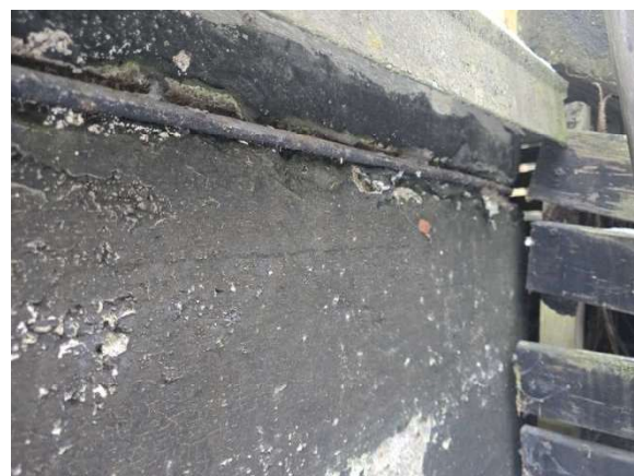
Kuva etupihalta olohuoneen ikkunan alta. Betoniterästys näkyvissä.
