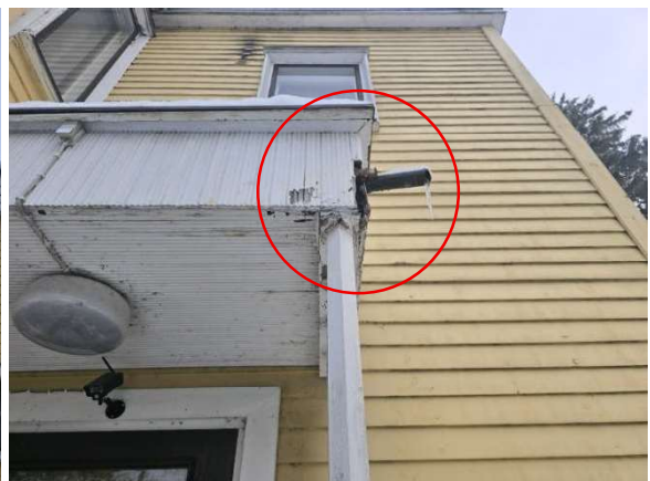
Sisäänkäynnin kohdalla katoksen kulma kastunut.
