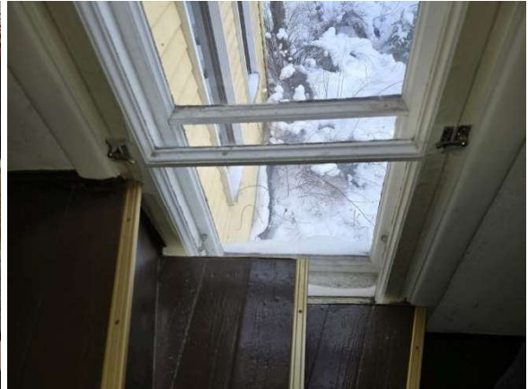
Yläkerrran ikkuna on remontin yhteydessä suositeltavaa vaihtaa turvalasilliseen ikkunaan.
