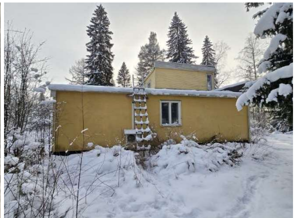
Vanhan osan ulkoverhouksen taustassa ei ole tuuletusta. Yläkerran huonetilojen kohdalla on tasakatto.
