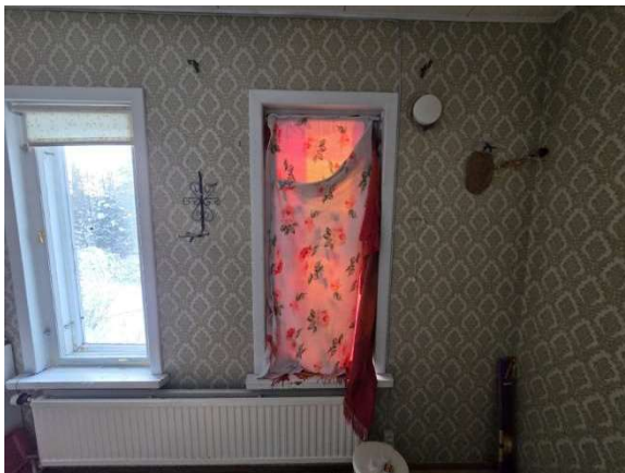
Yksi raitisilmaventtiili vanhalla puolella etupihan makuuhuoneesta.
