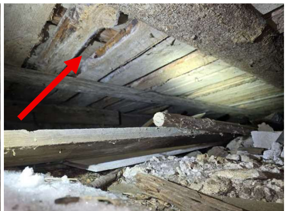
Rossitilan pohjalaudoituksen yläpuolella ontto kohta.
