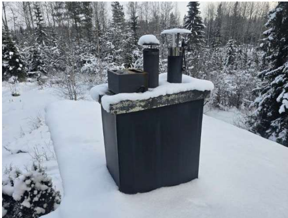
Poistopuhallin laajennusosan piipussa.
