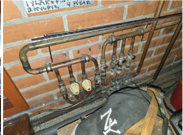
Lämmityksen jakotukki kattilahuoneessa.
