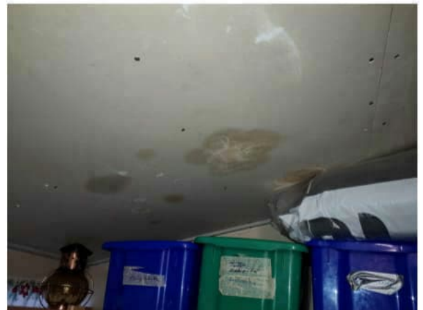
18. Mahdollisesti kosteuden aiheuttamia jälkiä ulkovarastossa
