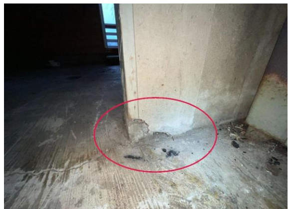
Kuva 35. Kuvassa osoitettu löylyhuoneen vaurioitunut kuitusementtilevy, joka saattaa sisältää asbestia.
