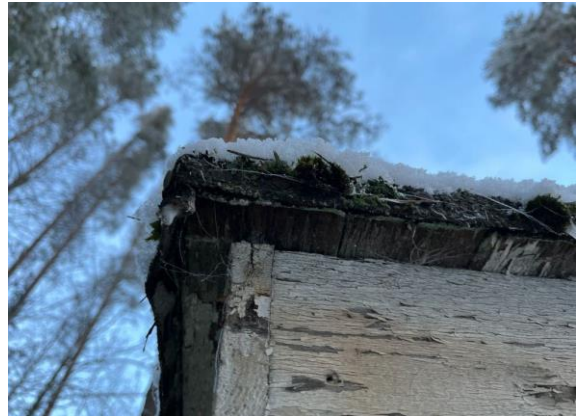
Kuva 24. Vesikate on kovettunut ja siinä on sammalkasvustoa
