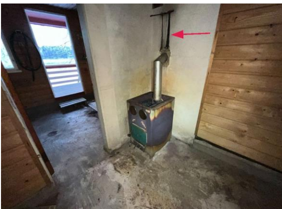
Kuva 34. Löylyhuoneen kiuas on heikkokuntoinen. Kuvassa osoitettu savupiipun vesivalumat.
