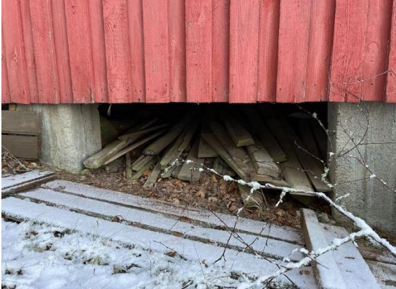
Kuva 8. Alapohjassa on varastoitu rakennustavaraa
