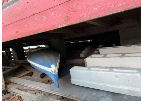
Kuva 11. Alapohjassa on varastoitu rakennustavaraa ja kanootti
