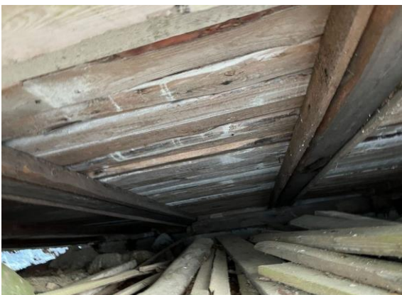
Kuva 12. Alapohjan puurakenteissa on havaittavissa värimuutoksia
