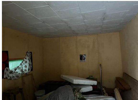
Kuva 28. Ulkorakennuksen sisätilat ovat huonossa kunnossa. Seinillä ja katossa on mahdollisesti vesivalumien aiheuttamia jälkiä ja tummentumia.
