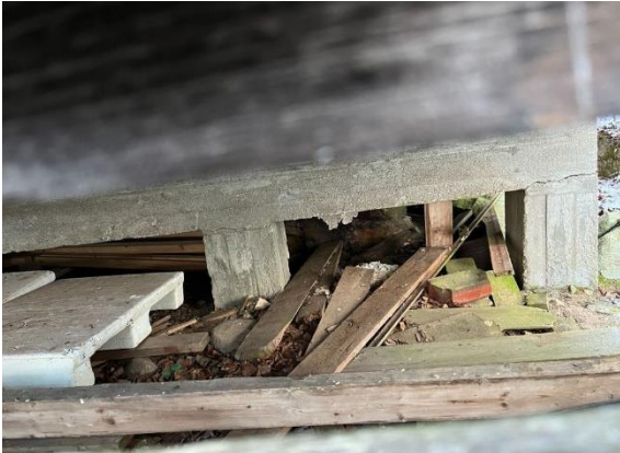
Kuva 10. Alapohjassa on varastoitu rakennustavaraa
