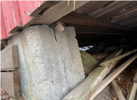
Kuva 5. Betonin pinnassa havaittavissa rapaumaa
