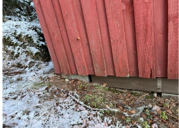
Kuva 9. Alapohjan tuuletus on estetty levytyksellä
