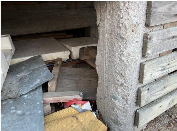
Kuva 7. Betonin pinnassa havaittavissa rapaumaa
