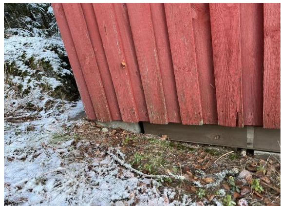
Kuva 14. Osa laudoista on lahonnut ja maalipinta hilseilee
