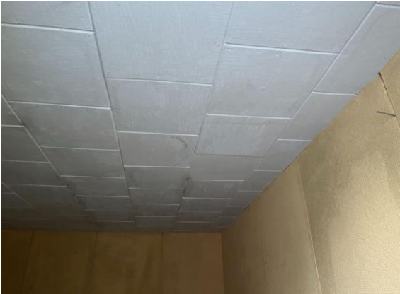
Kuva 29. Ulkorakennuksen sisätilat ovat huonossa kunnossa. Seinillä ja katossa on mahdollisesti vesivalumien aiheuttamia jälkiä ja tummentumia.
