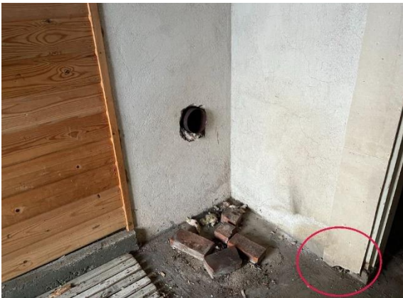
Kuva 32. Pukuhuoneen tulisija on poistettu. Kuvassa osoitettu vaurioitunut kuitusementtilevy, joka saattaa sisältää asbestia.
