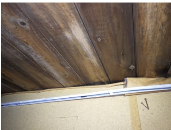
21. Vinon yläpohjan tuuletus ummessa sivu-ullakolla
