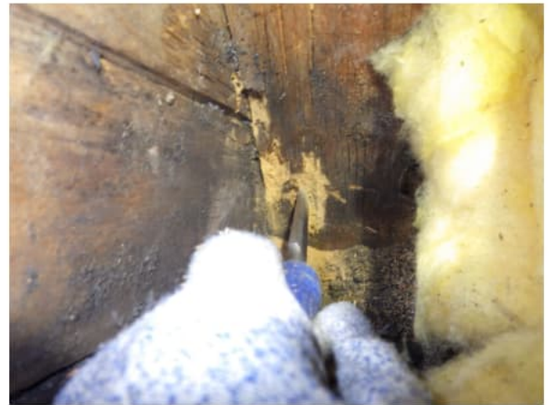
14. Vauriota ulkoseinässä sivu-ullakon kohdalla
