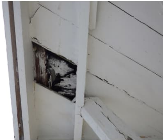
13. Pihasisun ovikatoksessa vauriota
