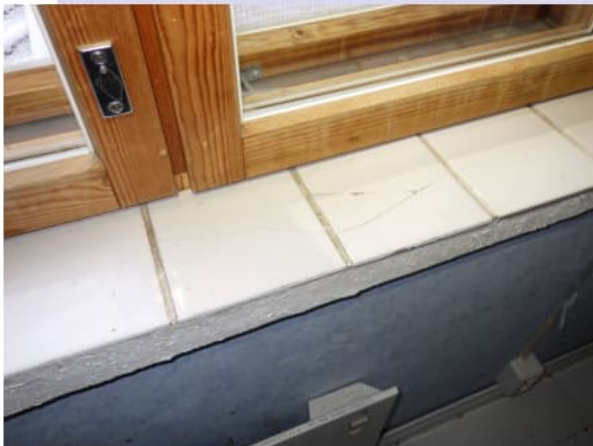
31. Ikkunapenkkin laatoituksissa vaurioita
