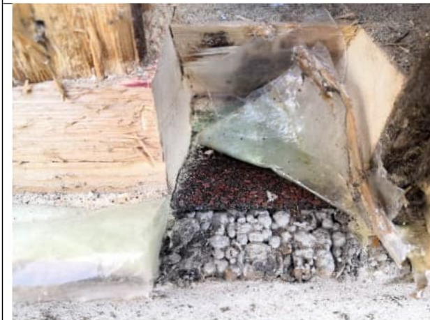
Kuva 23 - Alaohjauspuun alla olevaa muovitettua villakaistaa [US5]
