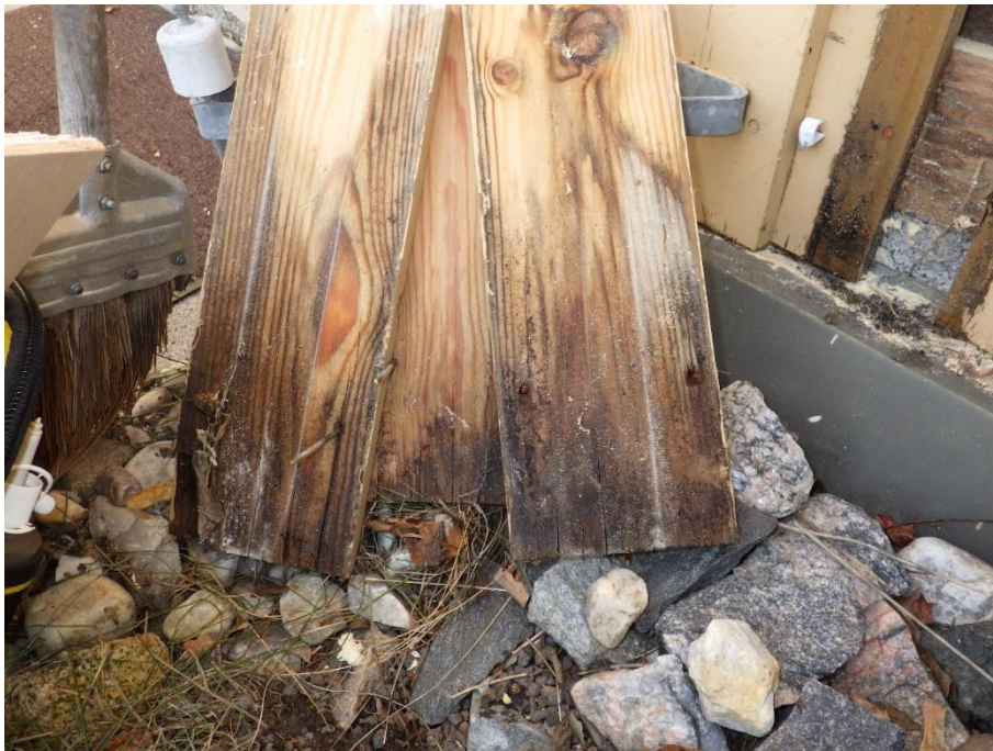
Kuva 4 – Aistinvaraisesti todettuja vaurioita julkisivulaudoituksen taustalla [US7]
