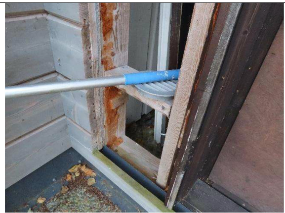
Kylmävaraston kohdalla avoin ikkuna-aukko
