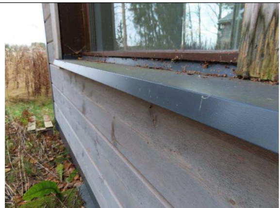
Ikkuna pellitykset kaataa osittain sisään päin
