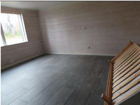
Lattialaatoituksen alusta paikoin epätasainen
