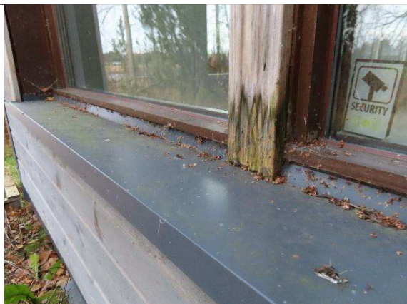
Osa smyggilautoista vaurioitunut
