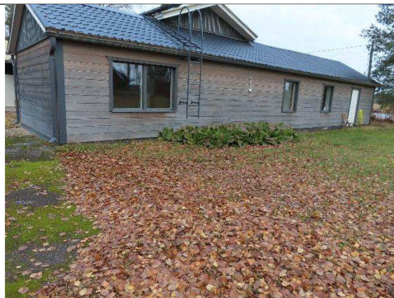
Maanpinta kaataa paikoin rakennukseen päin
