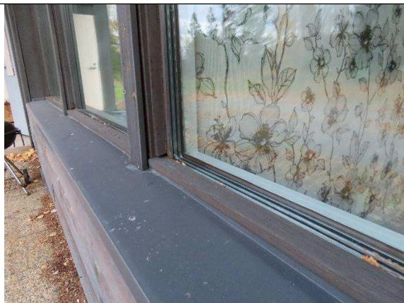
Ikkuna pellitykset kaataa osittain sisään päin
