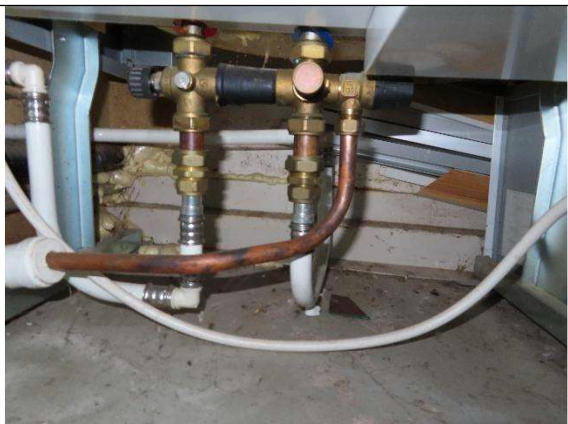
Varastossa olevan lämminvesivaraajan alustaa
