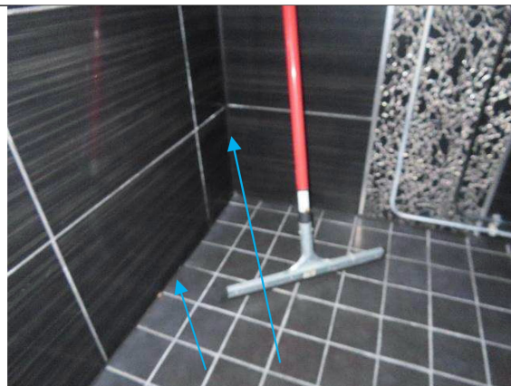
Laatoitusten nurkka- ja kulmasaumamat paikoin auki
