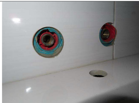
Pesuhuoneesta pesualtaan hana poistettu
