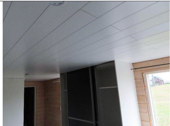
Sisäkatot ”roikkuu” paikoin
