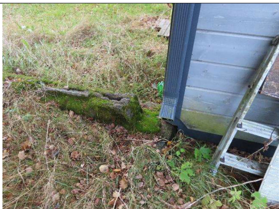
Rännivedet laskevat maahan perustusten vierelle
