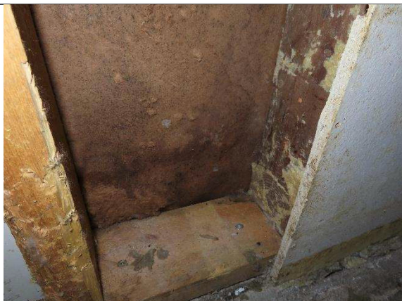
Varaston ulkoseinällä tuulensuojalevy selvästi vaurioitunut
