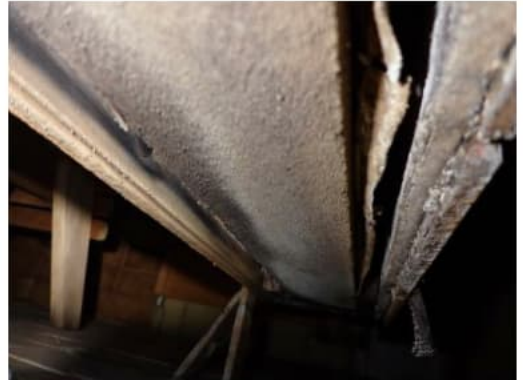
Kuva 32. Saunan ja pesuhuoneen välisessä seinässä kosteusvaurio.
