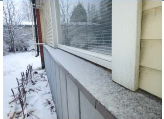
Kuva 21. Ikkunan vesipeltien kallistus puutteellinen.
