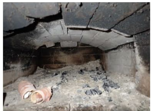
Kuva 26. Uunin tulipesä. Tiiliä paikoin irronnut.
