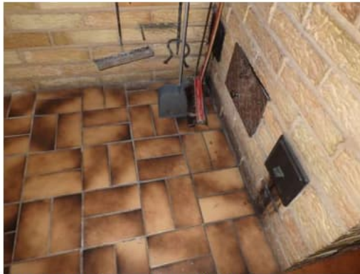
Kuva 30. Tulisijan edustalla kipinäsuojaus.
