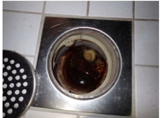
Kuva 34. Pienemmän pesuhuoneen lattiakaivo.
