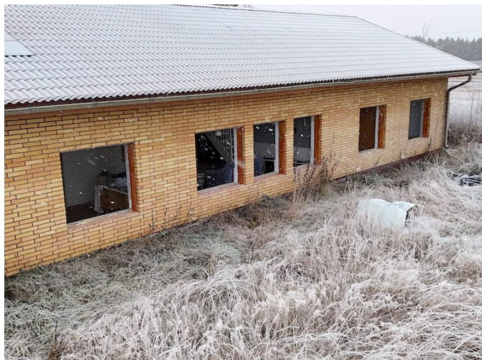
Kuva 8. Ikkunat puuttuvat pääosin
