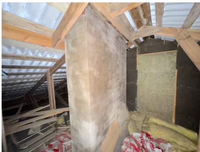
Kuva 7. Savupiippujen läpivienneissä havaittiin epätiiveyttä.
