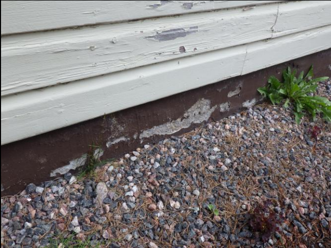
Kuva 3 Sokkelissa pinnoite vauriota
