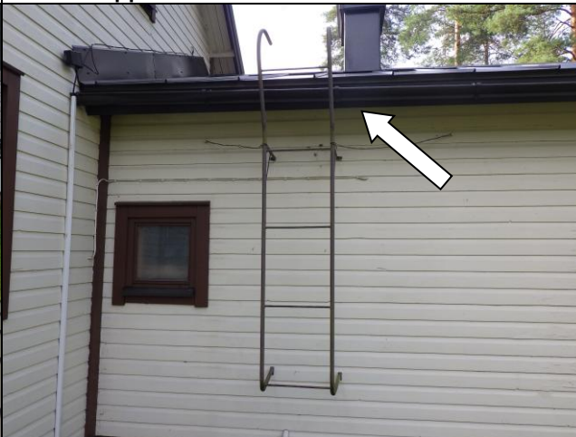
Kuva 11 Alemman katon nousutikkaat puutteelliset
