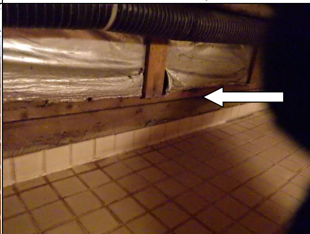
Kuva 17 Saunan seinien alaosan puutteellinen
