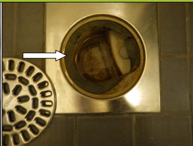
Kuva 19 Lattiakaivosta puuttuu kiristysrenkas
