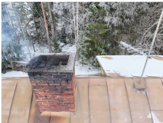
Kuva 5. Savupiipun kylmässä osassa havaittiin pakkasrapautumaa.
