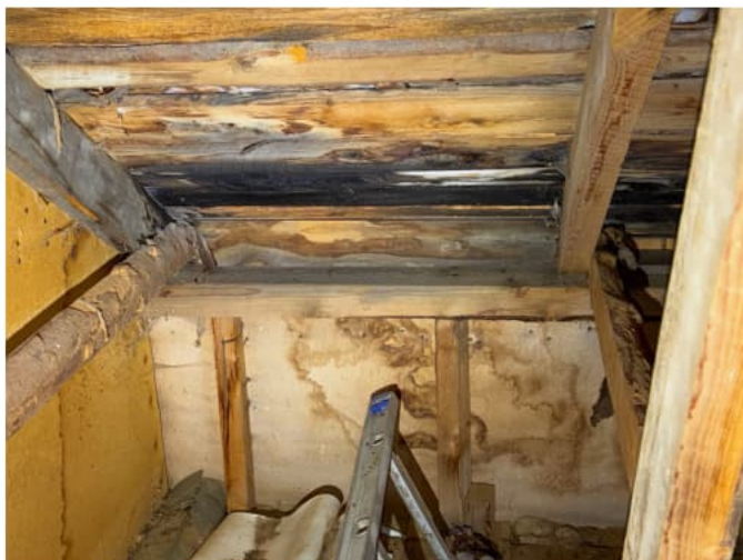
Kuva 7. Jalkarännien kohdalla havaittiin kosteusjälkiä
