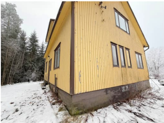
Kuva 8. Pystypaneeliverhoukset, ikkunat ja ovet, ovat heikossa tai tyydyttävässä kunnossa
