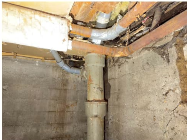
Kuva 15. Putkistot ovat pääosin alkuperäisiä
