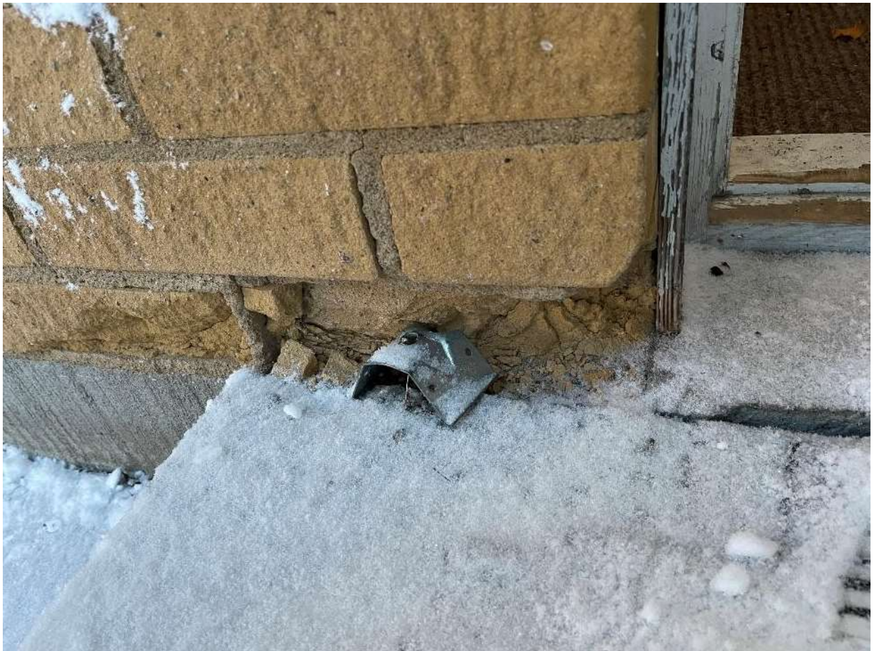
Kuva 6. Vauriot sisäänkäynnin porrastason edustalla.
