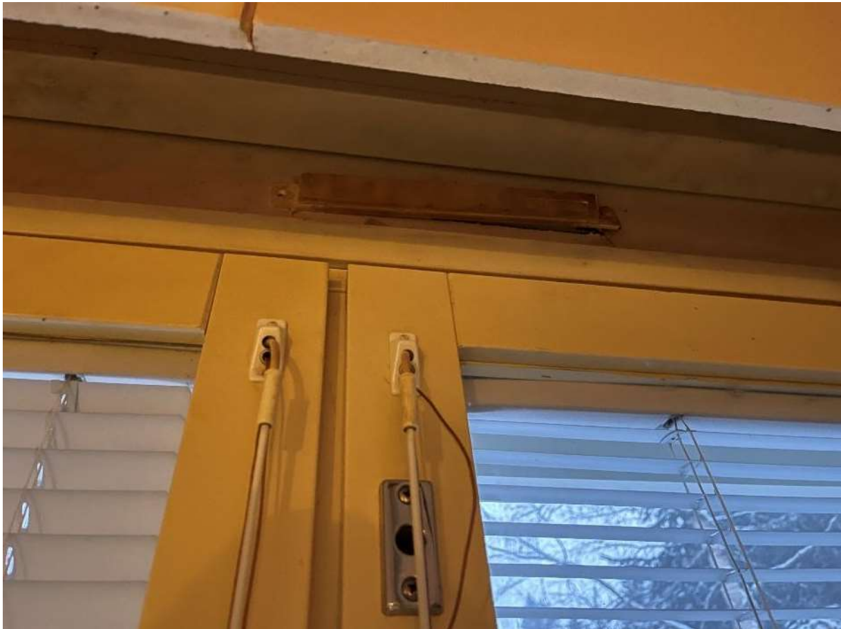
Kuva 42. Asuinhuoneiston korvausilmaventtiili ikkunan yläpuolella.
