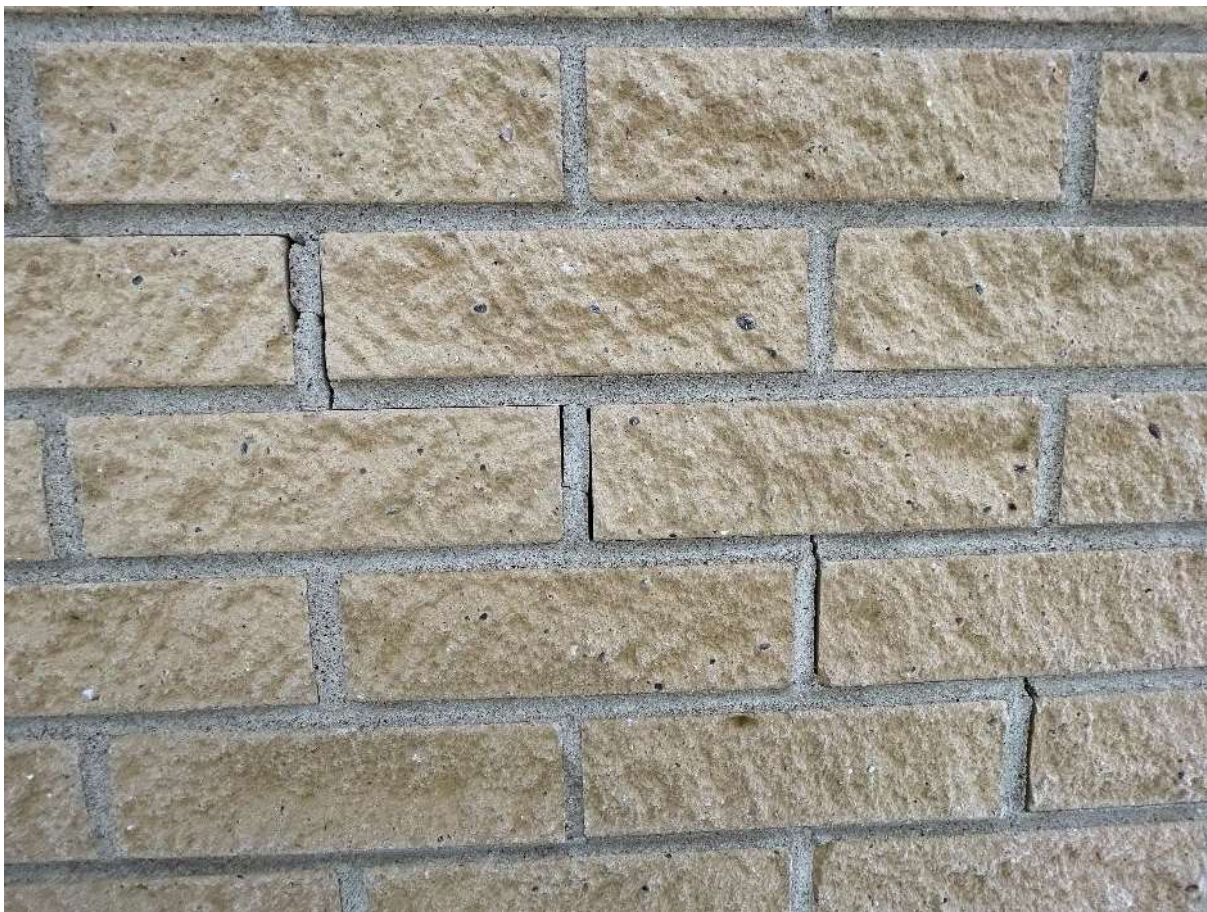
Kuva 14. Tiiliverhouksien saumojen halkeamat päädyssä.
