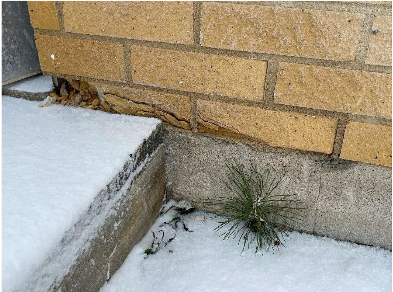
Kuva 5. Vauriot sisäänkäynnin porrastason edustalla.
