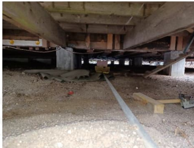
Ryömintätilainen alapohja, sähköjohtoja roikkuu
