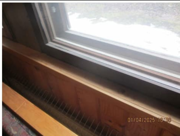
Ikkuna 3-lasinen puuikkuna, ulkopuolen listoitus paikoin irti
