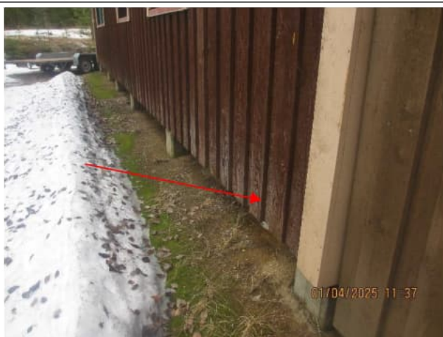
Seinien alaosat kastuneet roiskevesistä, pintakäsittely vaatii huoltoa
