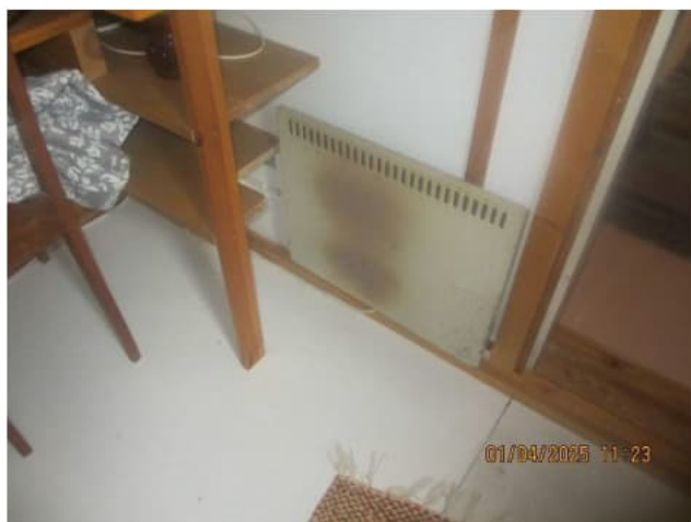
Sähköpatterin tekninen käyttöikä on loppu
