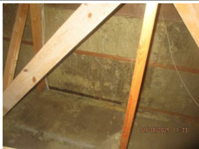
Yläpohjan villaeristeissä viitteitä kosteudesta
