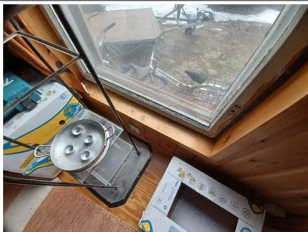
Ikkuna 2-lasinen, maalipinta huonokuntoinen pintakäsittelyltään
