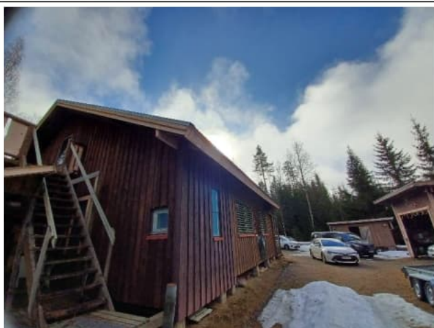
Sadevesiä ei ole ohjattu sadevesikourut puuttuu
