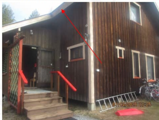
Sisäänkäynnin yläpuolelta puuttuu sadevesikourut ja lumiesteet
