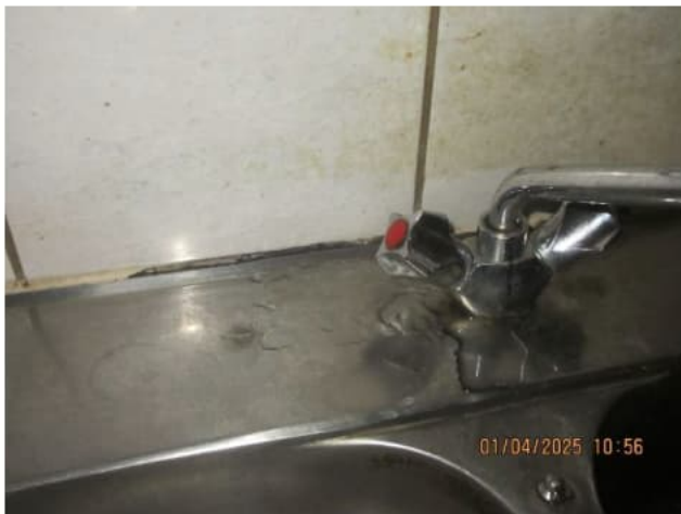
Silikonit puuttuu paikoin
