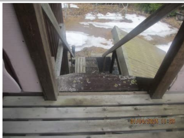
Kaiteiden turvallisuustaso ei ole vaadittavalla tasolla
