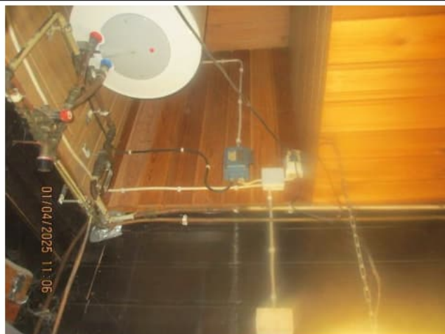
Lämminvesivaraaja pesuhuoneessa on rikki
