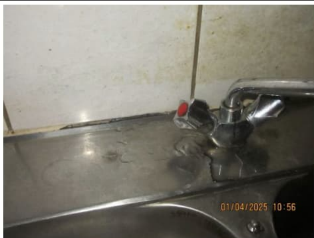
Keittiön ikääntynyt vesihana vuotaa tiskipöydälle
