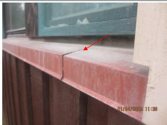
Ikkunapelti ei ole tiivis
