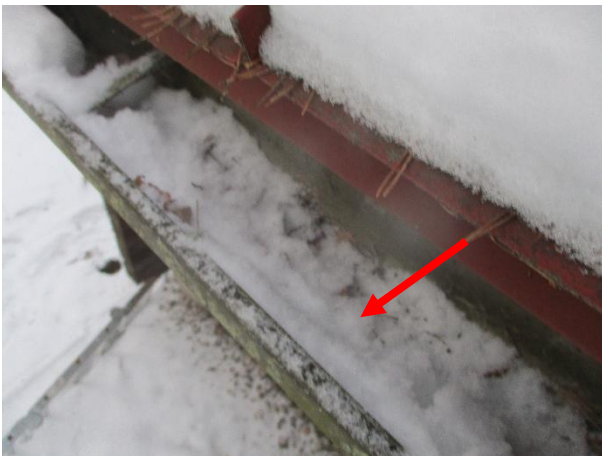
Tarkastushetkellä räystäskourut olivat tukossa.
