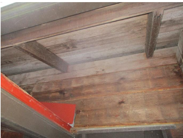
Rakennuksen yläpohja tuuletuu räystäärakenteiden kautta.
