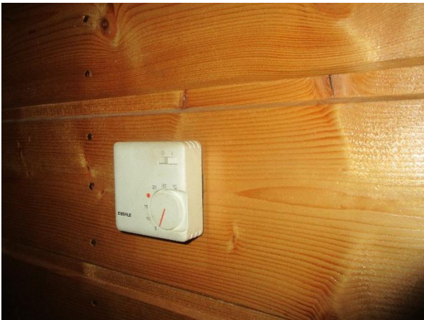
Yläkerran tiloissa on saatujen tietojen mukaan kattolämmitys (kuvassa säädin).
