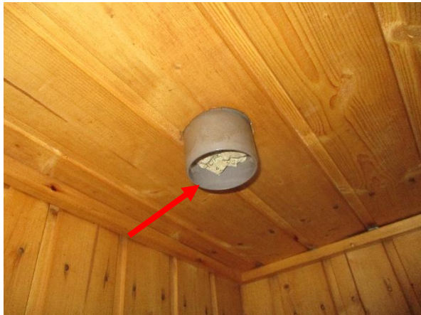
Märkätilojen, wc-tilojen ja vaatehuoneen ilmanvaihto oli osittain puutteellinen tai kanavia oli tukittu.
