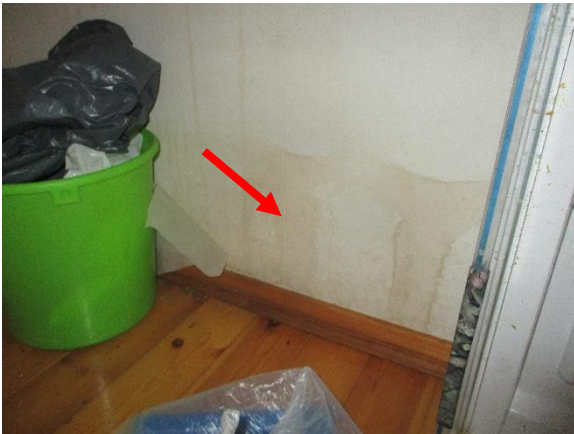
Seinässä oli havaittavissa vanhoja valumajälkiä.
