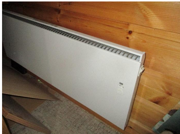
Esimerkkikuva alakerran sähköpatterista.
