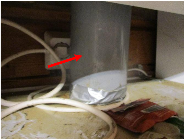
Liesituulettimen poistoputken materiaali ei täytä palomääräyksiä.
