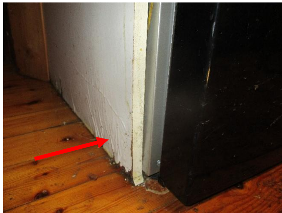
Kylmälaitteen kalusterungon alaosa oli vaurioitunut kosteudesta ja lattiassa kylmälaitteen ympärillä oli havaittavissa kosteuden aiheuttamia jälkiä / tummentumaa (vanha vaurio).
