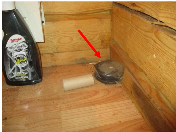
Yläkerran wc:n lattiassa oli tulpattu viemäriputki, joka on todennäköisesti viemärinuuletusputki.
