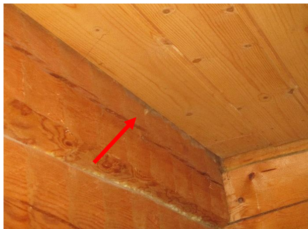
Yläpohjan höyrynsulku ei liity tiiviisti rakenteeseen.
