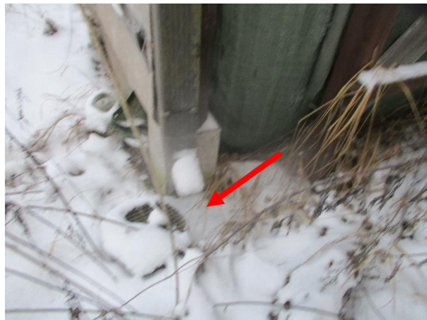
Rakennuksen parvekkeen kohdalla syöksytorvi ei osu sadevesikaivoon.
