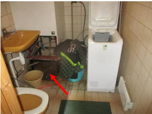
Lämminvesivaraaja on vuotanut lattialle kastellen alapohjarakennetta (lattialla oli vettä lämminvesivaraajan ympärillä).
