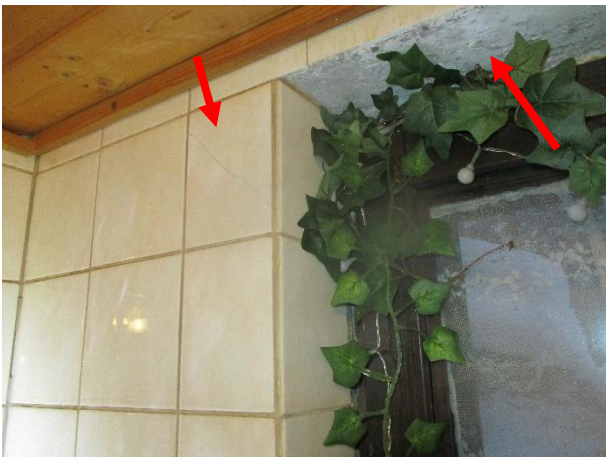
Pesuhuoneessa yksittäinen seinälaatta oli halki ja ikkuna-aukon yläosan pinnoitus on kesken.
