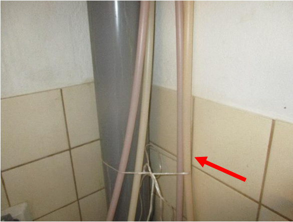
Alakerran wc-tilassa kulkevat käyttövesiputket olivat kiinnittämättä (korjattava kiinnitys).
