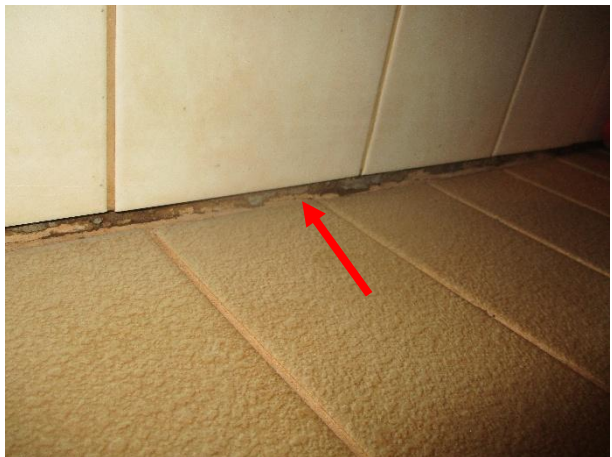
Pesuhuoneen lattian ja seinien rakenneliittymä on epätiivis.
